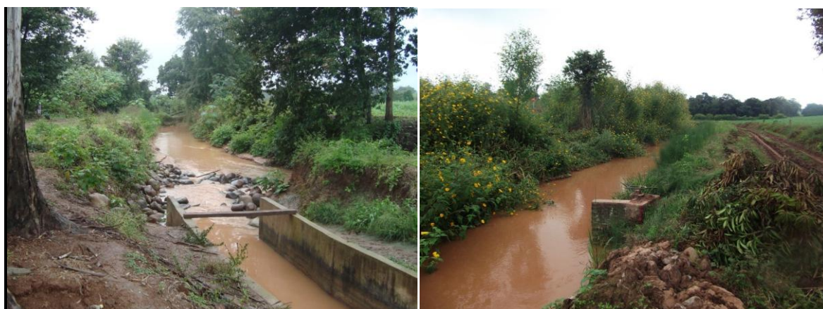
Figura N°8. Canal Matriz B, inicio tramo sin revestir. Situación actual.
