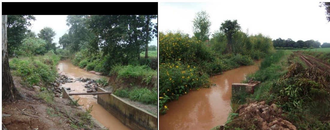
Figura N°4. Canal Matriz B, inicio tramo sin revestir. Situación actual.
