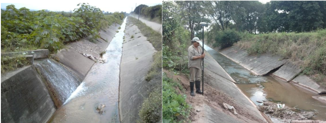
Figura N°22. Desagüe Ortiz. Situación actual.
