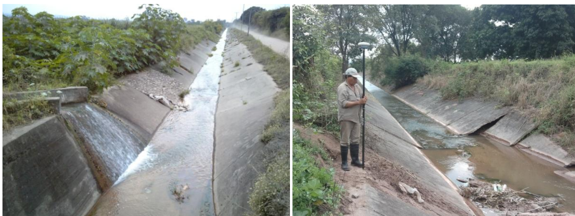
Figura N°26. Desagüe Ortiz. Situación actual.
