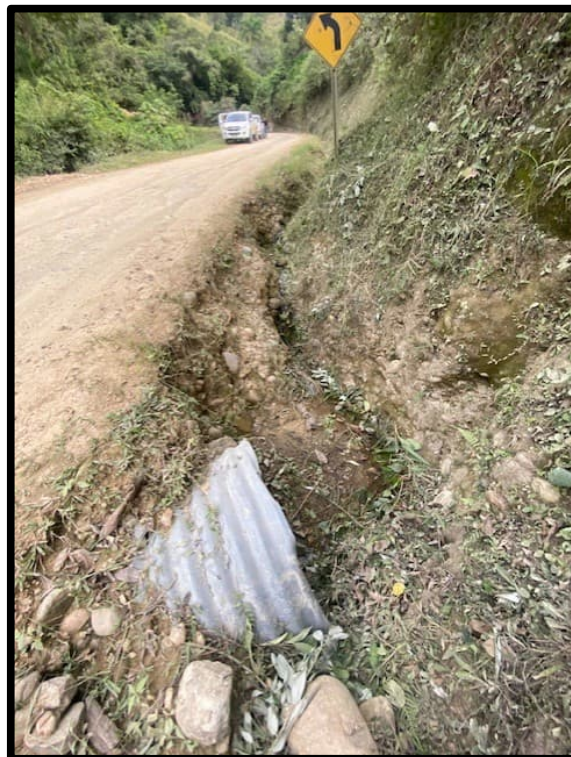
Figura 4.195. Alcantarilla T8 al margen de la vía en estado de deterioro, erosión en la zanja desnuda.
