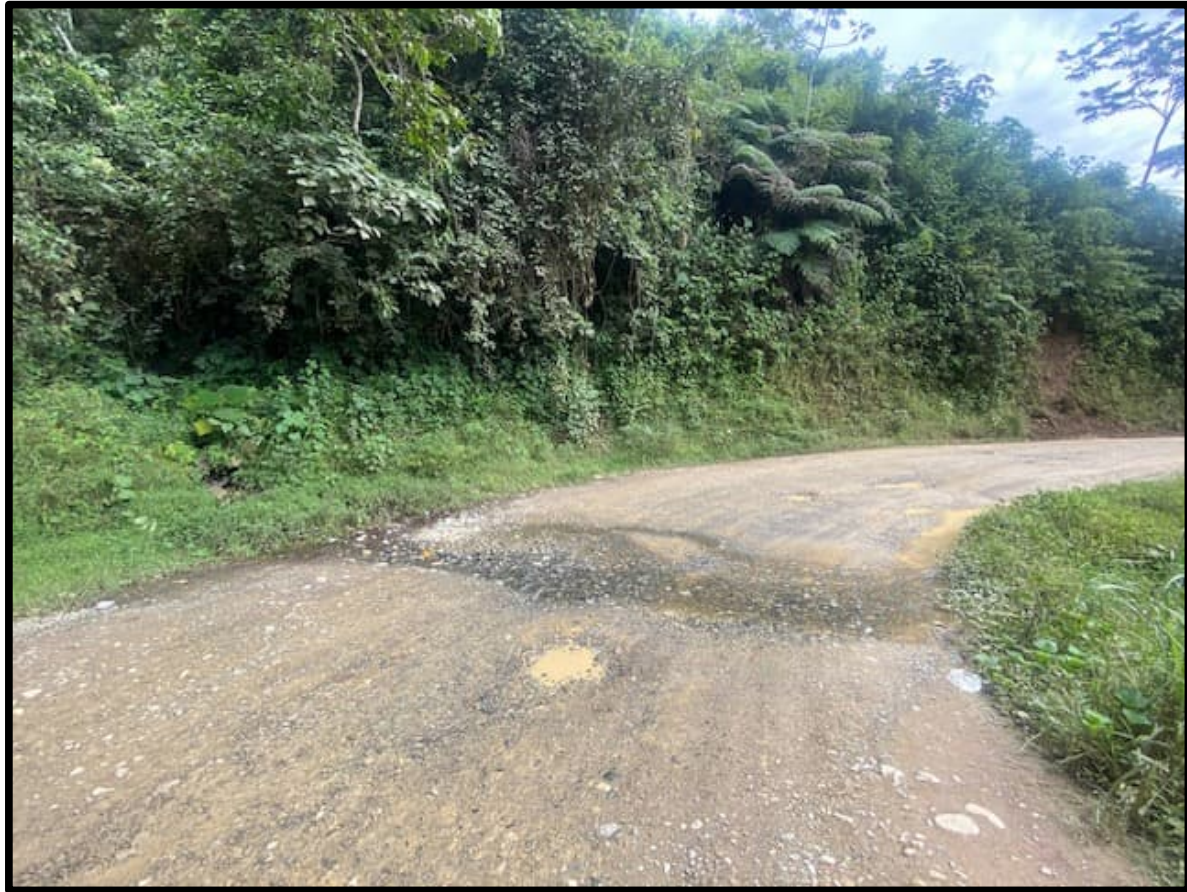
Figura 4.154. Daños en capa de rodadura por quebrada sin alcantarilla.
