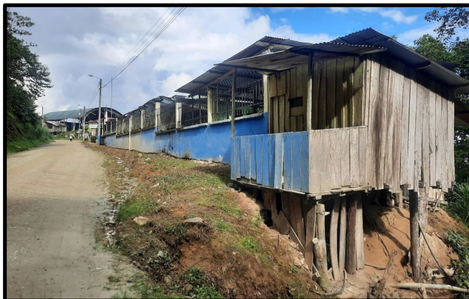
Figura 4.249. Vivienda inestable en Bellavista
