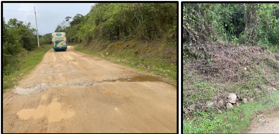
Figura 4.84. Quebrada sin alcantarillado y daños en capa de rodadura.
