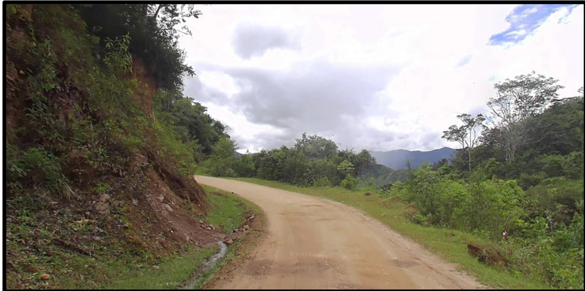
Figura 4.107. Inestabilidad del talud y desprendimiento de tierra.
