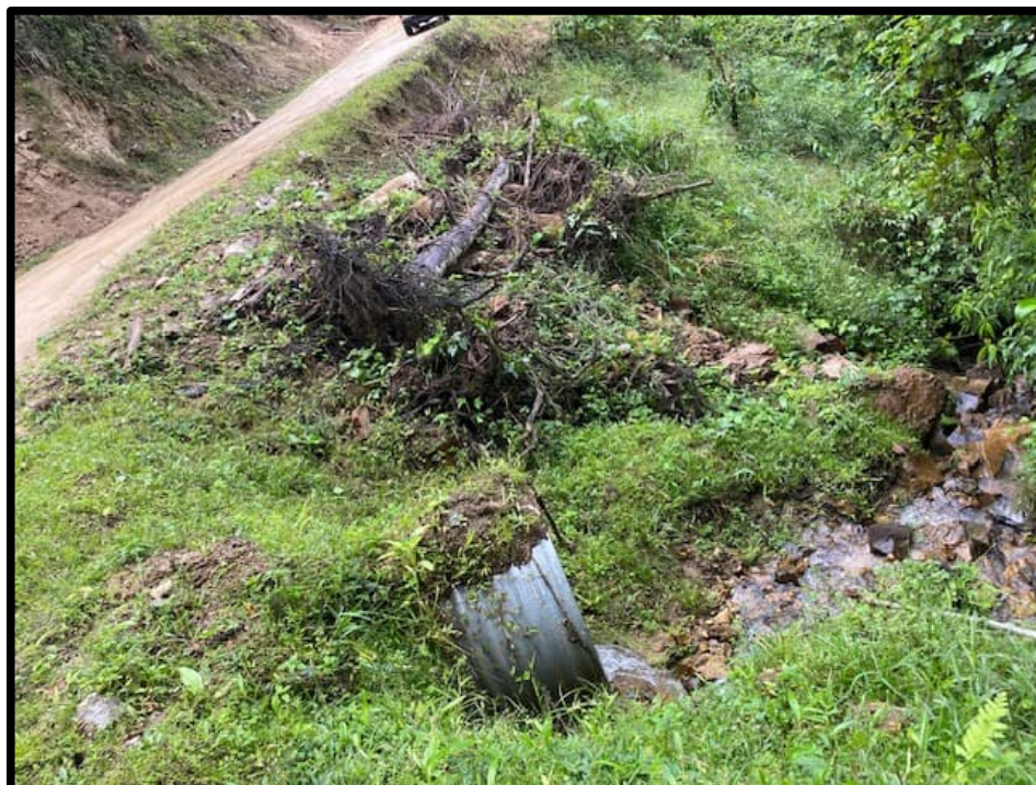
Figura 4.80. Alcantarilla T12 y restos de ramas y árboles.
