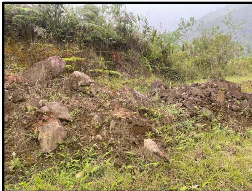
Figura 4.96. Bote Lateral y disposición de material desprendido al margen de la vía.
