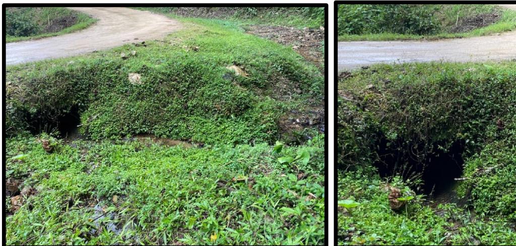
Figura 4.79. Zanja de captación y alcantarilla parcialmente bloqueada por vegetación.
