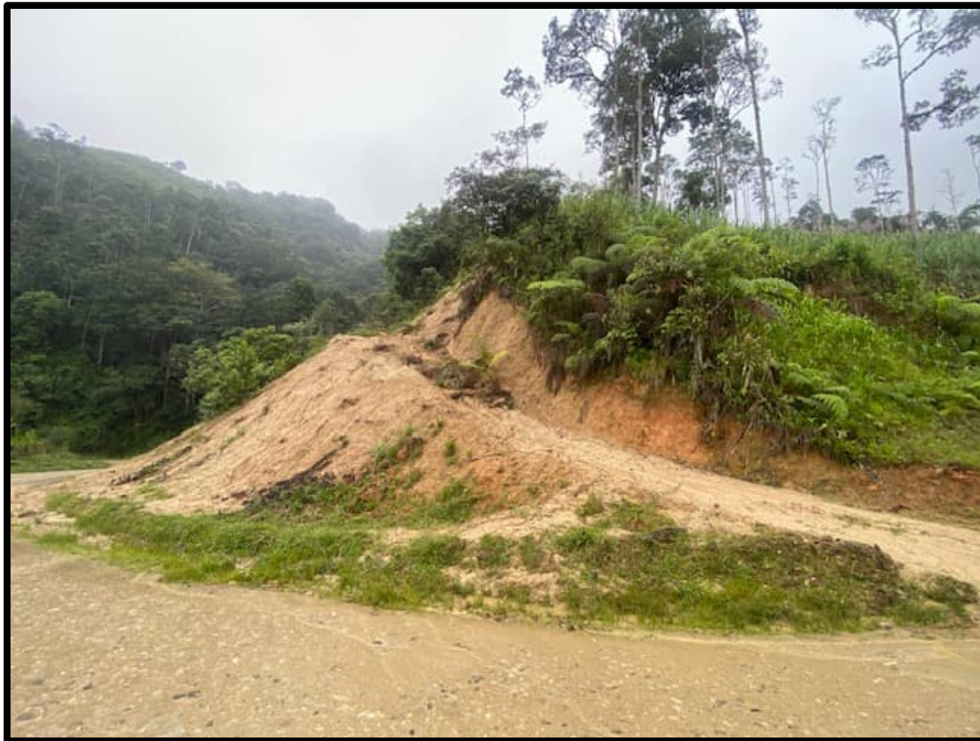
Figura 4.87. Vista de apertura de camino e inestabilidad de talud con deslizamiento de tierra en su base.
