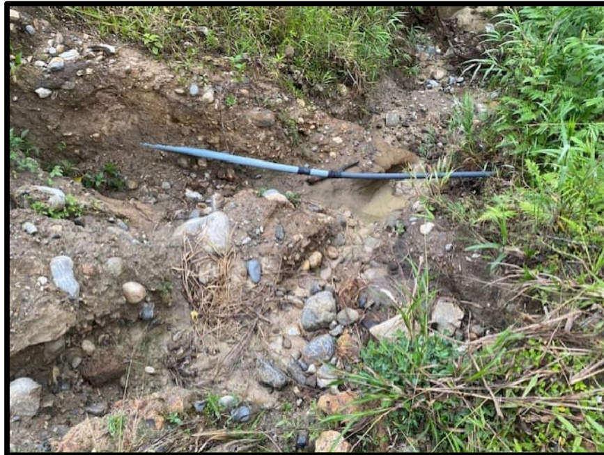
Figura 4.194. Conexiones de agua a la salida del alcantarillado.
