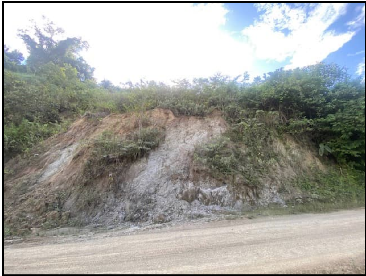
Figura 4.210. Ubicación talud inestable con deslizamiento de tierra.
