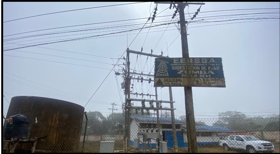
Figura 4.254. Subestación EERSSA en Zumba.
