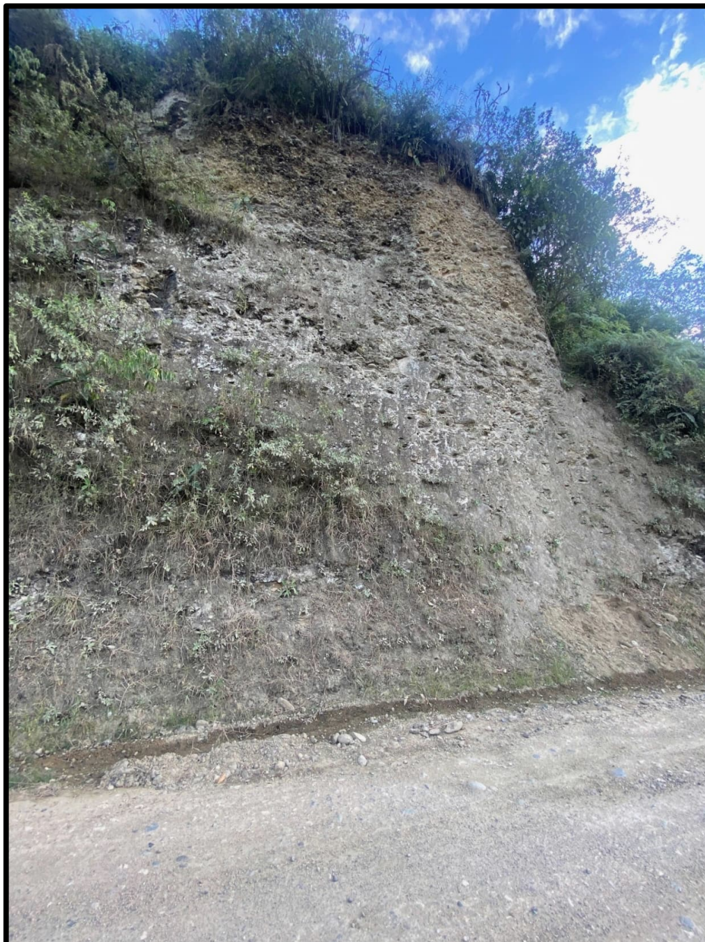
Figura 4.221. Conglomerados en taludes, caída de piedras en la base.
