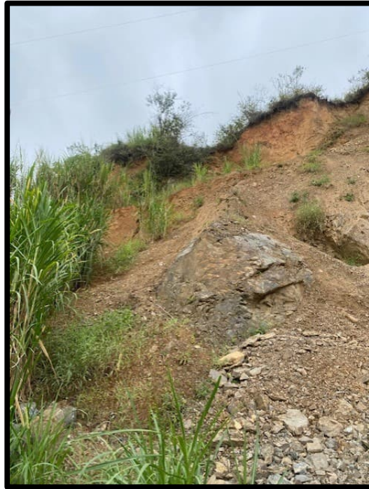
Figura 4.146. Inestabilidad del talud y deslizamiento de tierra.
