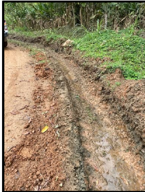
Figura 4.189. Zanja desnuda con signos de erosión.
