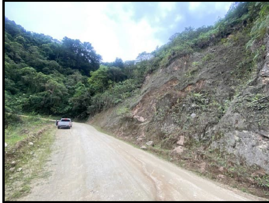
Figura 4.101. Derrumbe en Tramo Bellavista-Progreso.
