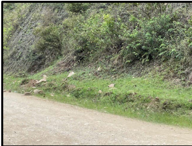
Figura 4.100. Desprendimiento de rocas del talud.
