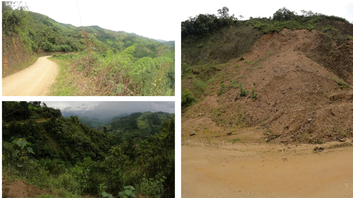
Figura 4.37. Taludes con evidencias de Erosión. Tramo 1 del Proyecto.
