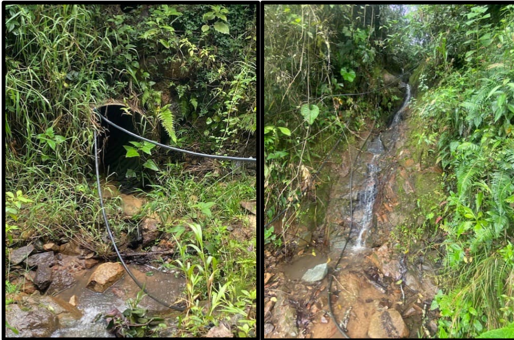
Figura 4.178. Alcantarilla T6 y conexiones de agua.
