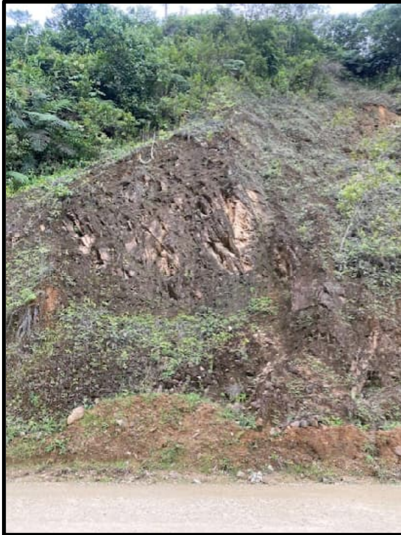
Figura 4.106. Deslizamiento de tierra con acumulación al pie del talud.
