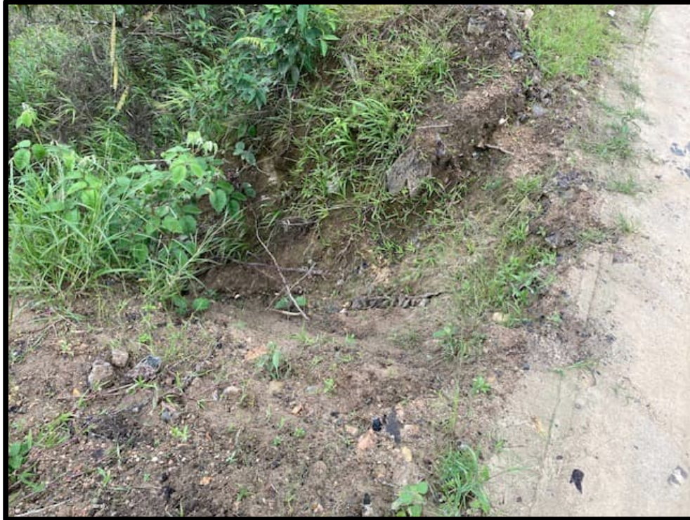
Figura 4.119. Bote lateral de material de deslizamiento y erosión en margen de ruta.
