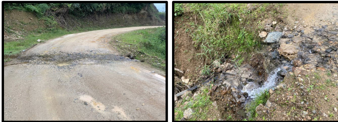
Figura 4.83. Deterioro en capa de rodadura y erosión en ladera.
