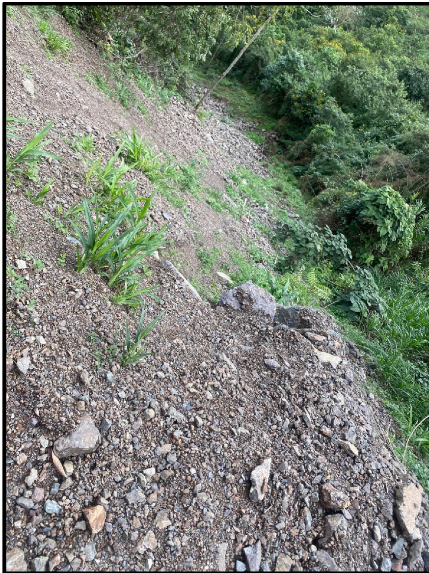
Figura 4.150. Bote lateral a ladera sobre el margen de la vía.
