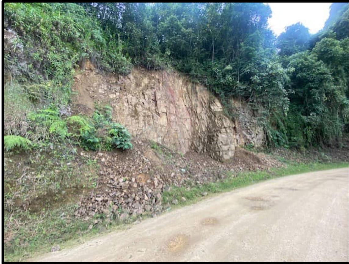
Figura 4.117. Talud inestable con deslizamiento de material.
