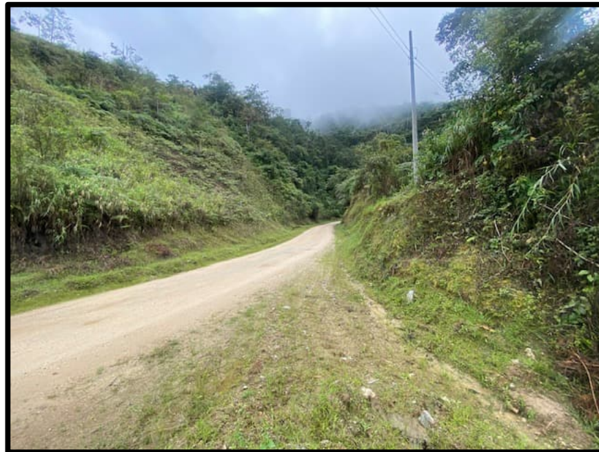
Figura 4.88. Vista del bote lateral sobre ruta.
