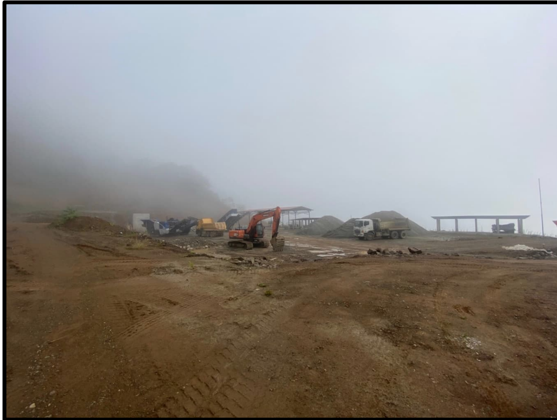
Figura 4.134. Planta de Asfalto Provincia Zamorra Chinchipe.
