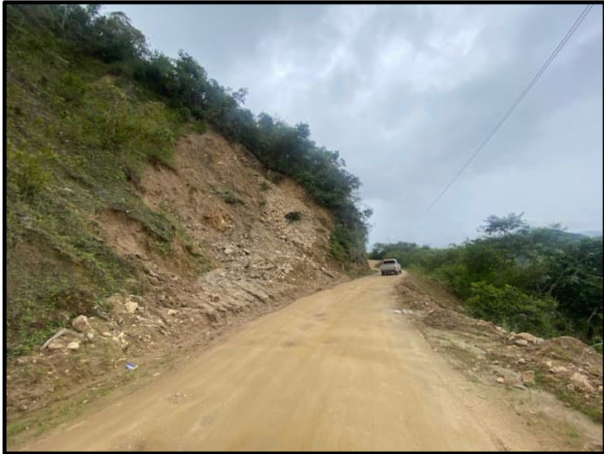
Figura 4.111. Deslizamiento de tierra y bote lateral a ladera de montaña.
