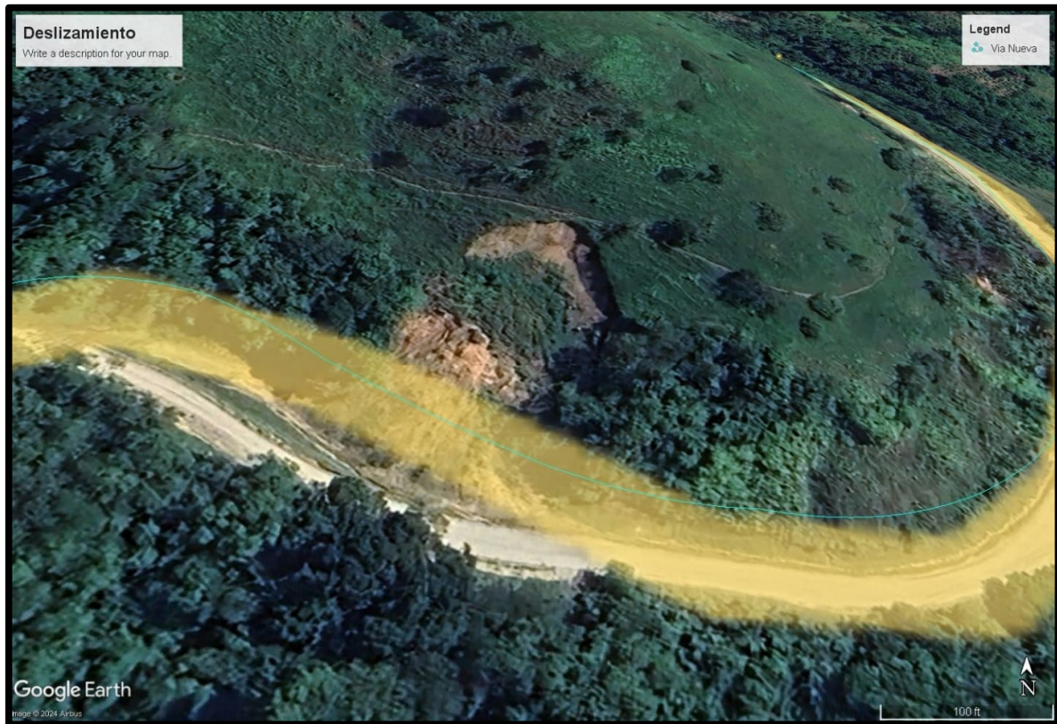
Figura 4.91. Deslizamiento en Tramo Bellavista-Progreso.
