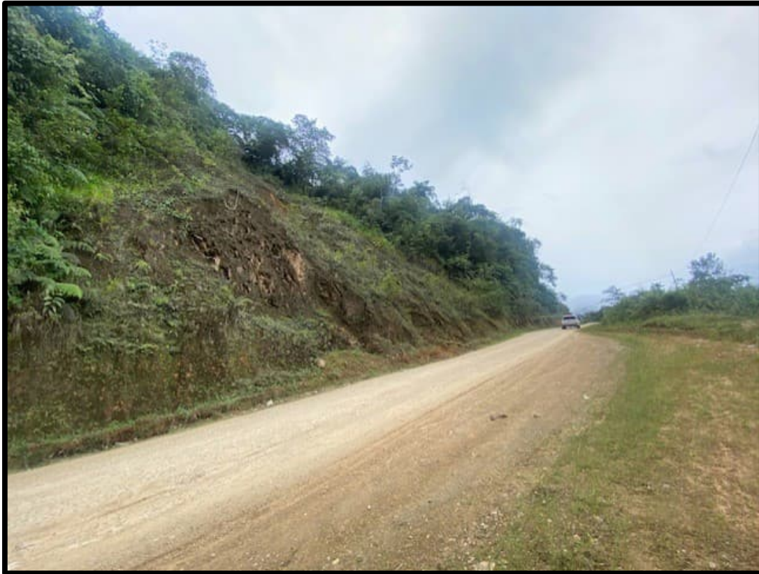
Figura 4.105. errumbe pasado y deslizamiento en talud.
