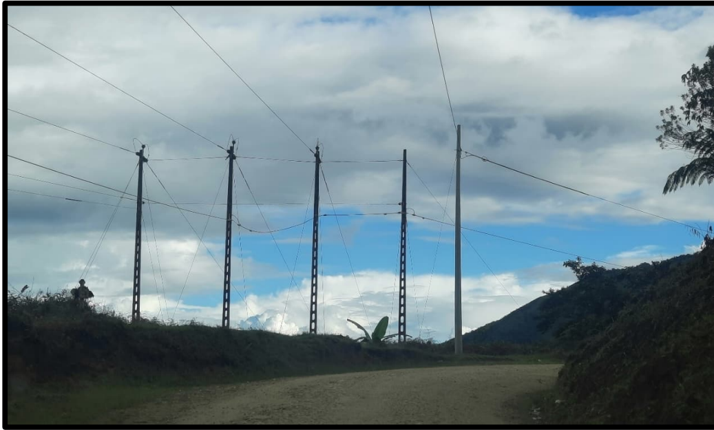
Figura 4.252. Tendido Eléctrico en el AID del proyecto
