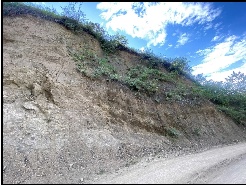
Figura 4.213. Talud inestable con deslizamiento de tierra.
