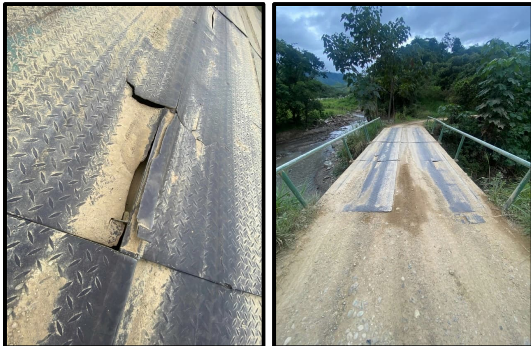
Figura 4.161. Deterioro en Puente Zumbayacu.
