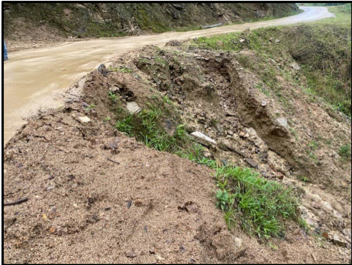
Figura 4.112. Bote Lateral a ladera de montaña en la vía.
