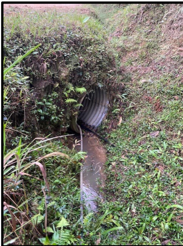
Figura 4.190. Alcantarilla T1 y conexiones de agua.
