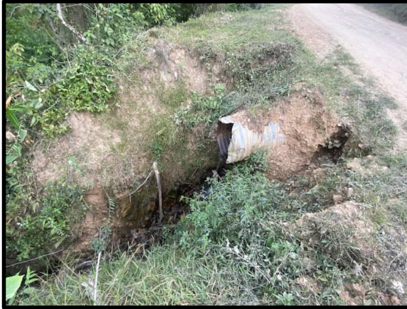
Figura 4.197. Deterioro salida de alcantarilla T8 y erosión en ladera.
