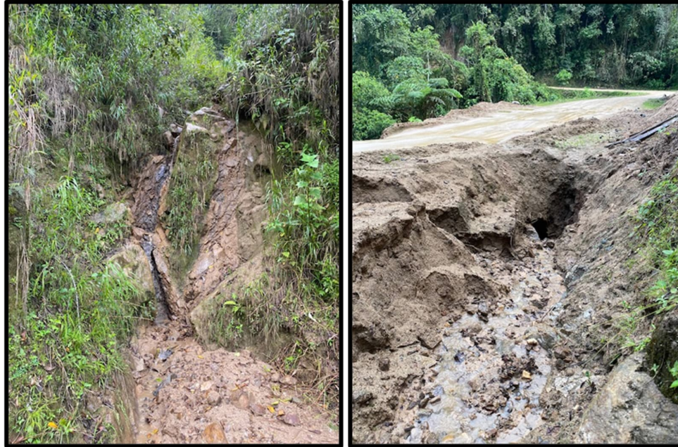
Figura 4.76. Quebrada y obstrucción de Alcantarilla T13.
