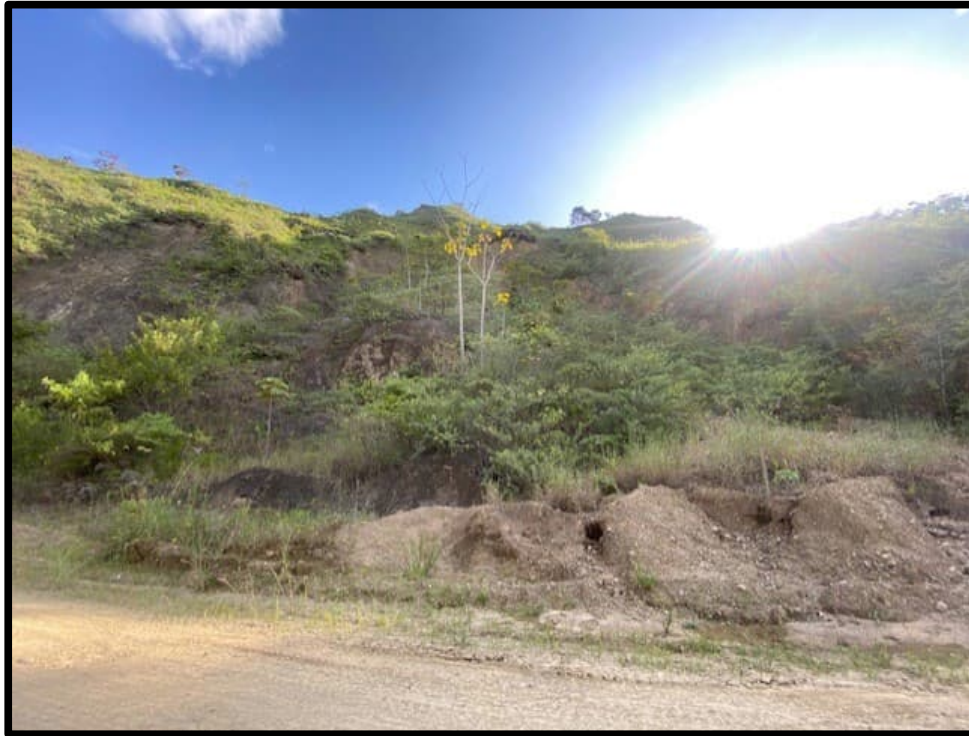
Figura 4.217. Talud inestable y deslizamiento de tierra en su pie.
