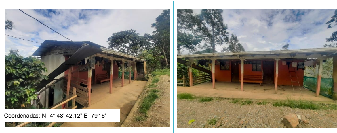
Figura 8.11: Vivienda Afectada N°8
