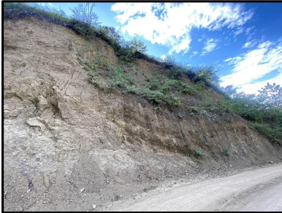
Figura 4.213. Talud inestable con deslizamiento de tierra.
