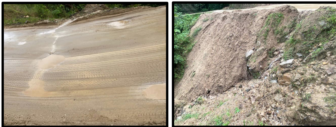
Figura 4.77. Acumulación de agua sobre la ruta y material en ladera de montaña.
