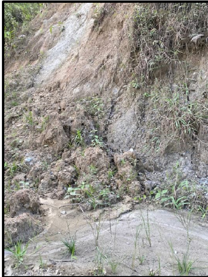
Figura 4.211. Deslizamiento de tierra al pie del talud y erosión hídrica.
