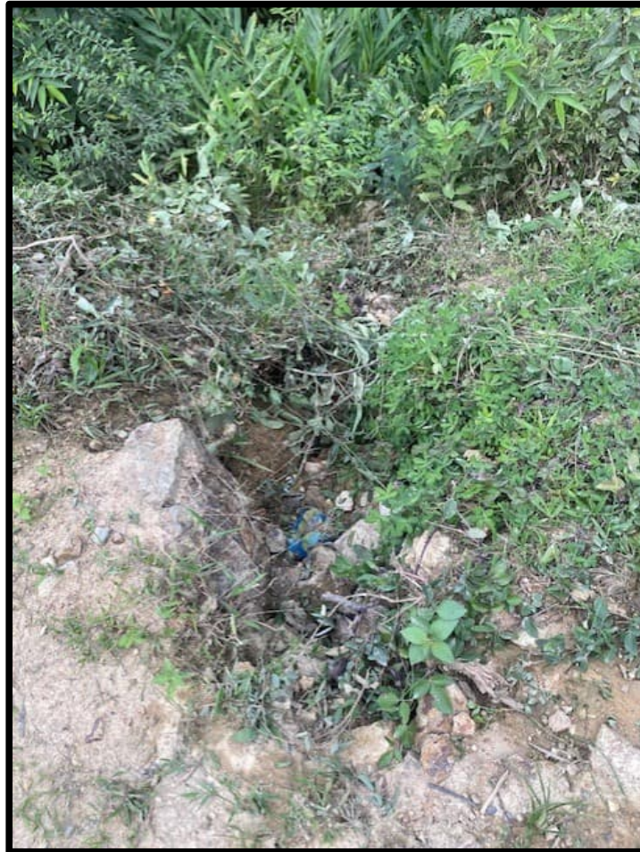
Figura 4.208. Signos de derrumbe en ladera de montaña, cauce hídrico, erosión y residuos.
