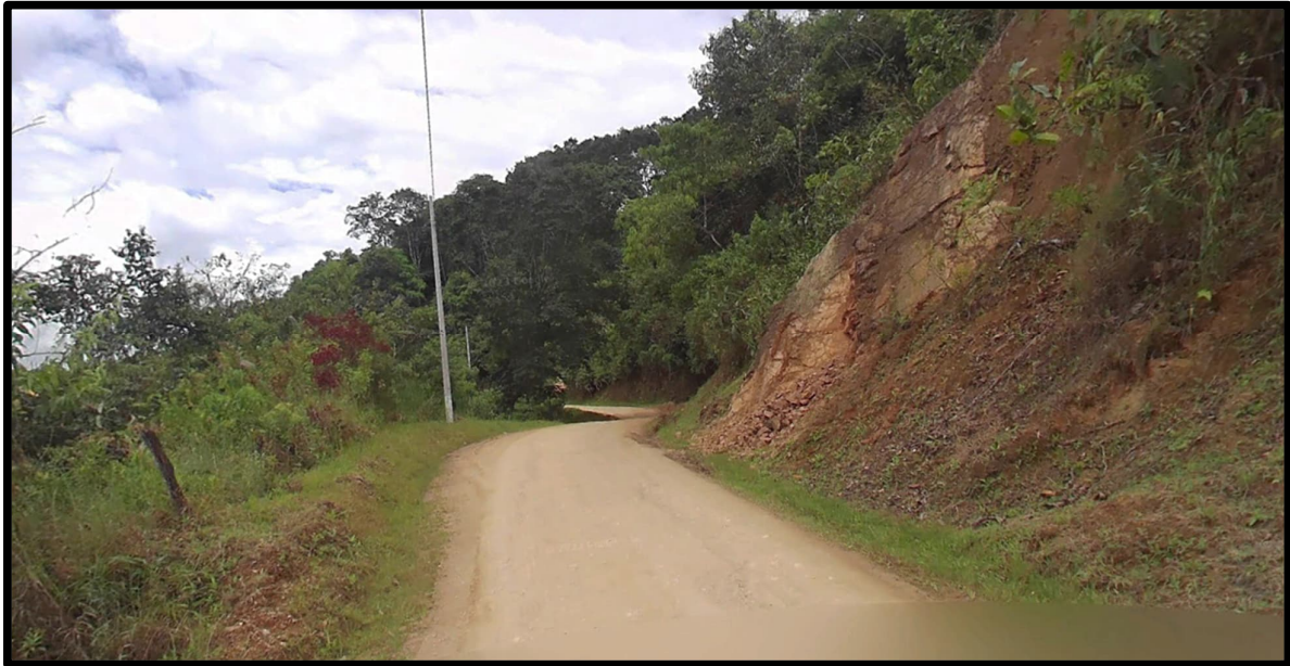
Figura 4.108. Inestabilidad de talud y desprendimiento de material.
