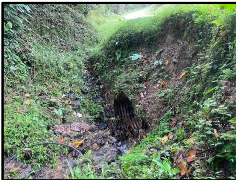
Figura 4.69. Alcantarilla T14, erosión en zanja y acumulación de piedras y ramas.
