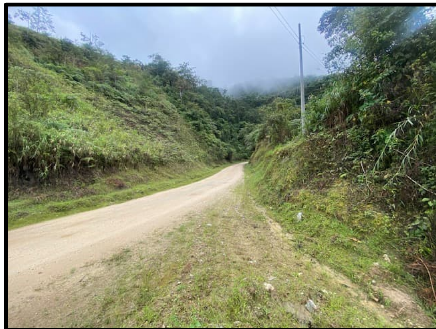
Figura 4.88. Vista del bote lateral sobre ruta.
