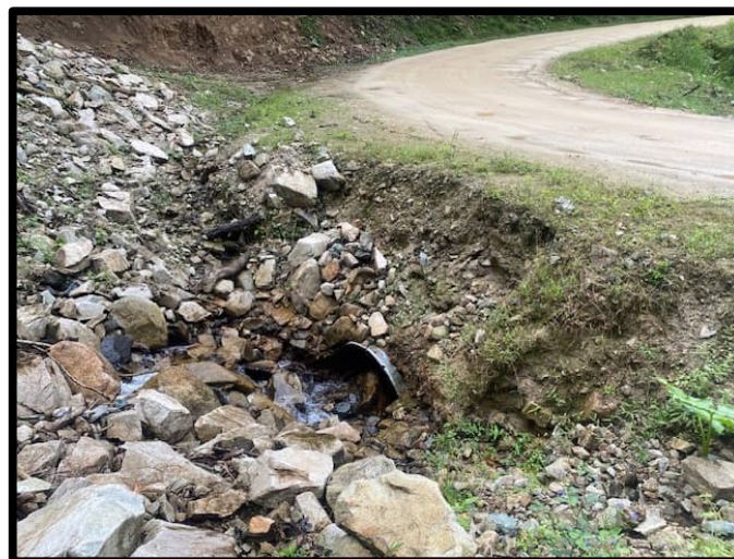
Figura 4.71. Estado de Alcantarilla.
