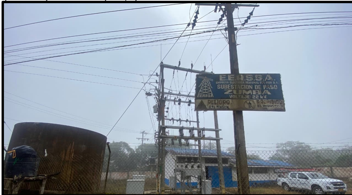
Figura 4.254. Subestación EERSSA en Zumba.
