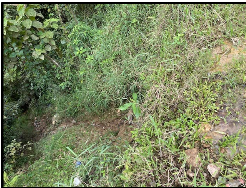
Figura 4.85. Erosión en ladera de montaña por quebrada sin alcantarillado.
