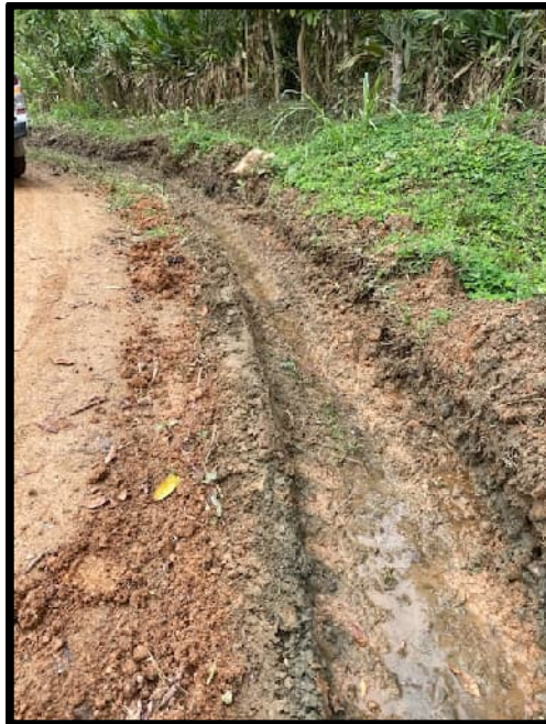
Figura 4.189. Zanja desnuda con signos de erosión.
