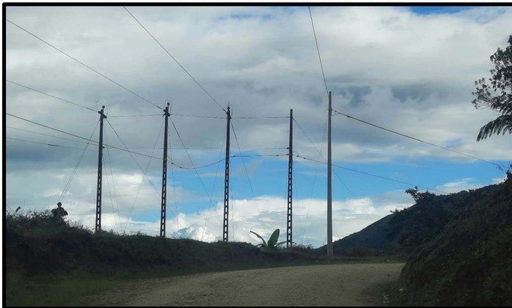
Figura 4.252. Tendido Eléctrico en el AID del proyecto
