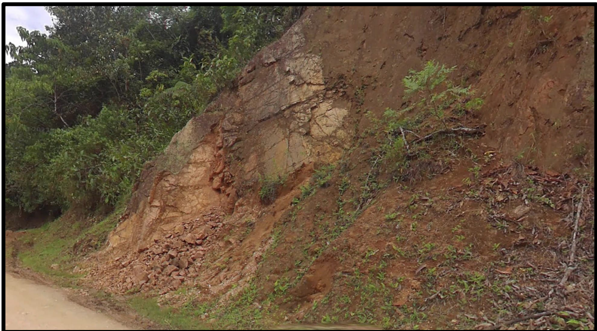
Figura 4.109. Inestabilidad del talud, desprendimiento de material y posible extracción.
