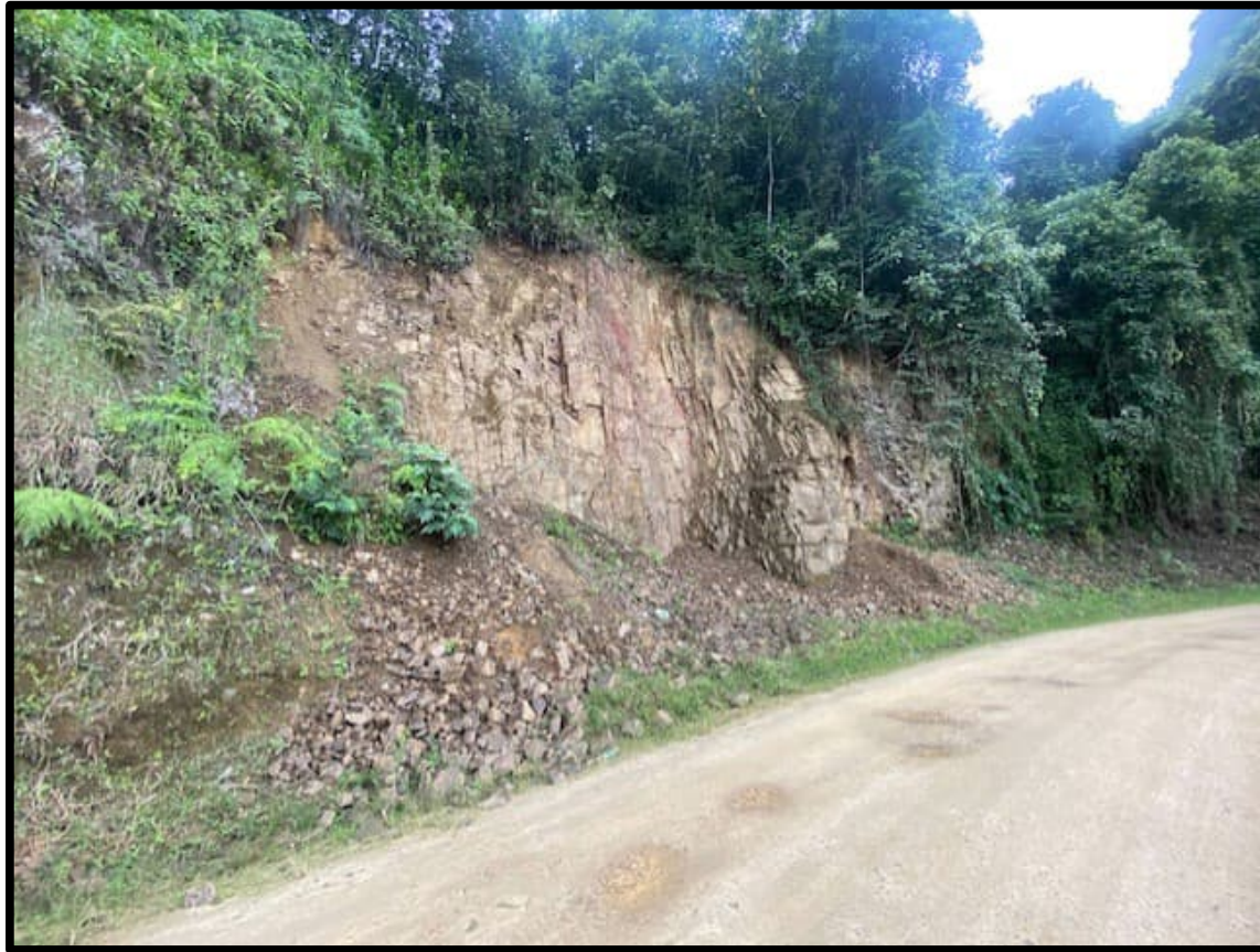
Figura 4.117. Talud inestable con deslizamiento de material.
