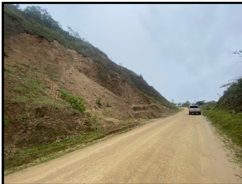
Figura 4.94. Deslizamiento e inestabilidad de talud.
