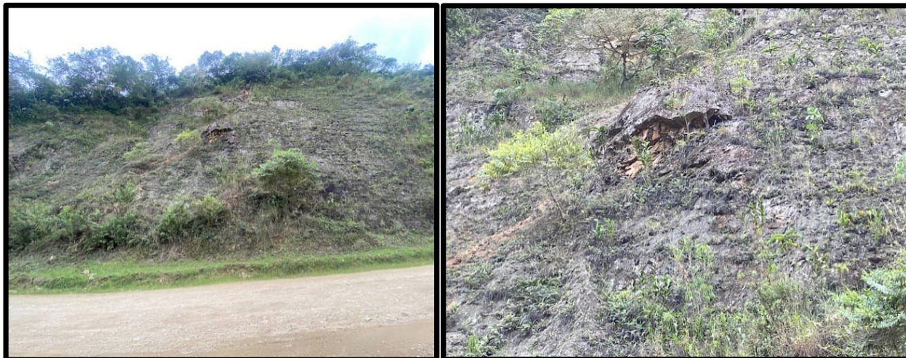
Figura 4.99. Talud inestable con desprendimiento de rocas.
