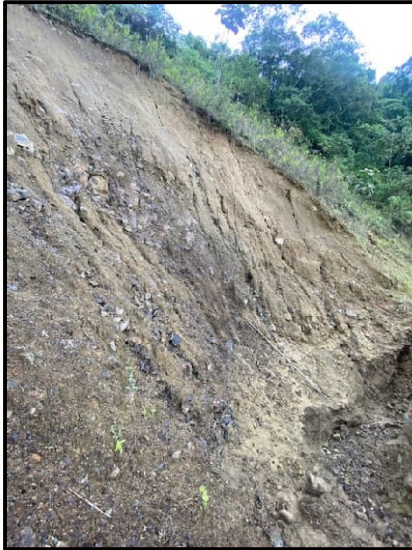
Figura 4.118. Deslizamiento de material y erosión hídrica.
