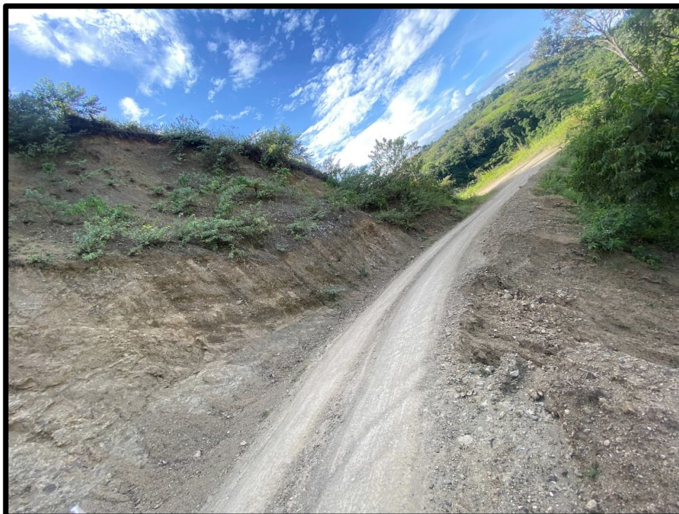
Figura 4.214. Deslizamiento y bote lateral por ladera de montaña.
