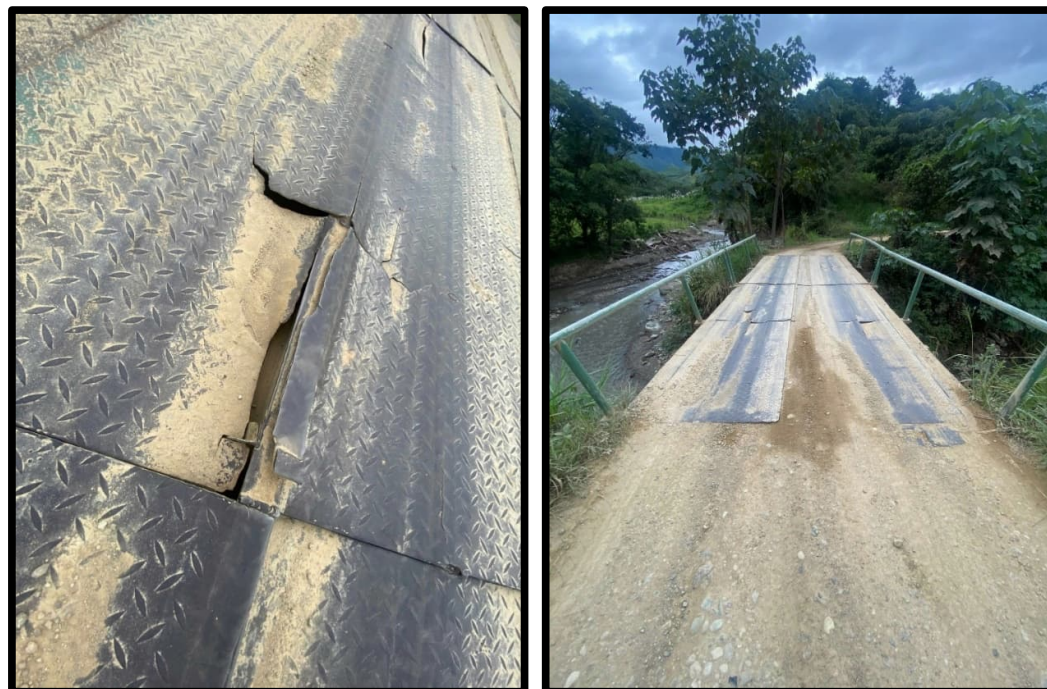
Figura 4.161. Deterioro en Puente Zumbayacu.
