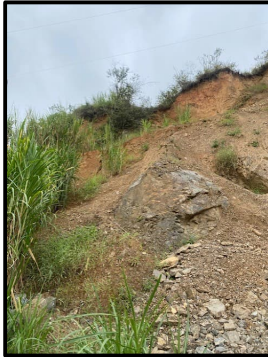
Figura 4.146. Inestabilidad del talud y deslizamiento de tierra.
