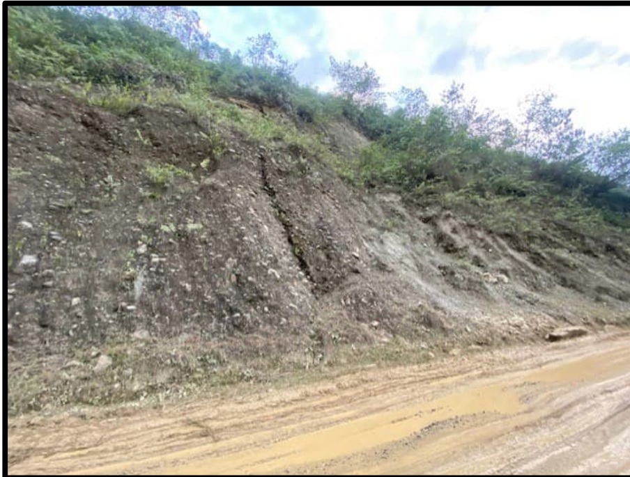
Figura 4.205. Talud Inestable con surcos de erosión hídrica y acumulación material deslizado al pie.
