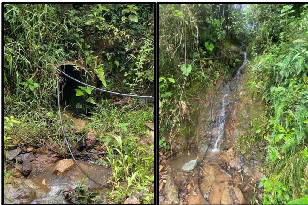
Figura 4.178. Alcantarilla T6 y conexiones de agua.
