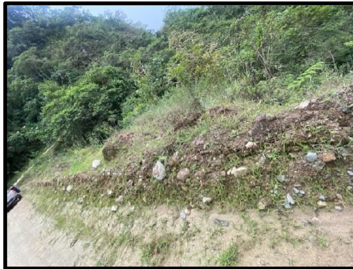
Figura 4.102. Acumulación de material de derrumbe al costado de la vía.
