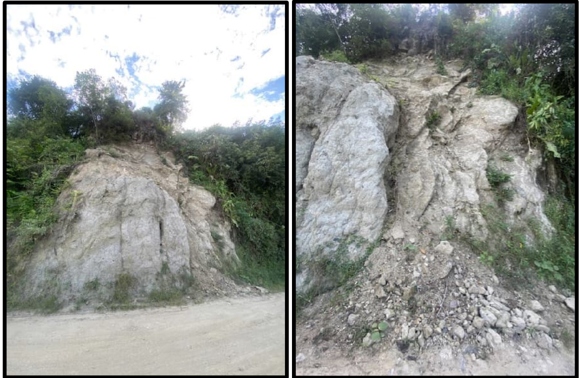
Figura 4.212. Deslizamiento de talud inestable.
