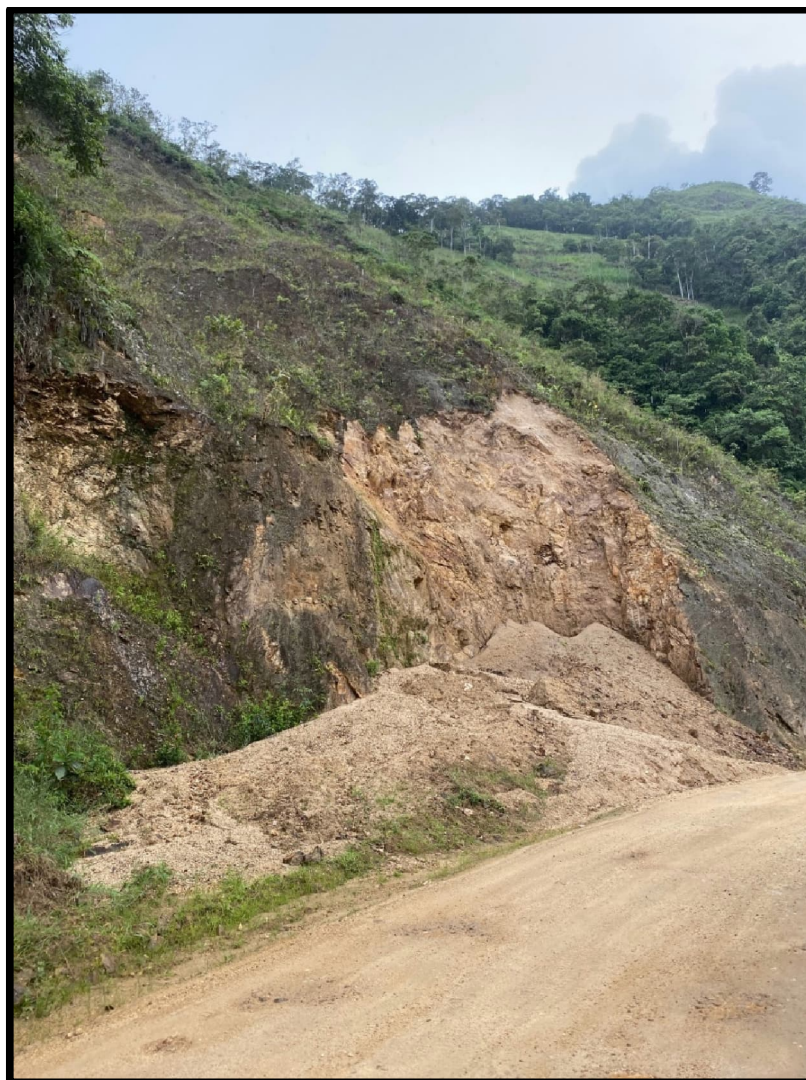
Figura 4.116. Deslizamiento con gran cantidad de material en base de talud.
