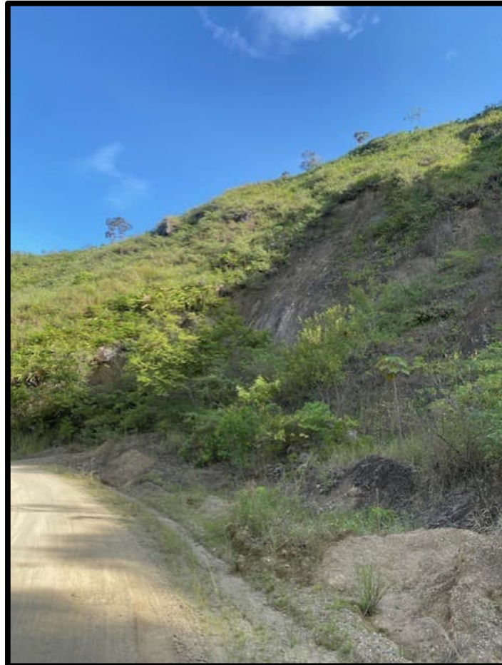
Figura 4.216. Talud inestable con deslizamiento de tierra en su pie.
