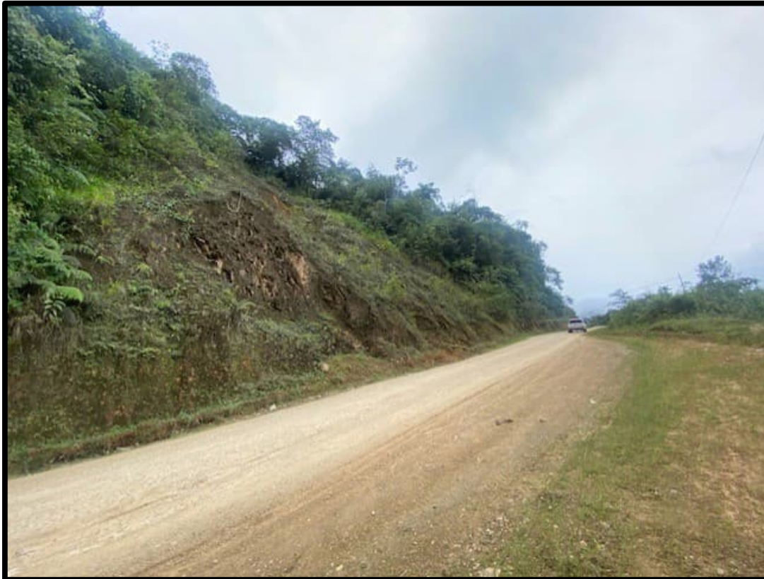
Figura 4.105. errumbe pasado y deslizamiento en talud.
