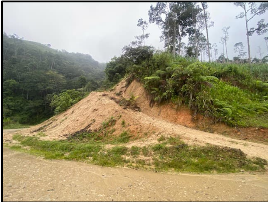
Figura 4.87. Vista de apertura de camino e inestabilidad de talud con deslizamiento de tierra en su base.
