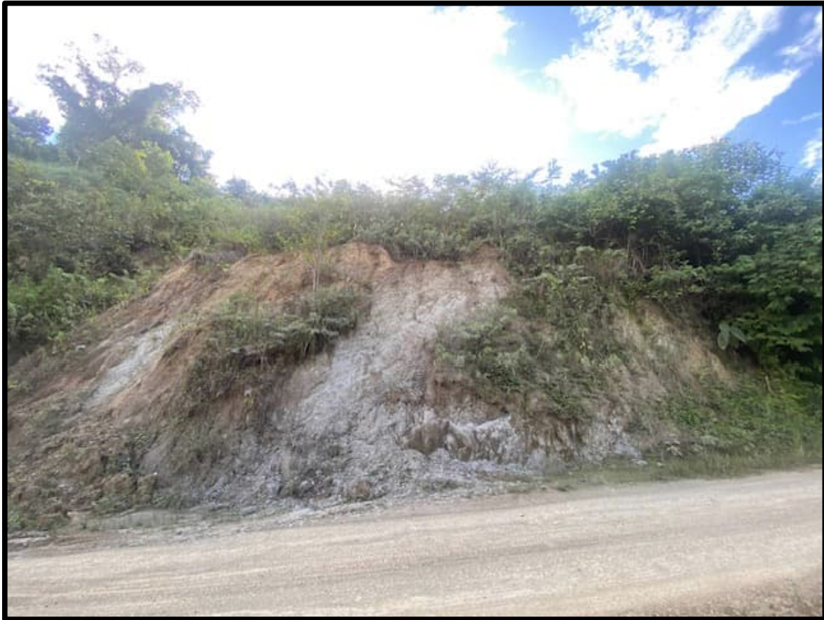
Figura 4.210. Ubicación talud inestable con deslizamiento de tierra.
