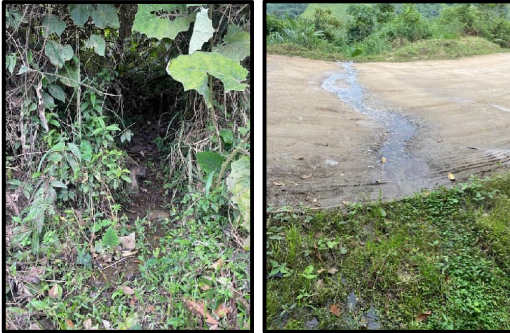
Figura 4.86. Quebrada Progreso sin alcantarillado.
