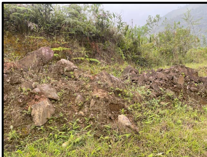
Figura 4.96. Bote Lateral y disposición de material desprendido al margen de la vía.
