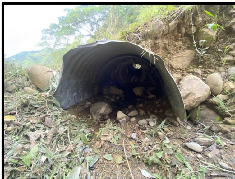
Figura 4.196. Deterioro en alcantarilla de metal y bloqueo parcial.
