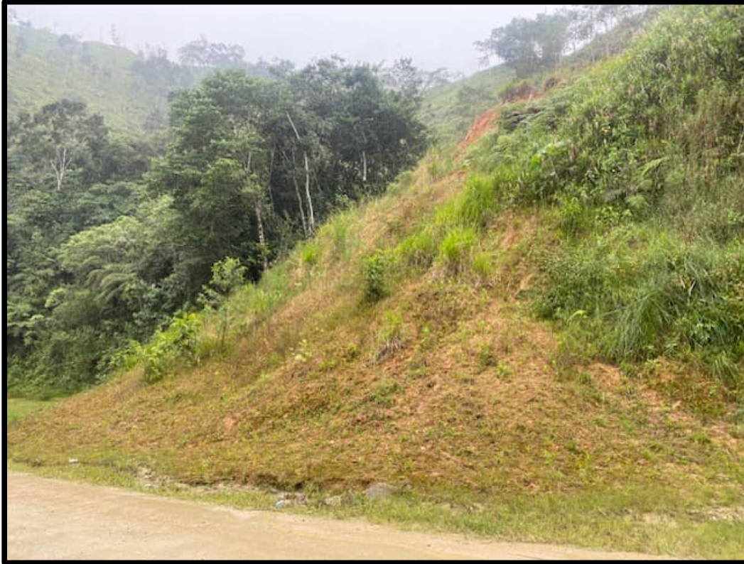
Figura 4.92. Deslizamiento en Tramo Bellavista-Progreso.
