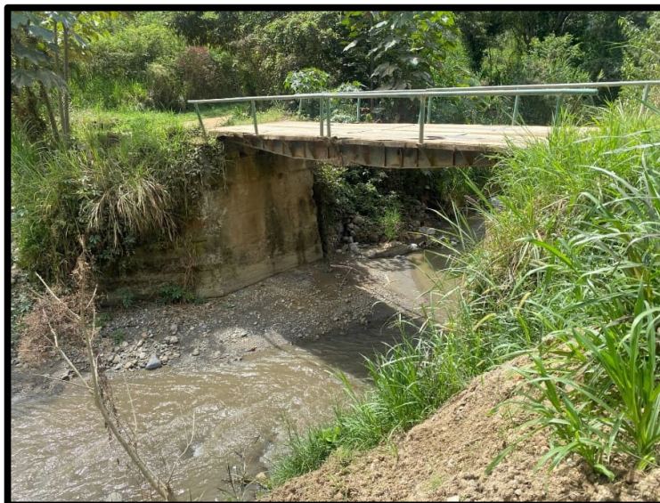
Figura 4.160. Puente Zumbayacu existente en importante estado de deterioro.
