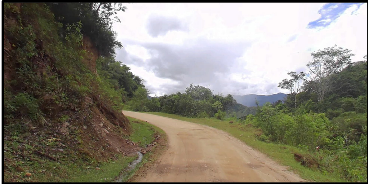
Figura 4.107. Inestabilidad del talud y desprendimiento de tierra.
