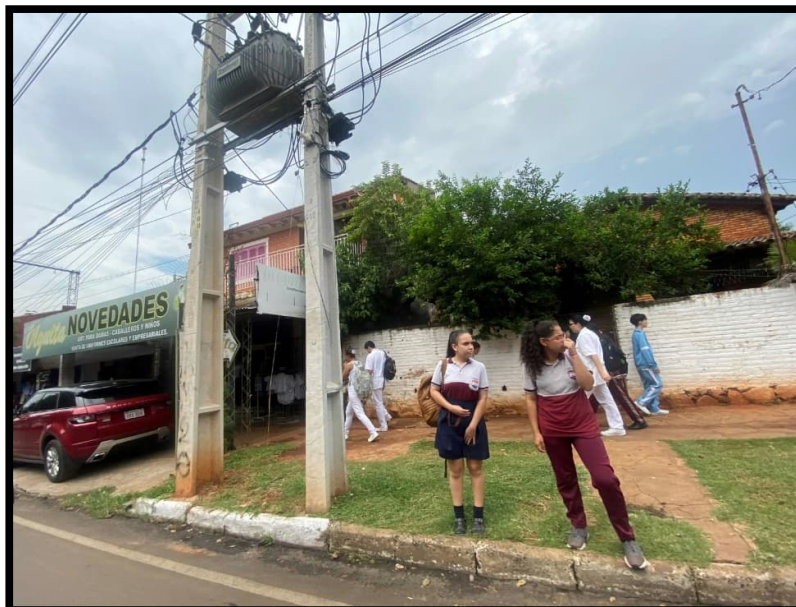
Figura 1.97. Transformador de línea de media a baja tensión sobre calles Luis Alberto Rachit y Francisco Mariscal López.
