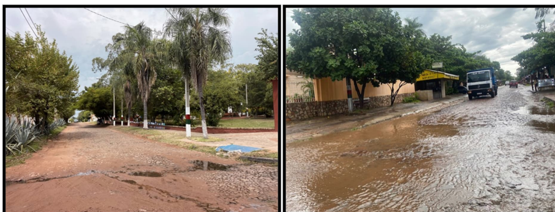
Figura 1.103. Mal estado de calles empedradas y anegamiento de agua observado.
