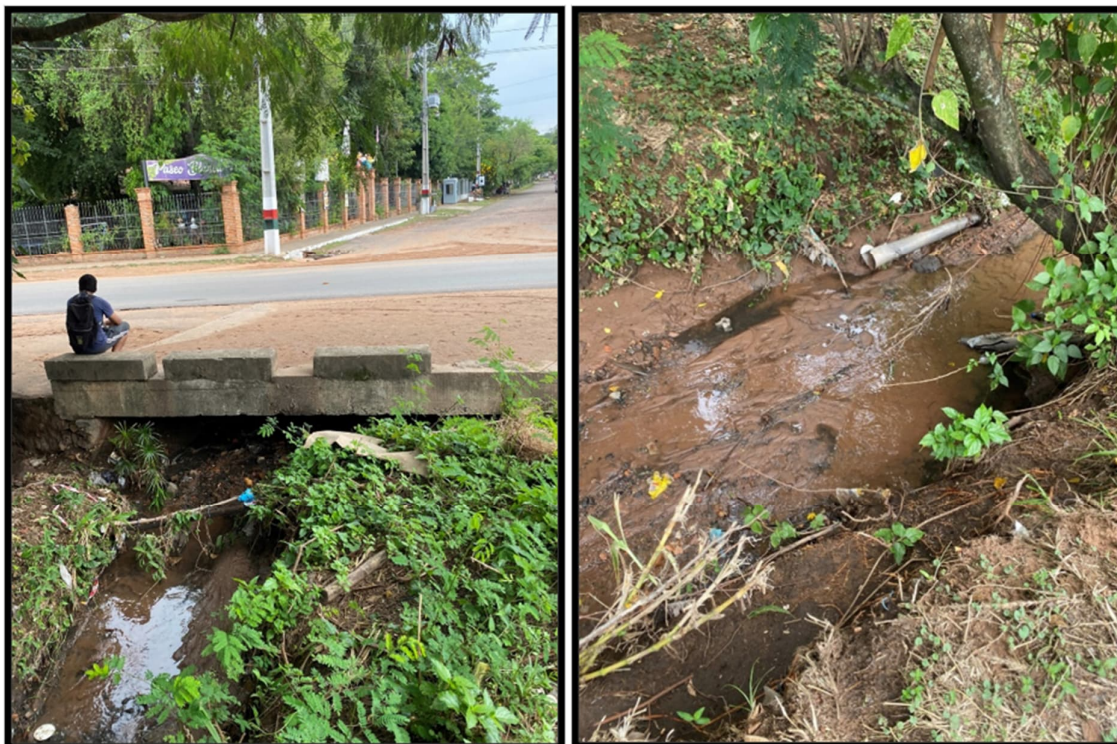
Figura 1.99. Arroyo Santo Domingo desentubado en su último tramo. Vista de conexiones irregulares y erosión de suelos.
