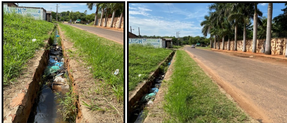
Figura 1.105. Zanjas de desagüe pluvial en deterioro sobre calle Genaro Rodríguez y Virgen del Rosario, con conexiones tendido eléctrico de media tensión
