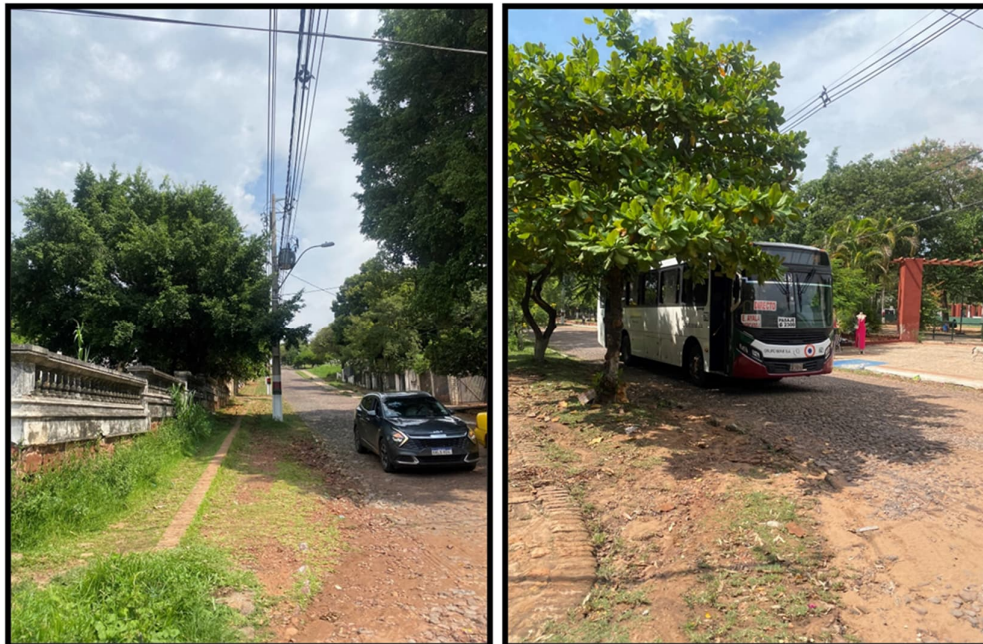
Figura 1.101. (a) Tendido de Media Tensión sobre calles Bernardino Caballeros y Fulgencio Yegros, sobre Plaza Héroes del Chaco; (b) Transporte Público sobre Calle Fulgencio Yegros
