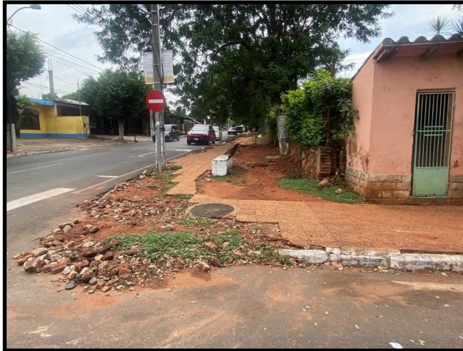
Figura 1.96. Veredas en mal estado sobre calle Boquerón, intersección Ruta Departamental D012.
