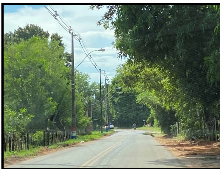
Figura 1.49. Tendido eléctrico media tensión sobre franja de dominio.
