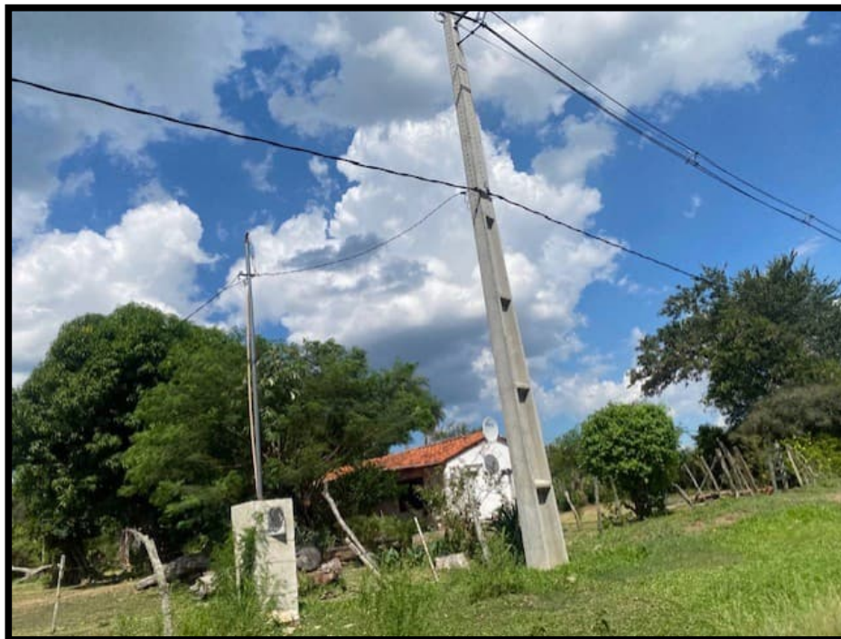
Figura 1.37. Tendido eléctrico de media tensión en margen izquierdo camilt'a Angu'a.
