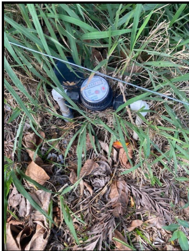
Figura 1.40. Medidor de agua potable en sitio de emplazamiento.
