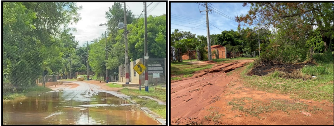
Figura 1.51. Anegamiento de Agua y Deterioro de calles de tierra.
