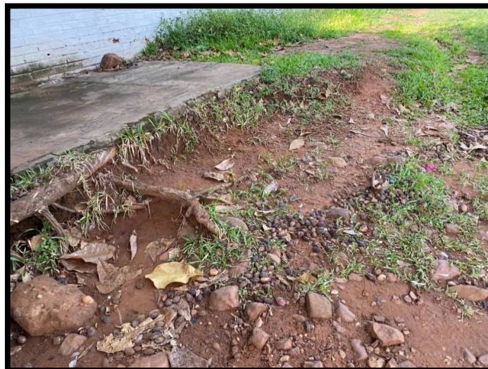
Figura 1.104. Erosión de suelo en veredas sobre Ruta Nacional YP02.
