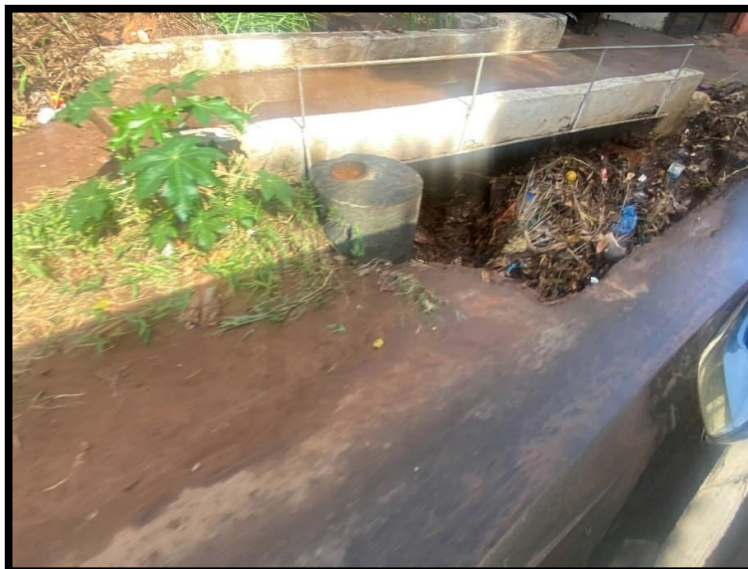
Figura 1.52. Elemento de Captación Pluvial con restos de ramas y residuos. sobre D076.
