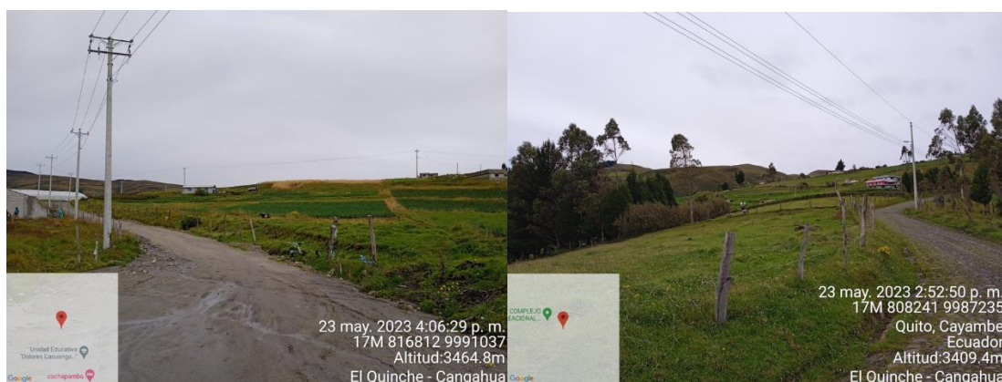
Red de servicio eléctrico en la parroquia Cangahua
