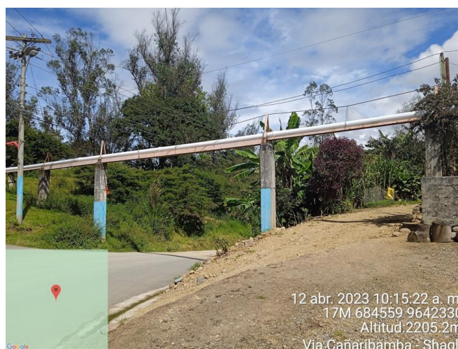
Ilustración31. Tubería elevada de agua potable, parroquia de Cañaribamba
