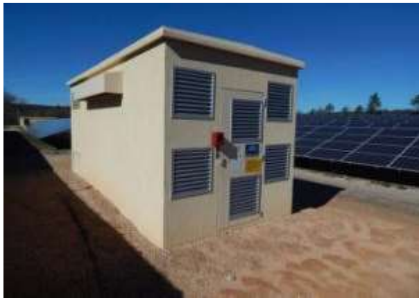
Figure 39 : Poste de transformation sans parement
