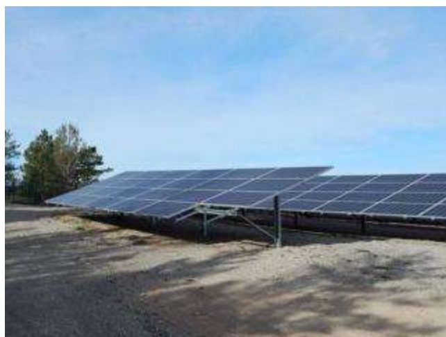
Figure 32 : Exemple d'une table photovoltaïque
