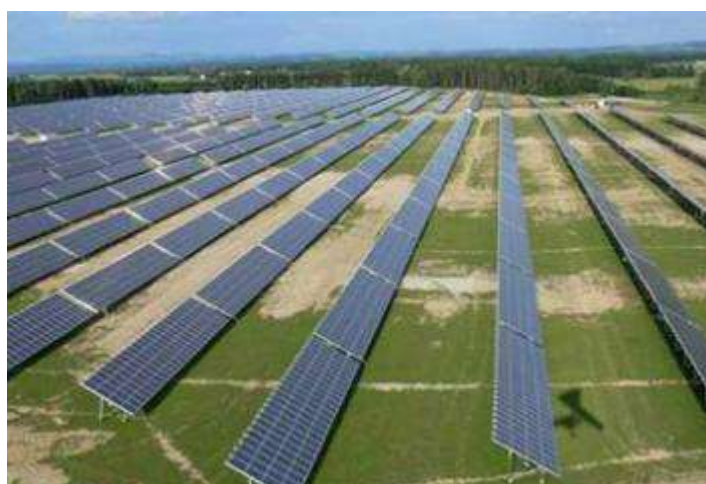
Figure 30 : Panneaux photovoltaïques fixes
