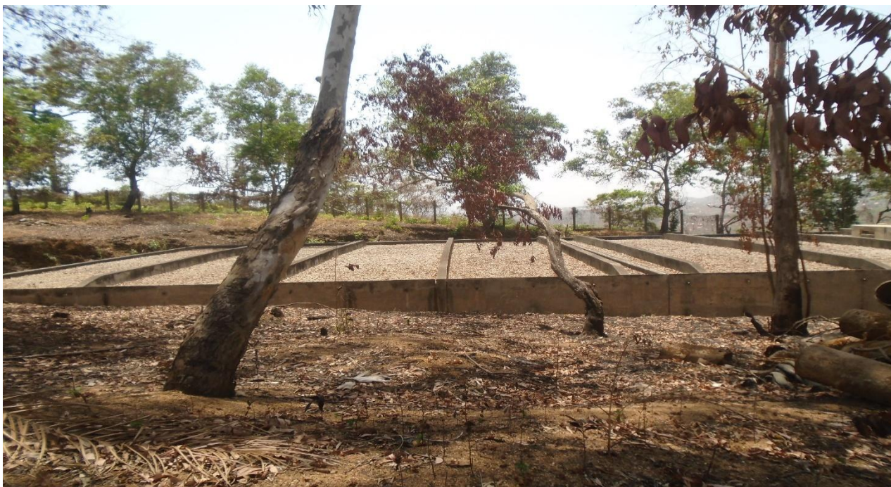
Figure 22 : Réservoir d'eau traitée
