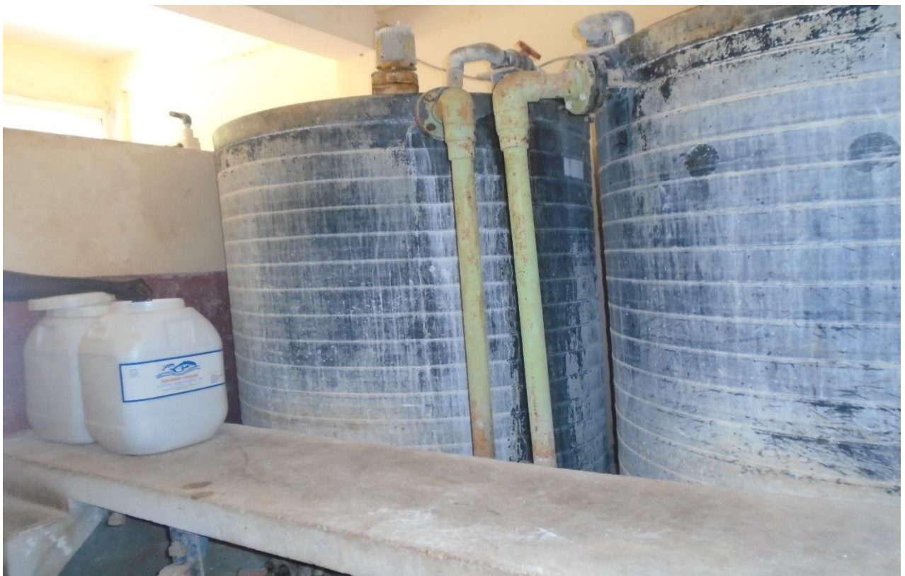
Figure 21 Salle de mélange de produit de traitement d'eau au Chlore
