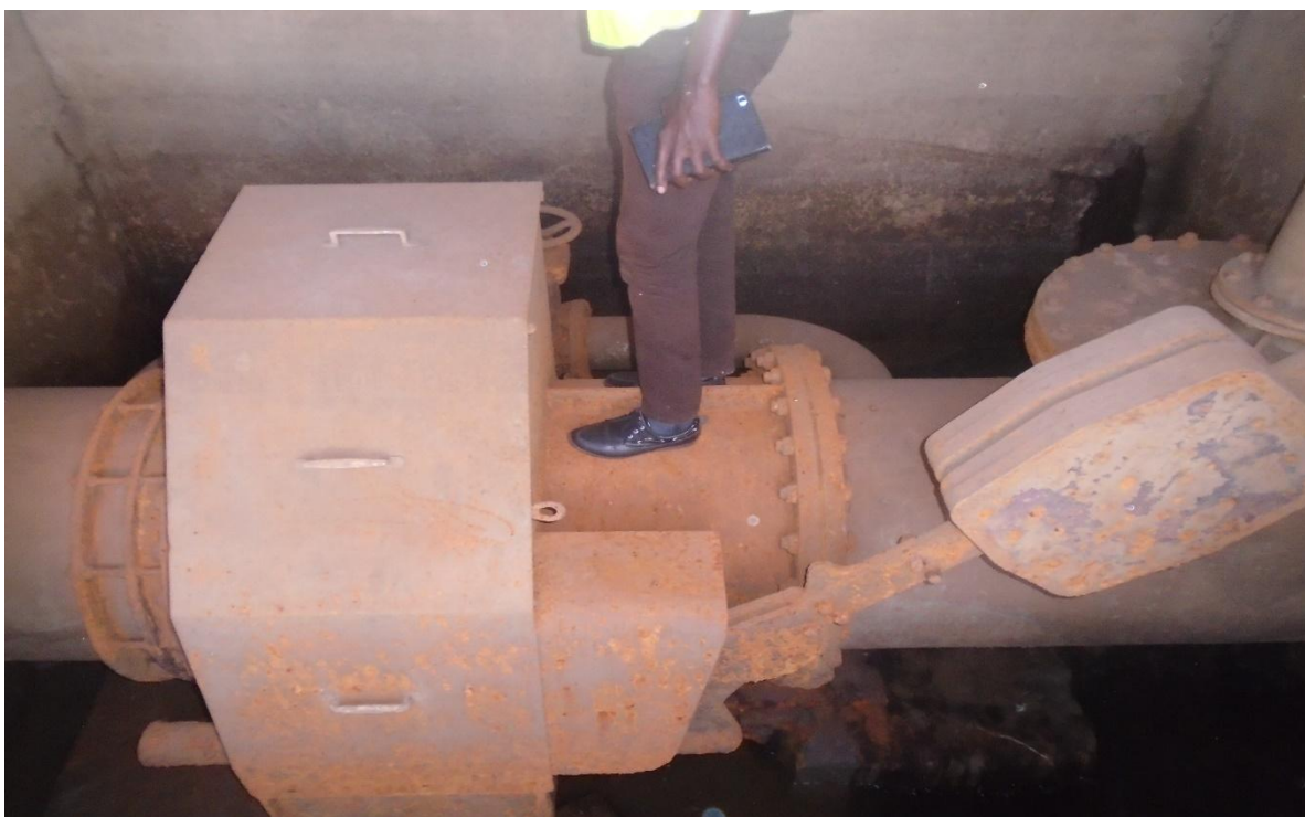
Figure 19 Vanne d'arrêt automatique attaquée par la rouille, faute d'entretien
