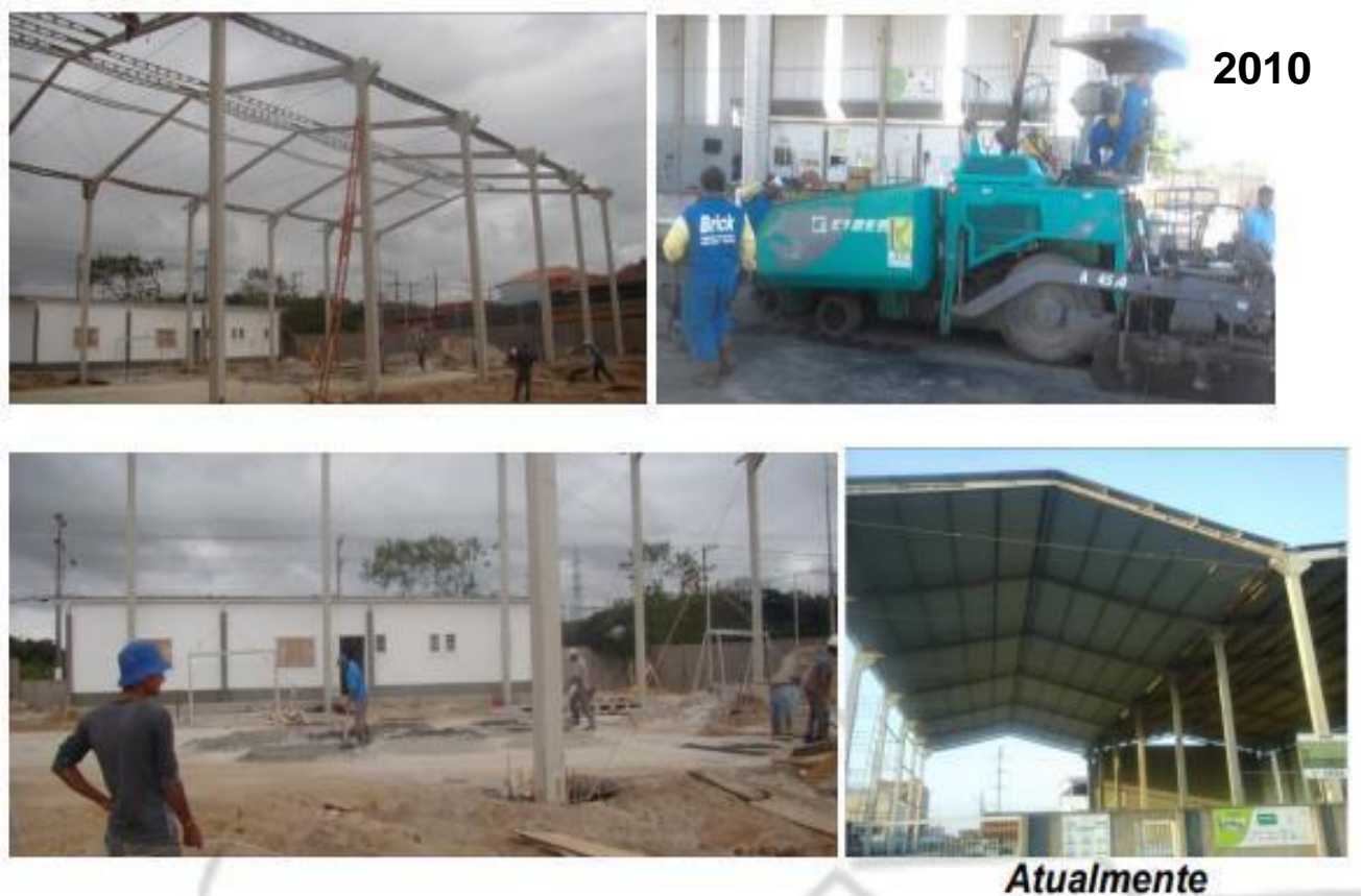
Figura 20: Imagens da construção da Associação Moradores Guaranhuns no ano de 2010 e da estrutura atual que comporta os projetos sociais.
