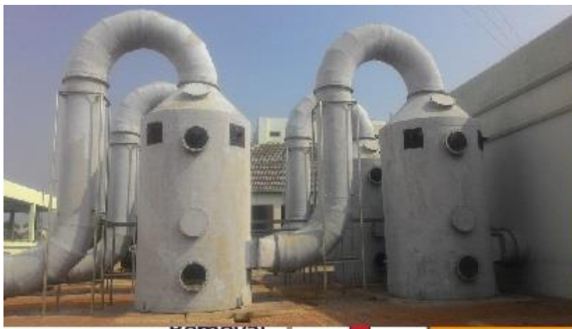
Hình 7. 1. Tháp khử mùi tại nhà máy xử lý nước thải Thủ Dầu Một
