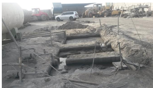
Exemple de bassin de collecte des boues de poussières derrière l'extracteur en blanc
