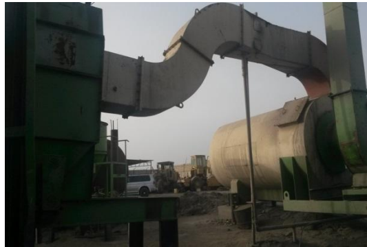
Exemple d'extracteur de poussières (Centrale de Sébikhotane)
