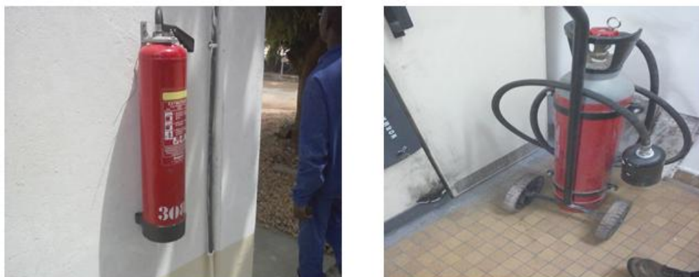
Photo 11 : Vue de quelques extincteurs au poste de Lomé-B
