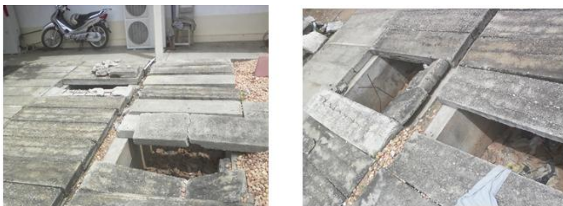
Photo 13 : Vue de quelques dalettes endommagées au poste de Lomé-B
