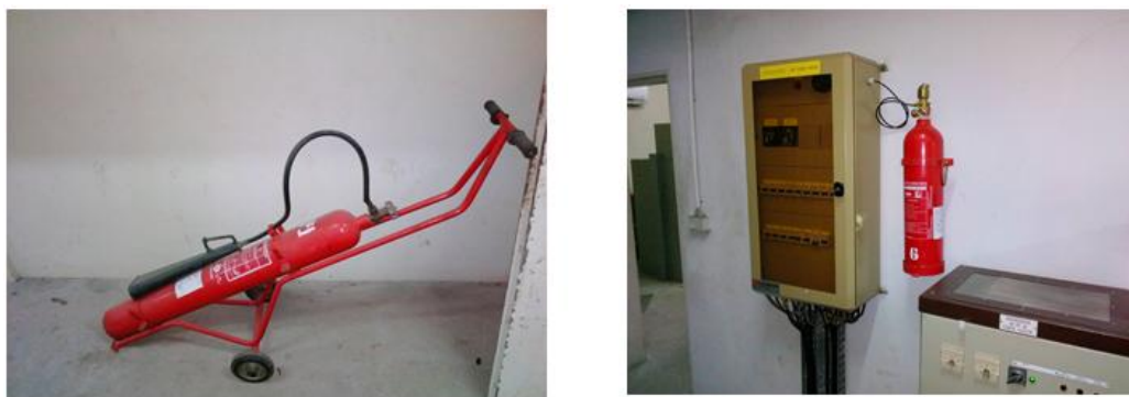
Photo 4 : Vue de quelques extincteurs au poste de Lomé-Siège
