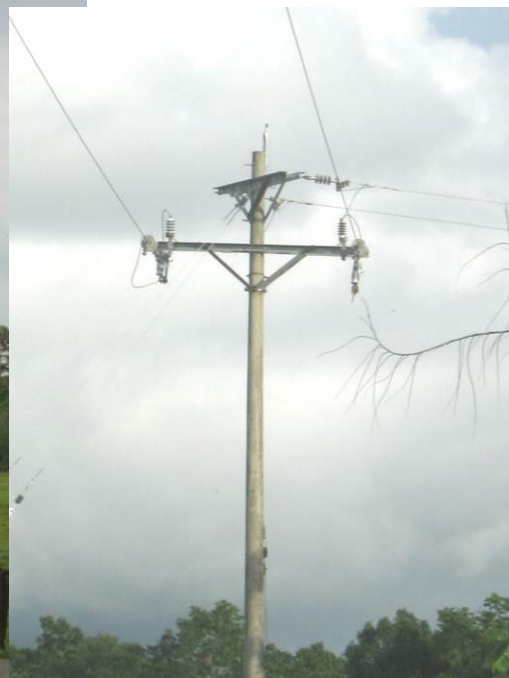
Fotografía 2-11 Red primaria a 13,2 kV, dos hilos, doble terminal
