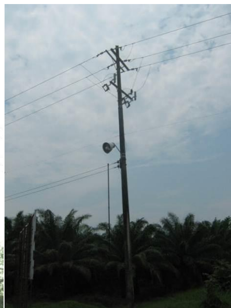
Fotografía 2-14 Red primaria a 13,2 kV, tres hilos con aisladero y pararrayos
