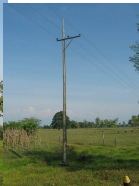
Fotografía 2-8 Red primaria a 13,2 kV, cuatro hilos, suspensión
