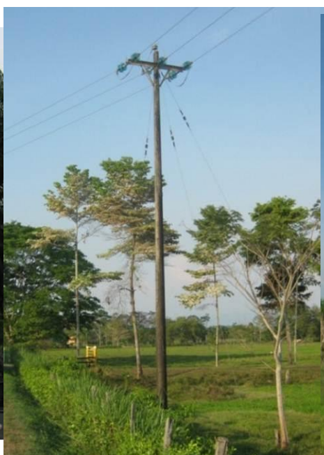
Fotografía 2-7 Red primaria a 13,2 kV, tres hilos, retención
