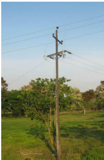
Fotografía 2-12 Red primaria a 13,2 kV, tres hilos, suspensión, con derivación
