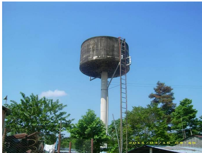
Fotografía 2-5 Tanque en operación 20 de Julio
