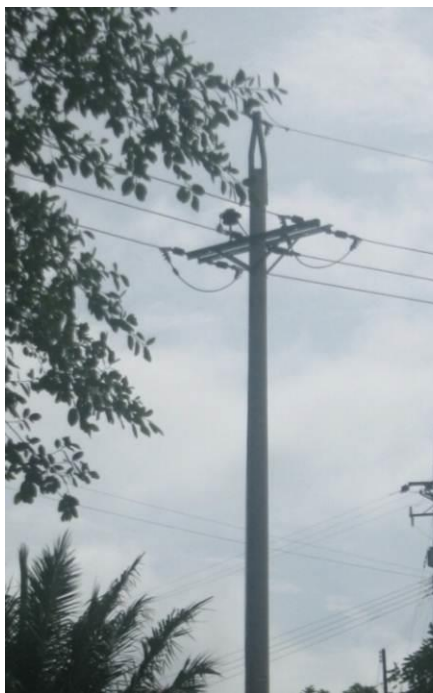
Fotografía 2-9 Red primaria a 13,2 kV, cuatro hilos, retención
