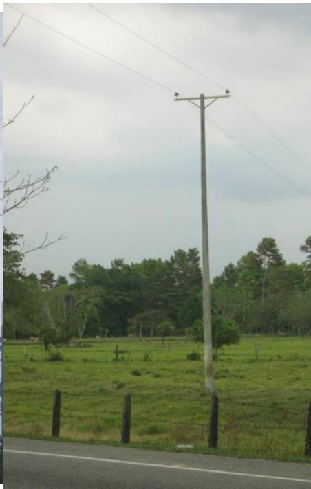
Fotografía 2-10 Red primaria a 13,2 kV, dos hilos, suspensión
