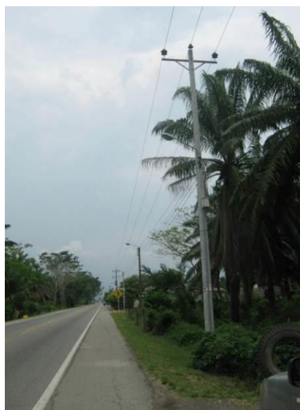
Fotografía 2-6 Red primaria a 13,2 kV, tres hilos, suspensión
