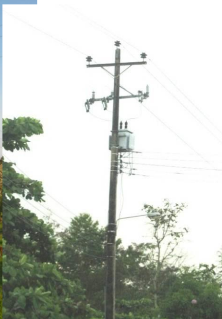
Fotografía 2-13 Red primaria a 13,2 kV, tres hilos, suspensión, con transformador
