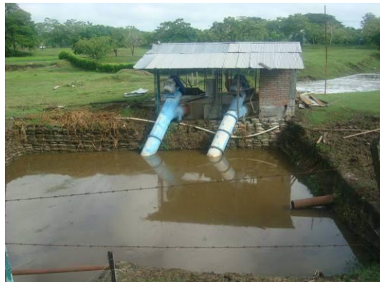
Tramo 2 - Ruta 4510 PR 130+0100 Sistema de bombeo aguas abajo de la vía. Fotografía 3-38 Cruces con redes (a)
