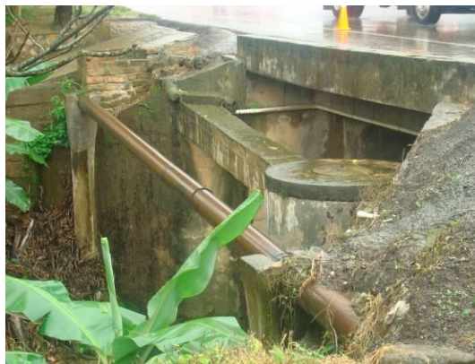
Tramo 7 - Ruta 4515 PR 42+0250 Tubería de 6" acueducto y colector embebido en concreto del alcantarillado
