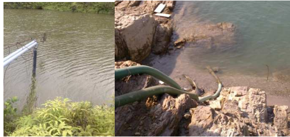
Fotografía 4-1 Sistema de captacion de aguas.
