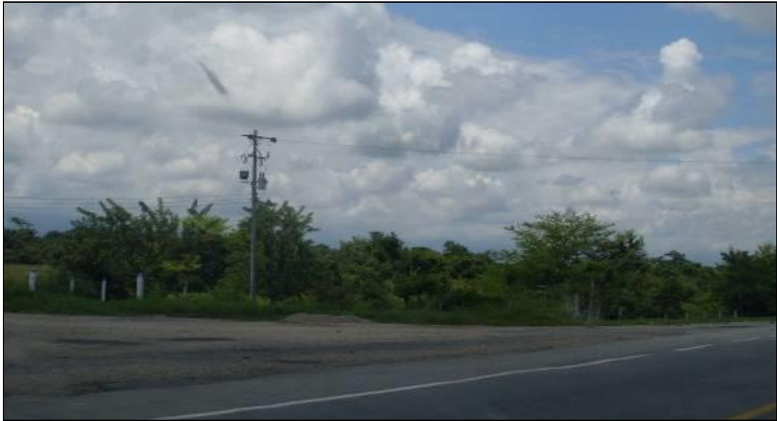
Fotografía 2-20 Infraestructura de Terceros, Red de Comunicaciones (Margen Derecha)
