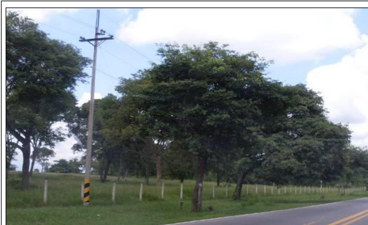
Fotografía 2-10 Estructura de Media Tensión con Circuito en Configuración Triangular (Margen Derecha)
