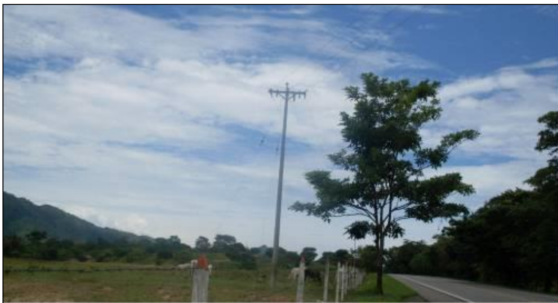
Fotografía 2-42 Estructura con cambio de dirección para circuito de MT
