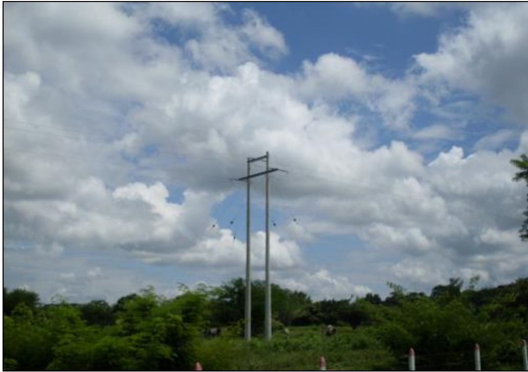
Fotografía 2-8 Estructura de Media Tensión con Retención (Margen Derecha)
