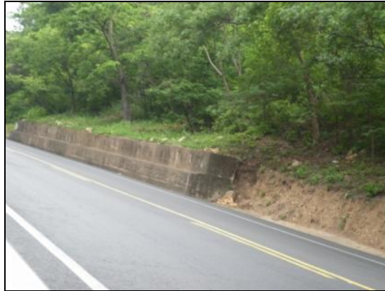
Fotografía 2-1 Muro en Falla debido a un Deslizamiento activo (PR71+000 Ruta 4514)
