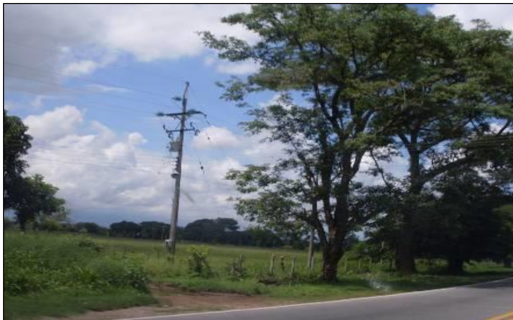
Fotografía 2-11 Estructura de Media Tensión con Circuito en Configuración Triangular con Derivación a Transformador, Baja Tensión y Alumbrado Público (Margen Derecha)
