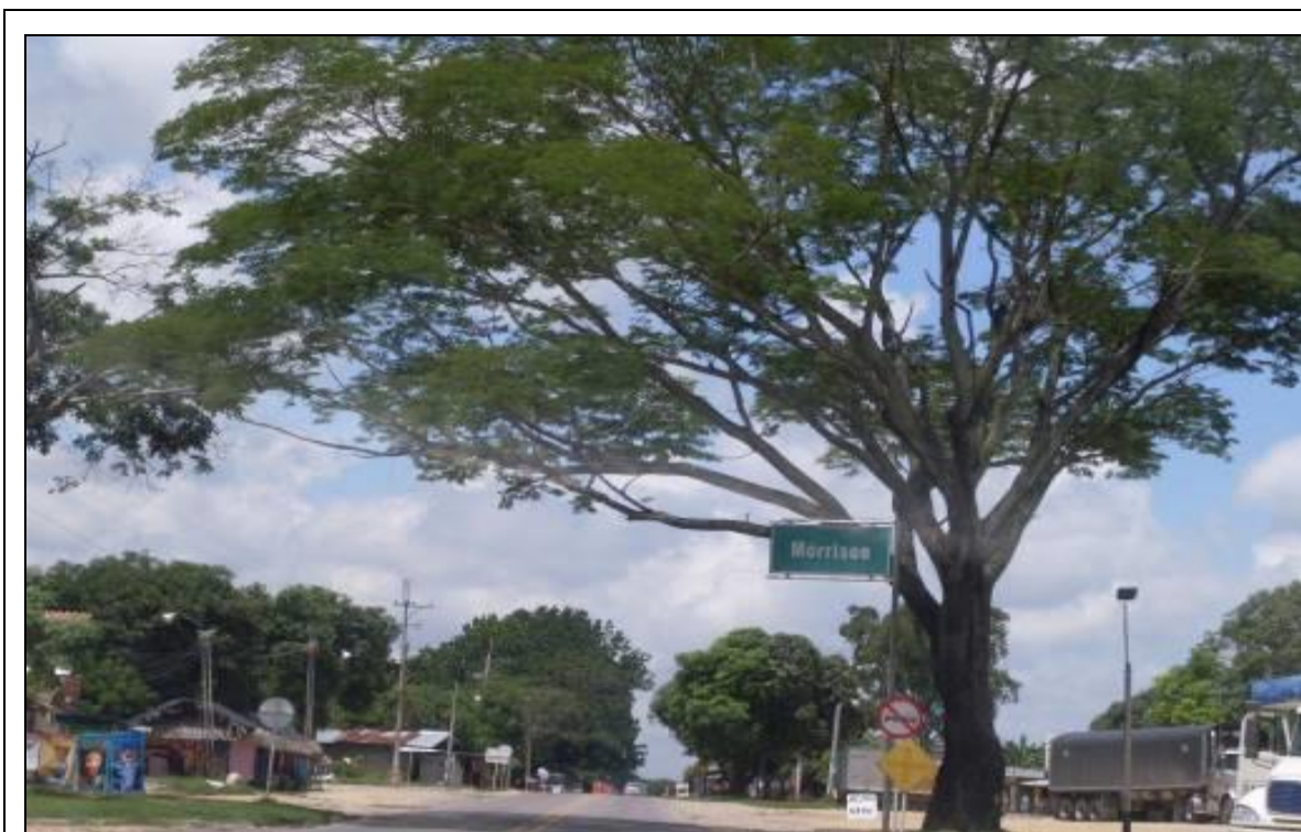
Fotografía 2-24 Infraestructura de Media Tensión y Baja Tensión en Corregimiento Morrison
