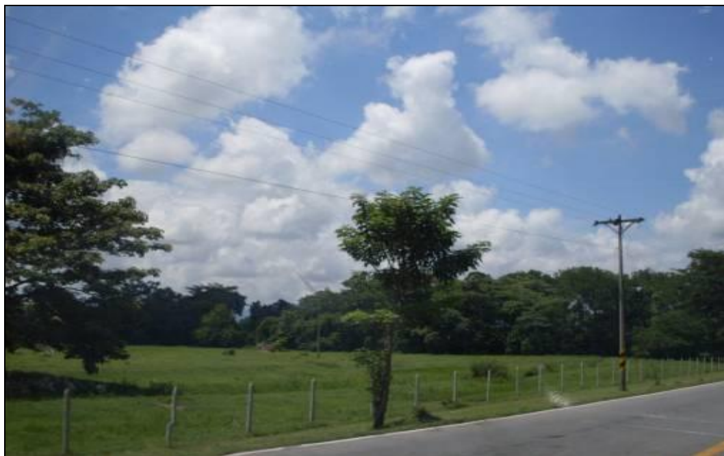
Fotografía 2-18 Estructura de Media tensión con Circuito Sencillo con retención para Cambio de Dirección (Margen Derecha)
