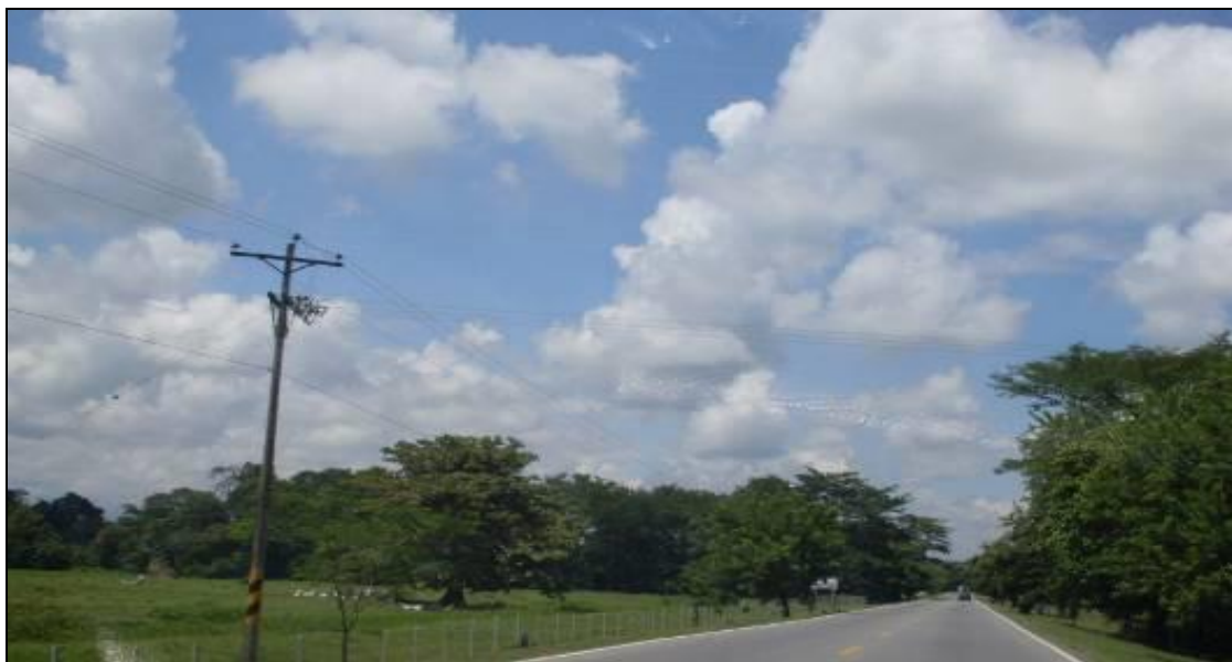
Fotografía 2-17 Estructura con Circuito de Media Tensión en Configuración Triangular y Derivación con Cruce de Vía (Margen Derecha)
