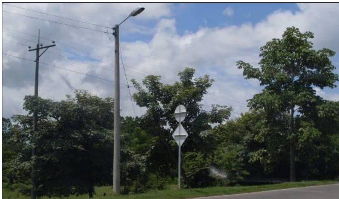
Fotografía 2-23 Infraestructura de Alumbrado Público (Margen Derecha)
