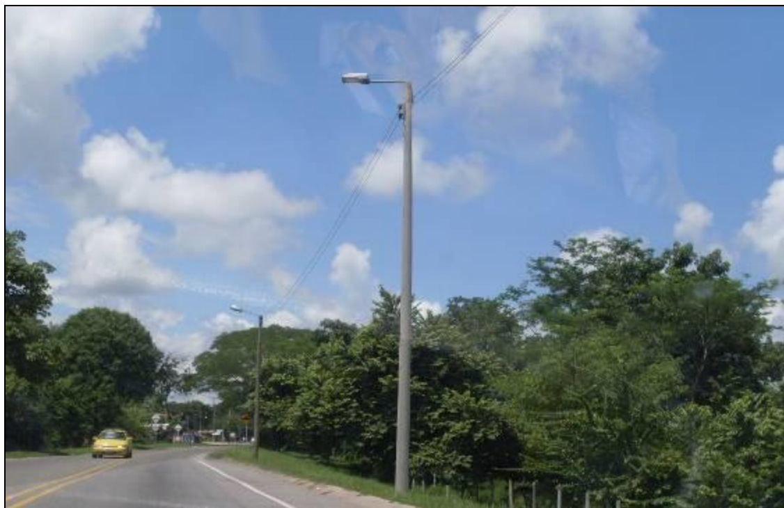
Fotografía 2-22 Infraestructura de Alumbrado Público (Margen Izquierda)
