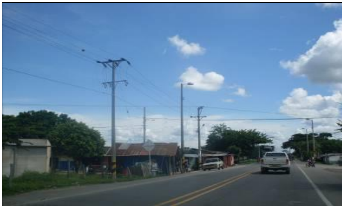
Fotografía 2-44 Estructuras de MT, BT y Alumbrado Público en casco urbano
