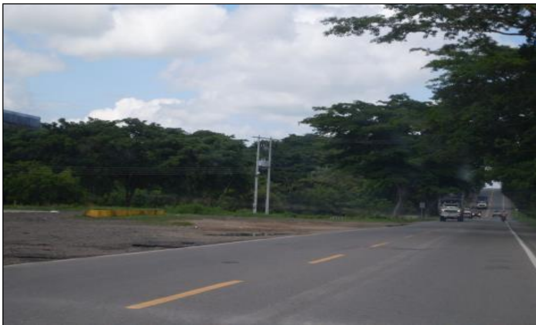
Fotografía 2-6 Estructura de Media Tensión en H con Derivación a Transformador (Margen Derecha)
