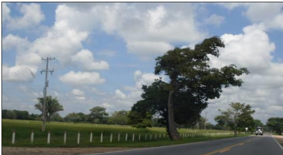
Fotografía 2-13 Estructura de Media Tensión con Derivación a Transformador y Red de Baja Tensión (Margen Derecha)
