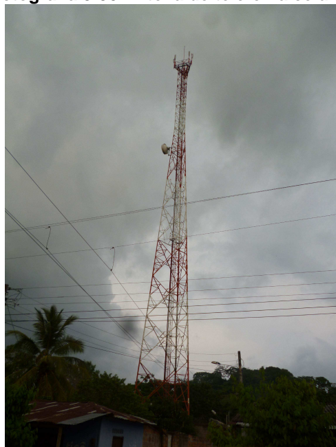
Fotografía 3-30 Antena de telefonía celular
