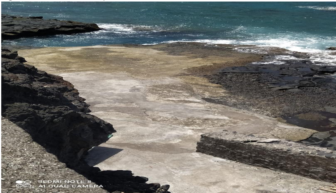
Figura 3 – Estado da Rampa
