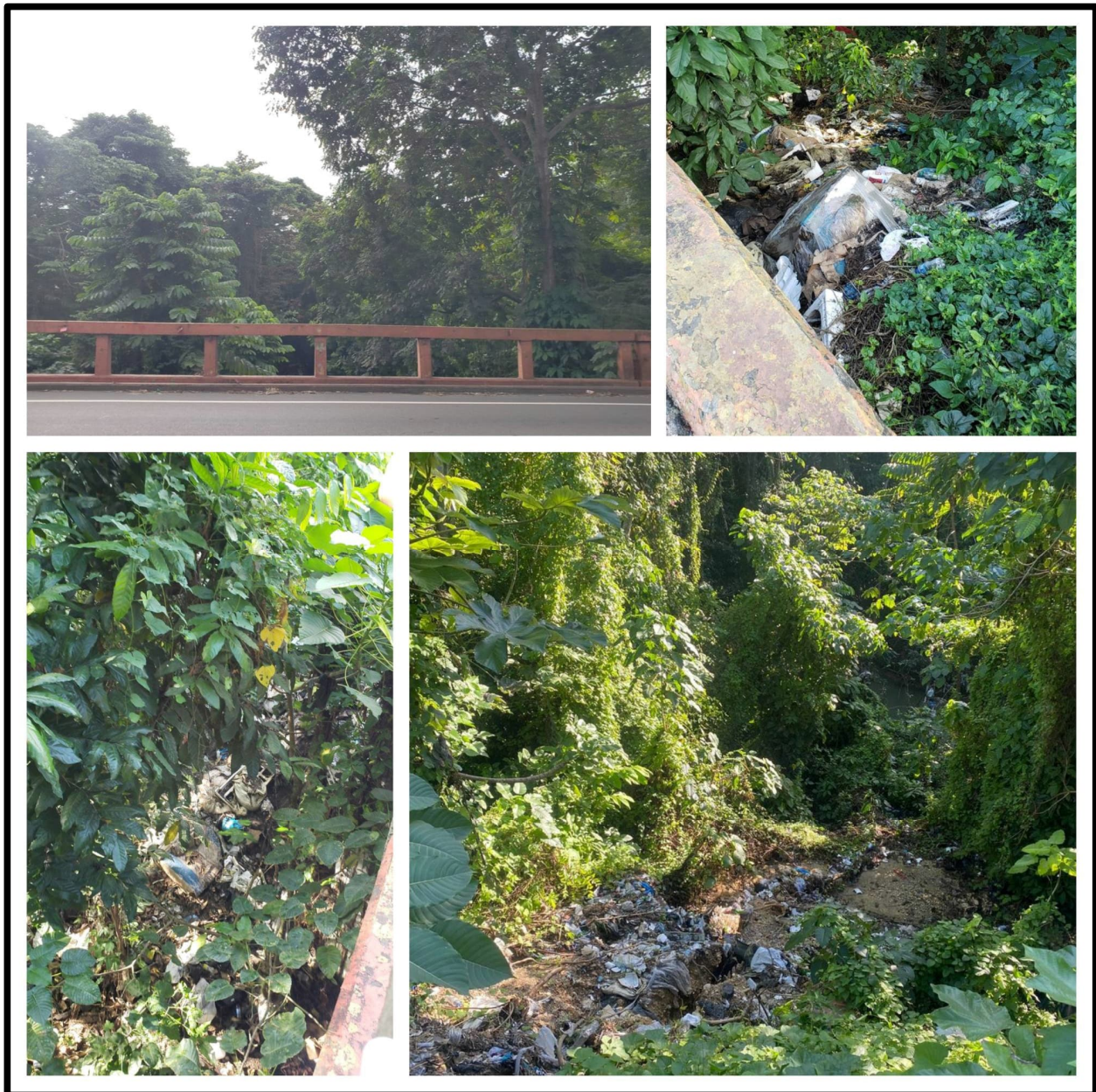
Figura 4.365: Valle del arroyo Itabó y presencia de signos de degradación
