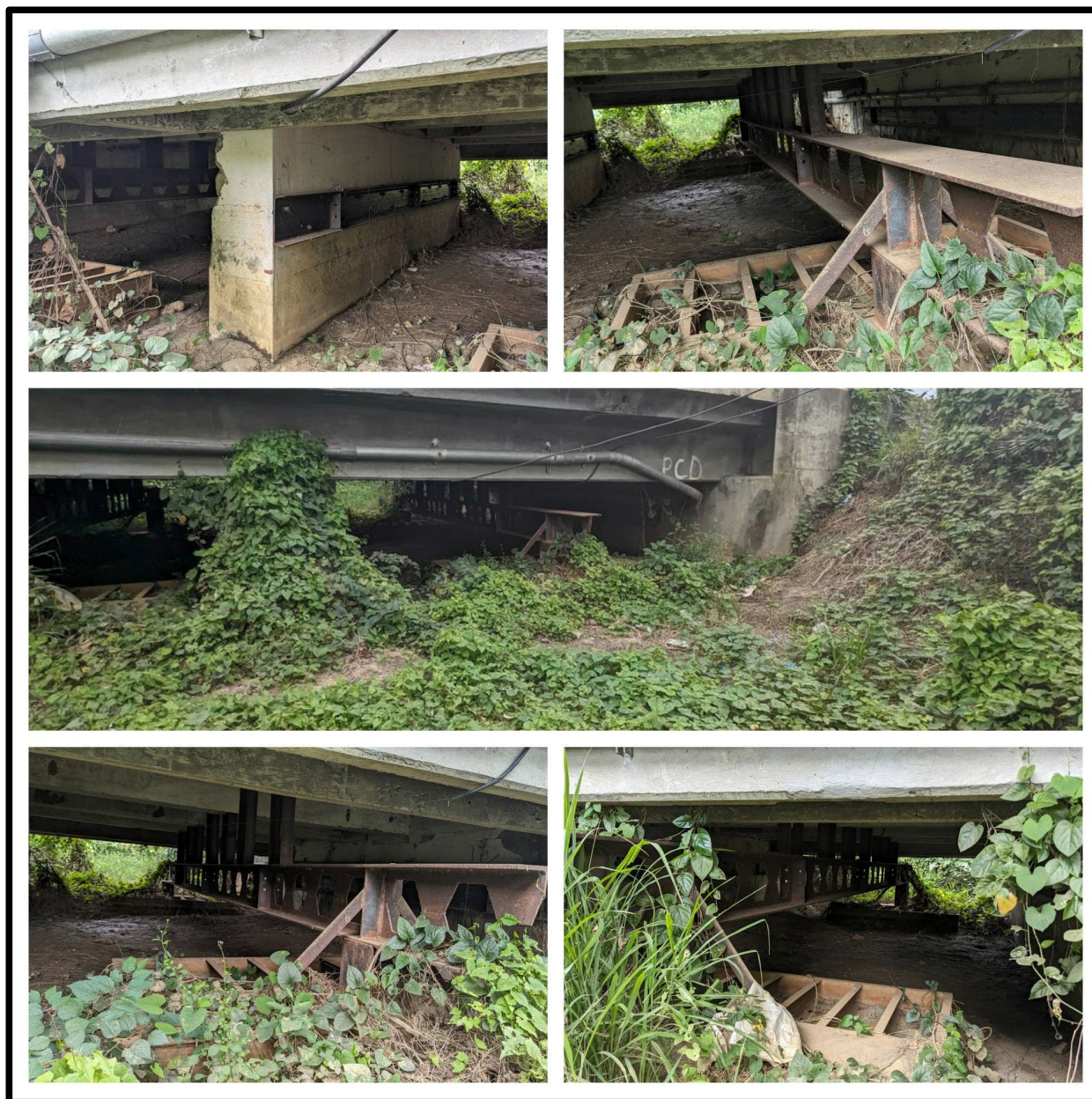
Figura 4.302: Estado del P-0303
