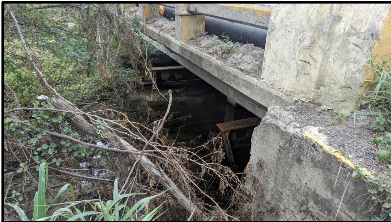
Figura 4.300: Estado del P-0302
