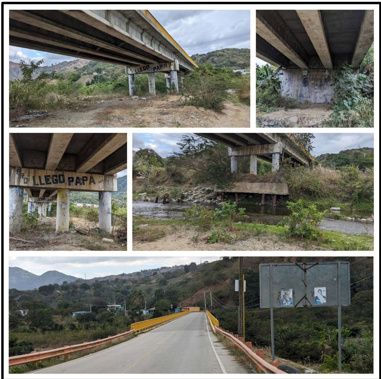
Figura 4.374: Estado del P-0747
