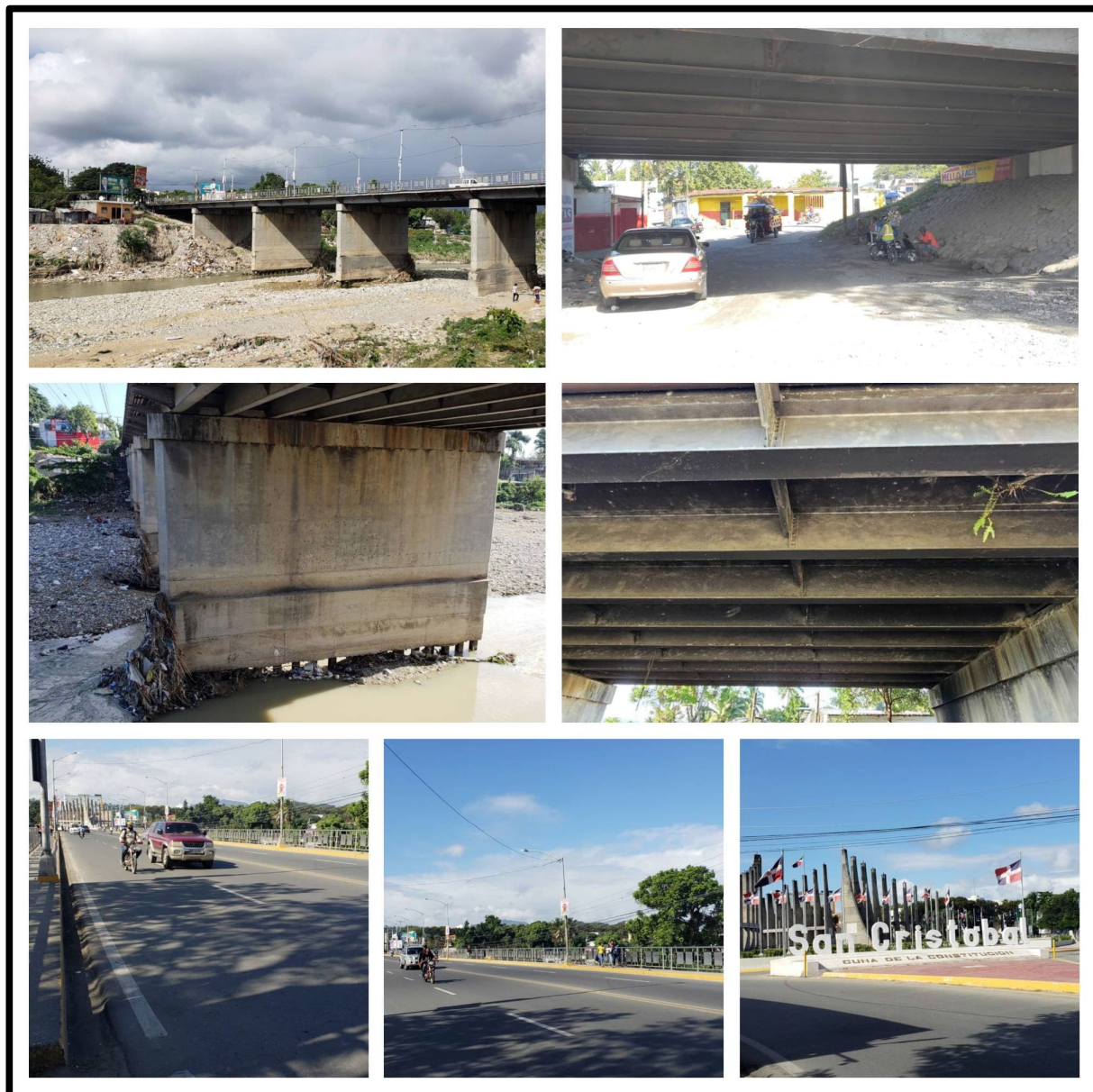
Figura 4.338: Estado del P-0058
