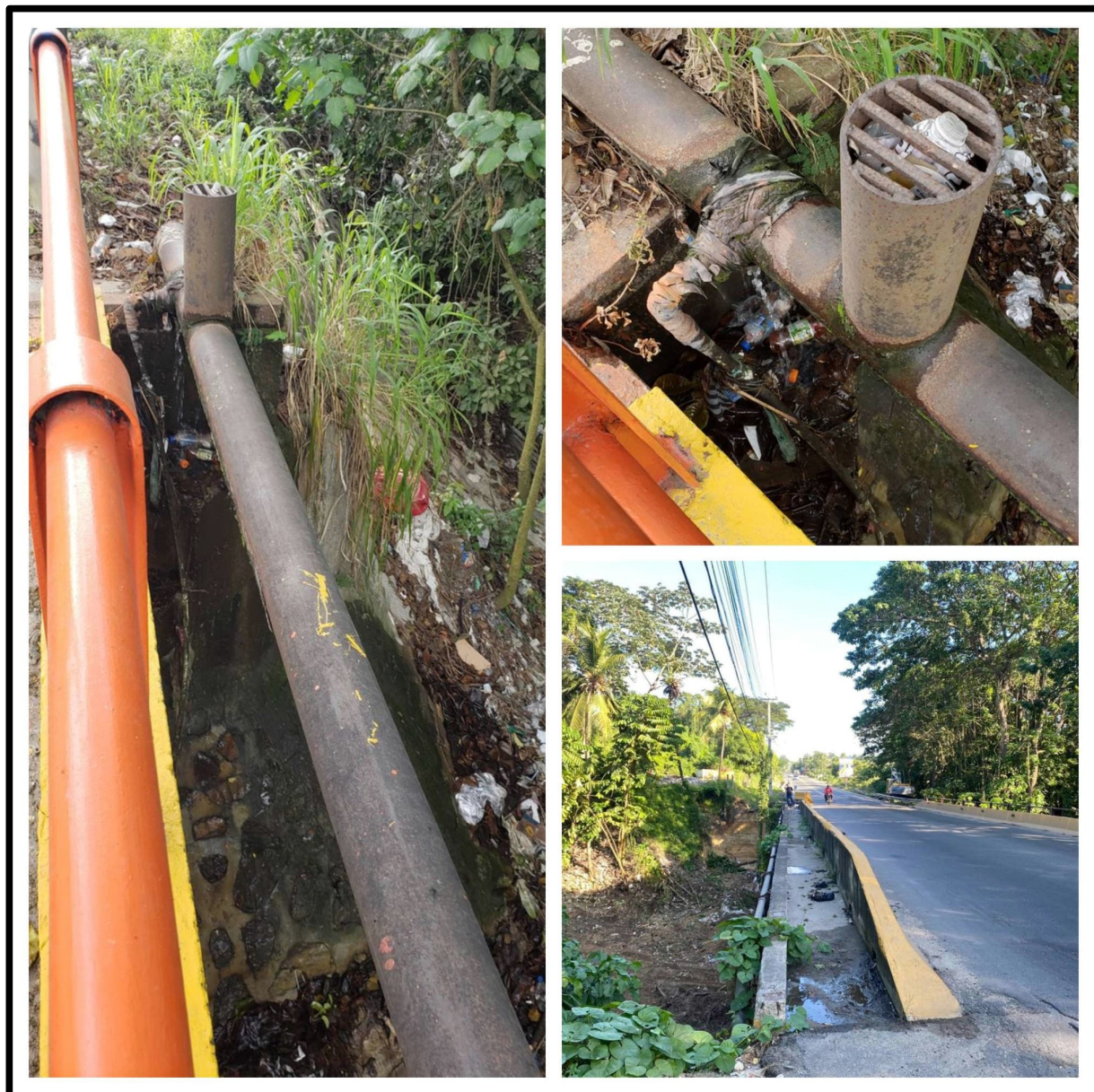
Figura 4.371: Interferencia con redes de servicios en el P-1116
