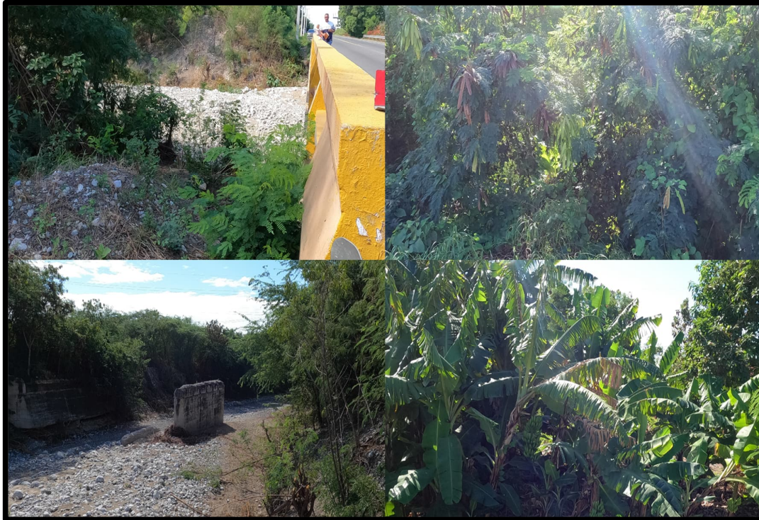
Figura 4.68: Relictos de vegetación del puente P-046.
