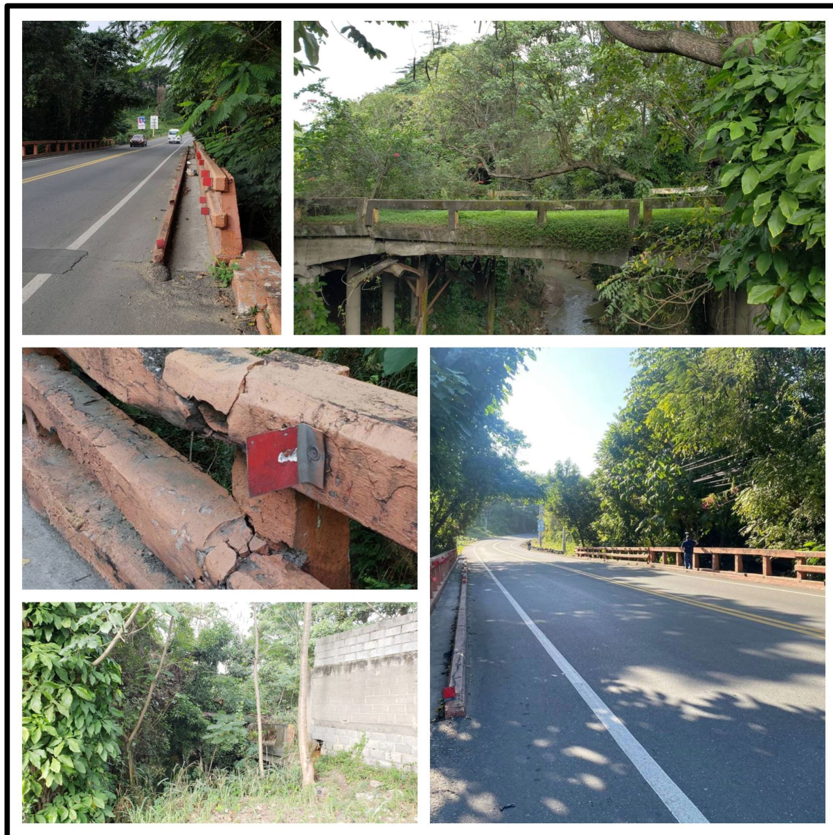
Figura 4.364: Estado del P-0898
