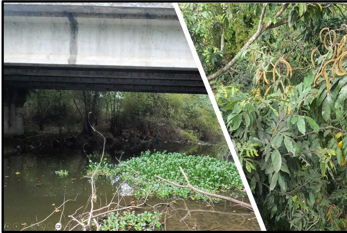
Figura 4.36: Estado de intervención, parte inferior del puente. Dominan buchón de agua y hierbas generalistas de áreas intervenidas.
