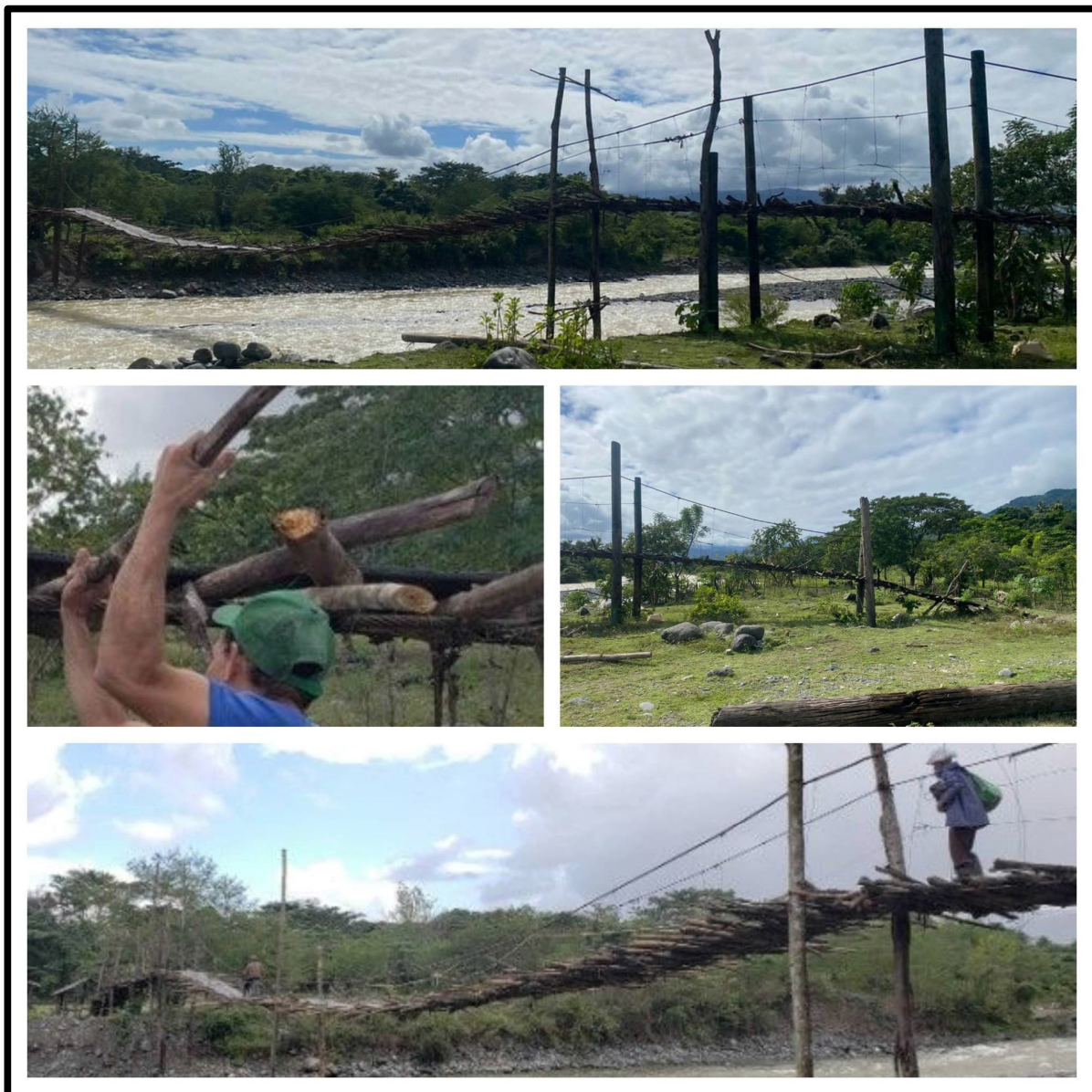
Figura 4.289: Estado del P-1152
