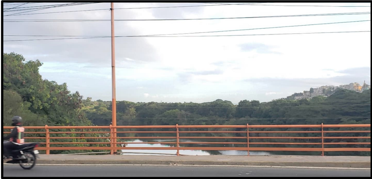
Figura 4.362: Tendido eléctrico aéreo en el P-0855
