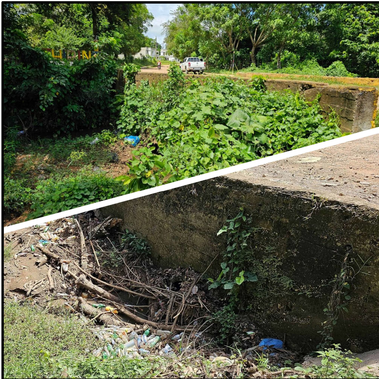
Figura 4.324: Entorno del con signos de degradación P-0951
