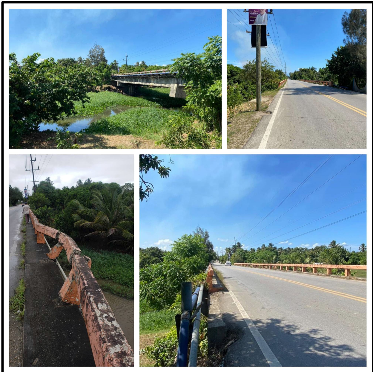
Figura 4.252: Estado del P-0047
