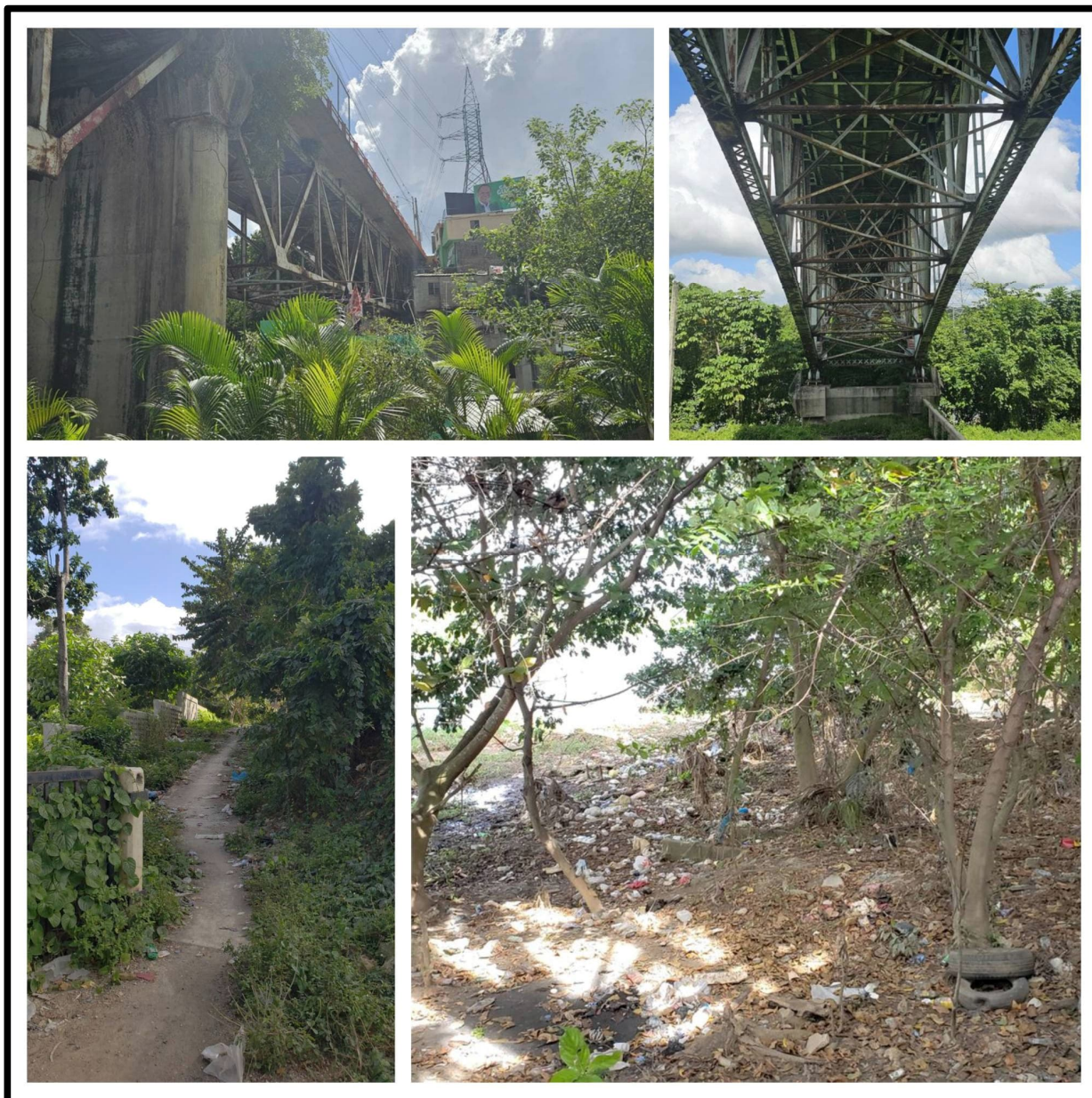
Figura 4.395: Estado del valle del Rio Ozama en el P-0070
