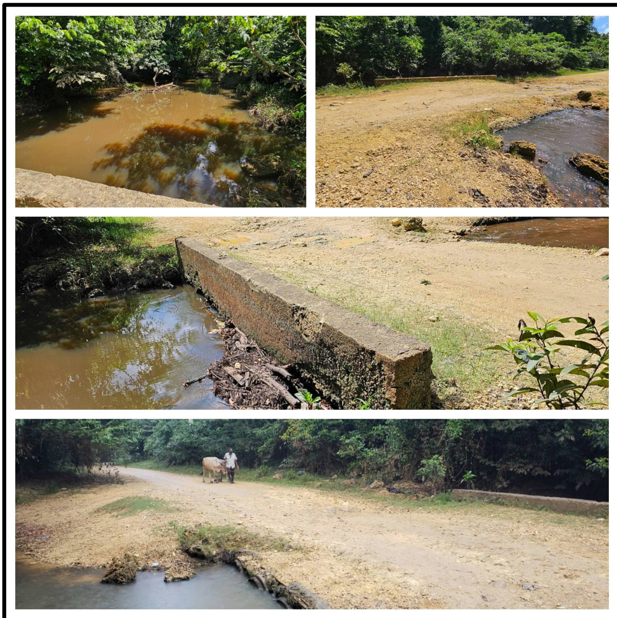
Figura 4.328: Estado del P-0952
