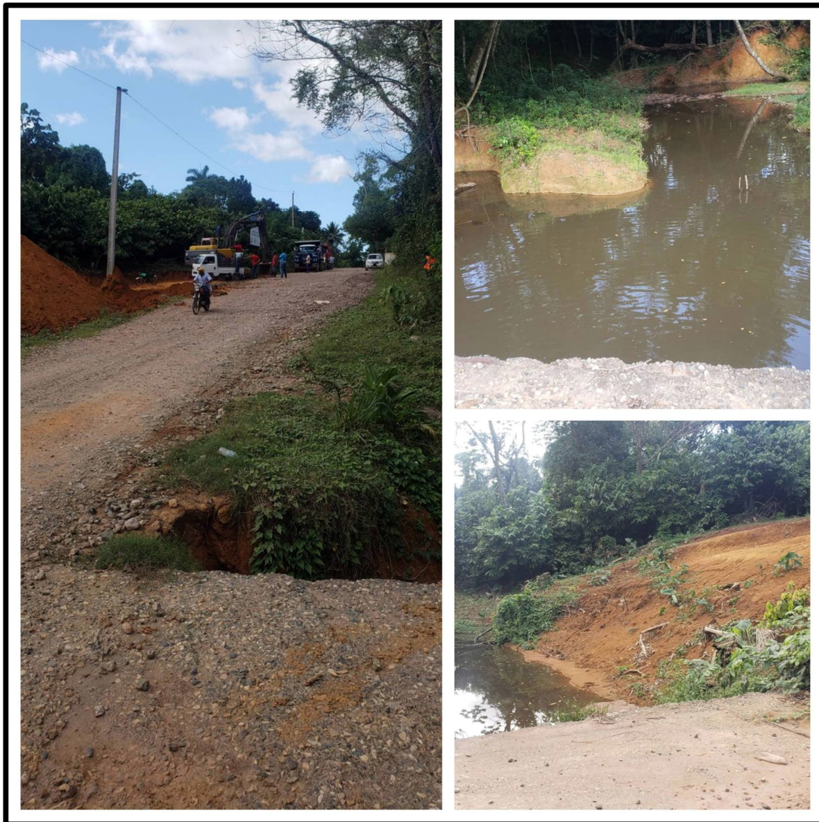
Figura 4.317: Estado del P-0191
