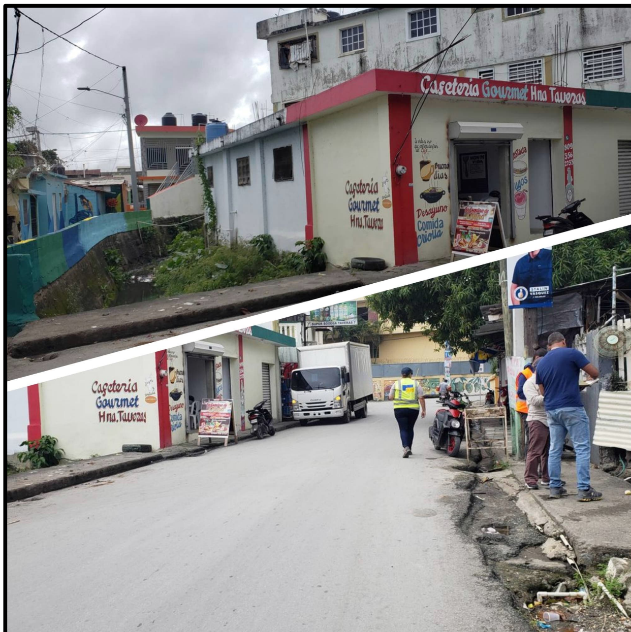
Figura 4.264: Estado del P-1067
