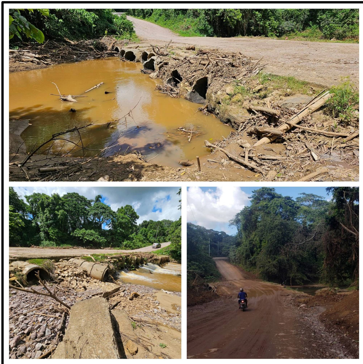
Figura 4.314: Estado del P-0190
