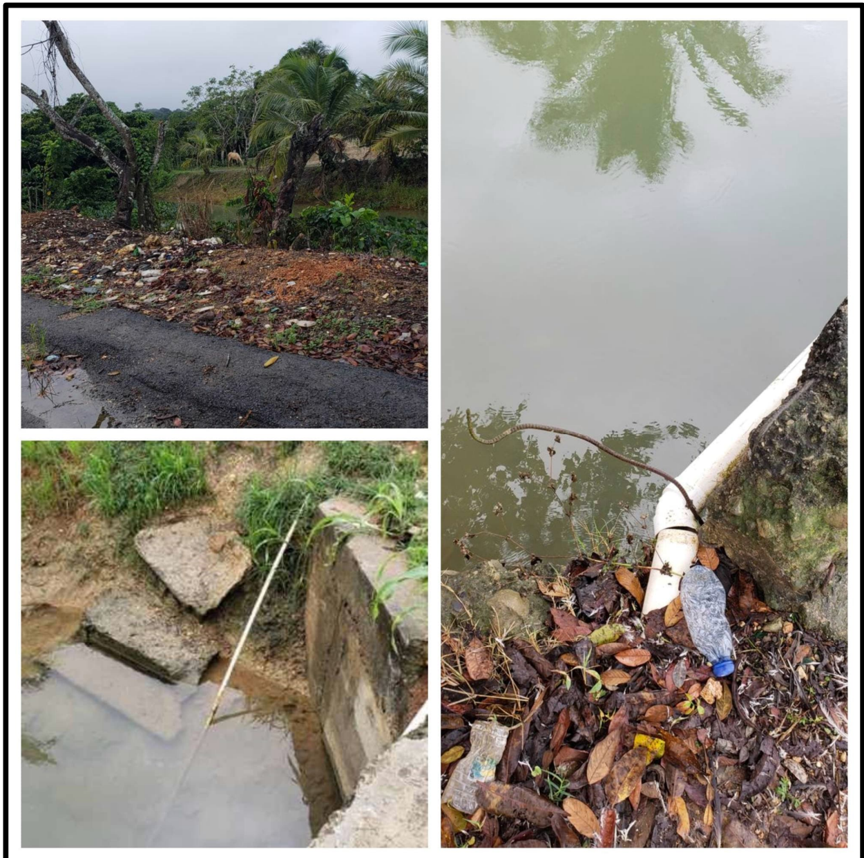
Figura 4.238: Signos de degradación e interferencia con redes de servicios en el P-0917
