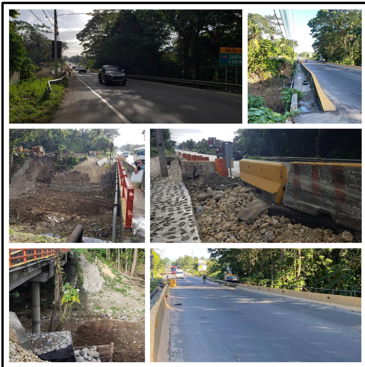
Figura 4.368: Estado del P-1116
