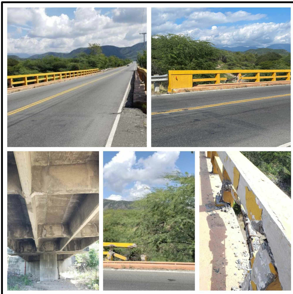
Figura 4.207: Registro fotográfico del estado del P-0008
