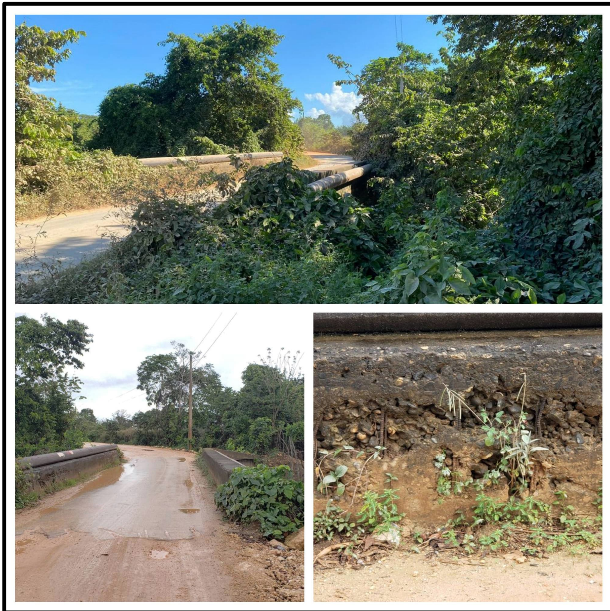
Figura 4.248: Estado del P-1006
