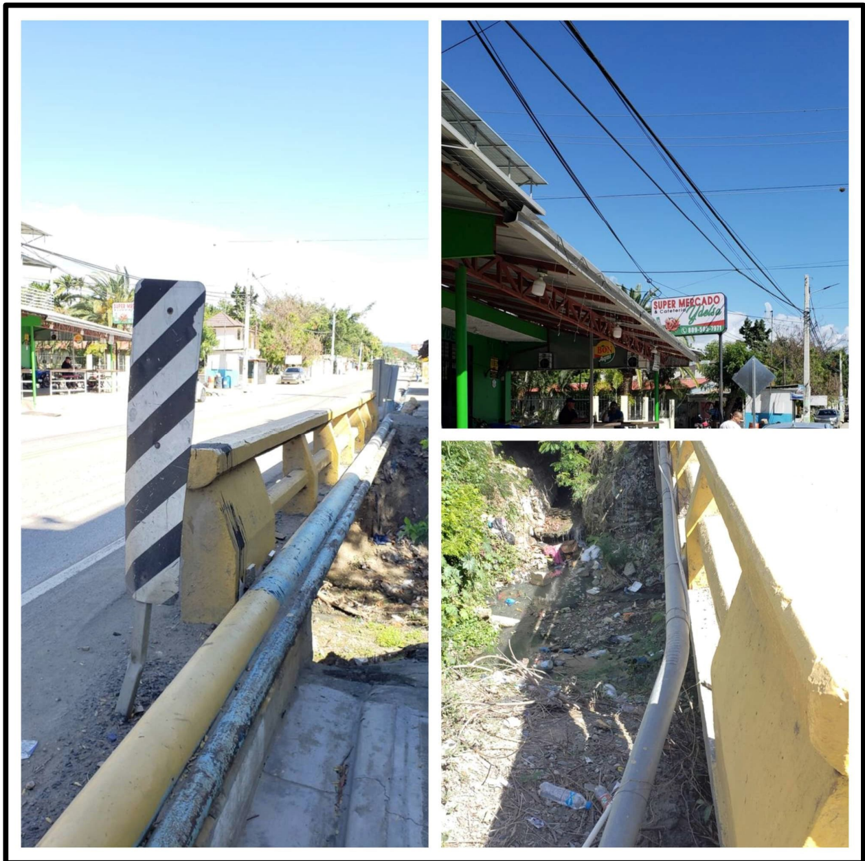
Figura 4.411: Interferencia con redes de servicios
