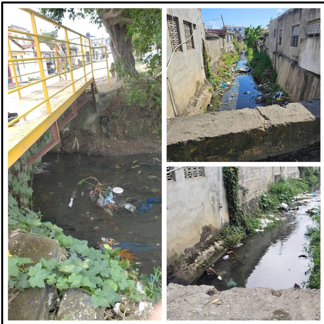
Figura 4.261: Signos de degradación en el entorno del P-1066
