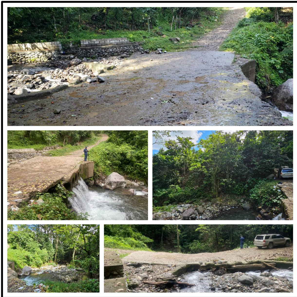
Figura 4.292: Estado del P-1153
