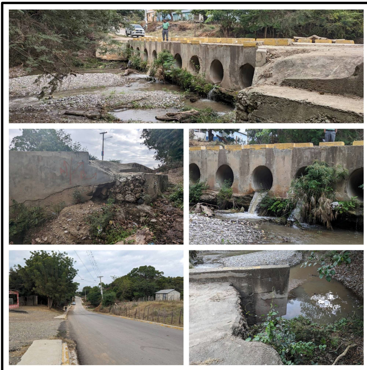
Figura 4.377: Estado del P-0830
