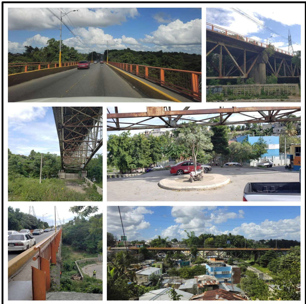
Figura 4.394: Estado del P-0070
