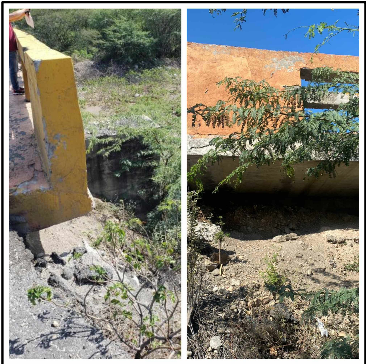
Figura 4.209: Signos de erosión en el P-0008
