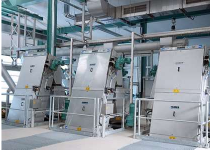
Imagen No. 10. Rejillas de barras mecanizada Fuente.: (Dieter Neder, 2024)
