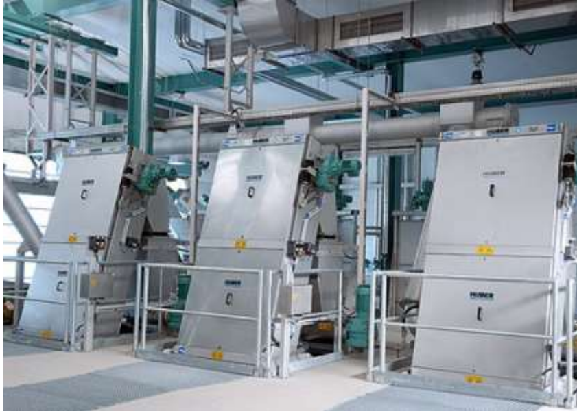
Figura 10 – Rejilla de barras mecanizada
