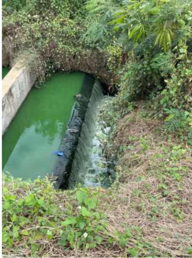
Imagen No. 33. Punto de salida de la PTAR antes de la descarga al océano
