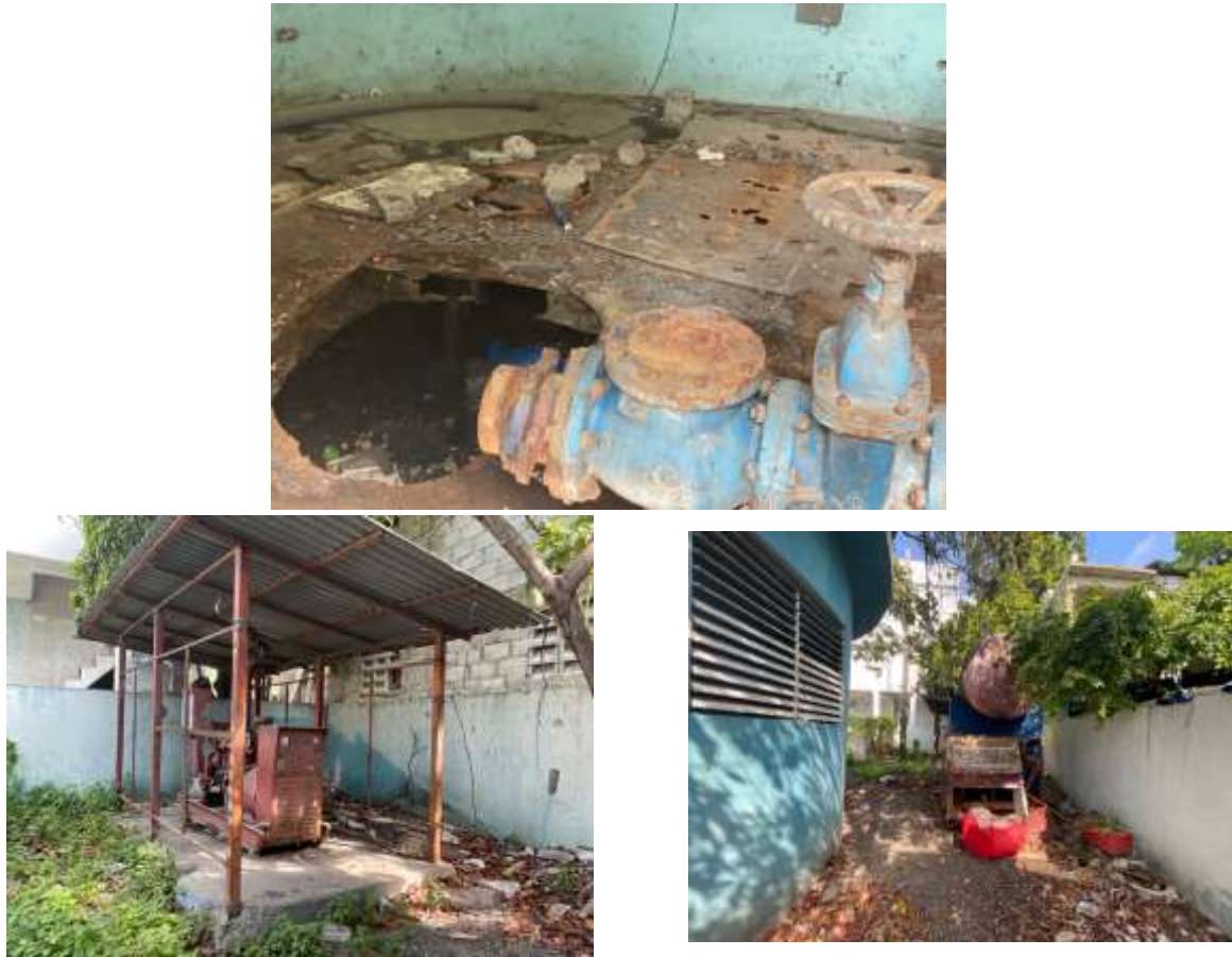
Imagen No. 39. Estación de bombeo No. 1
