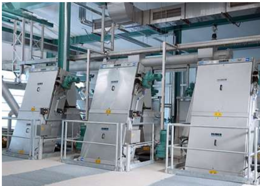
Figura 6 – Rejilla de barras mecanizada
