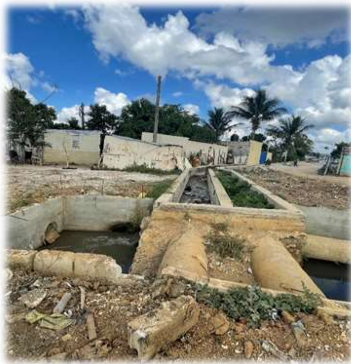
Imagen No. 29. Estado de la entrada de agua a la PTAR
