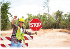
Colocación de operadores de tránsito manuales, los cuales indicarán el paso vehicular durante las actividades de construcción.
