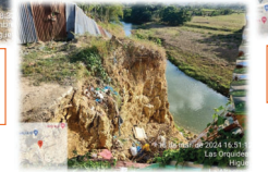
CM Francisco Richez (Lote 2) - Los tramos "CM Francisco Richez 006 al 010" fueron trasladados a la calle anterior, dado el deslizamiento de la calle inicialmente propuesta.
