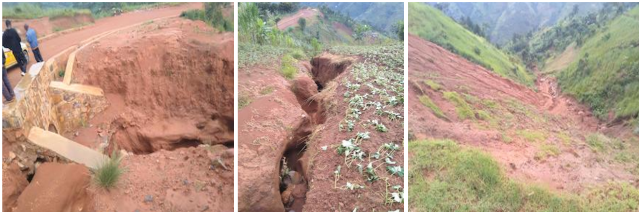
Planche 4: Ravinement et érosion d'un site de remblais en commune Buyengeru
