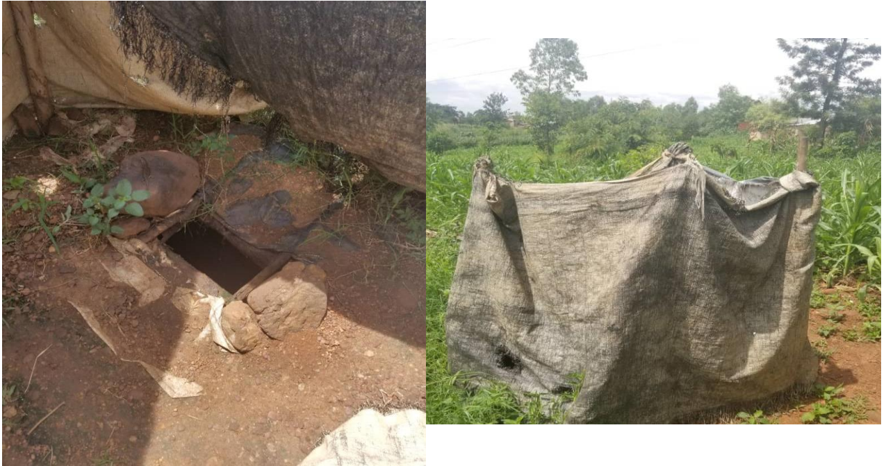
Photo 2: Latrine des Batwa en Commune Buganda, Province Cibitoke
