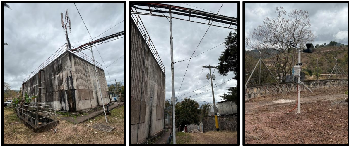
Figura 67 – Interferencias y estación meteorológica en predio de tanque La Travesía. Fuente: relevamiento (2026).
