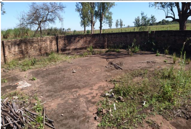
Fig. 75: Reservorio de agua, modelo tanque Australiano, de material. Luce abandonado por filtraciones constructivas.
