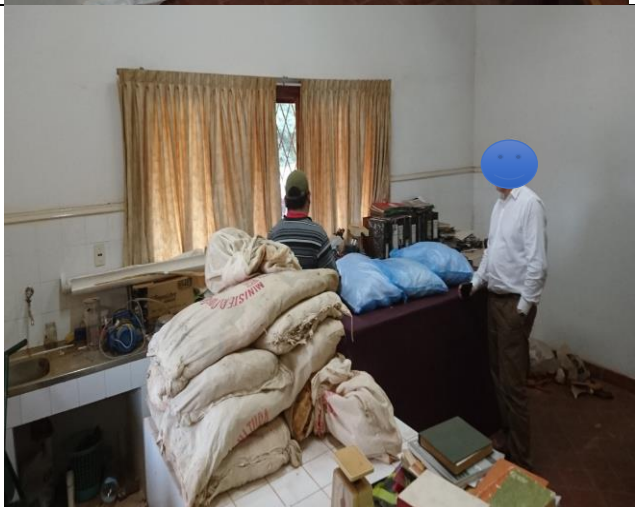
Fig. 18: Espacio de aprox 50 m 2 laboratorial en buenas condiciones edilicias. La instalación es subutilizada. Oficia de depósito. Inadecuado uso del mismo.
