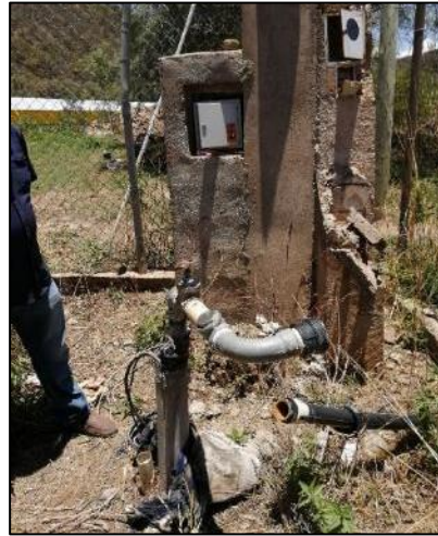
Bomba de agua sin funcionamiento.
