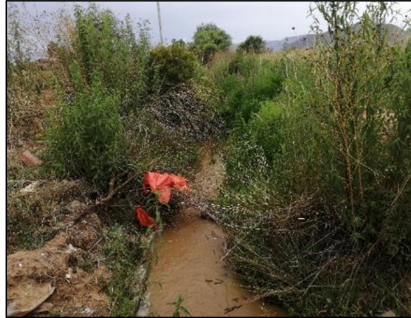
Canal de tierra, requerimiento de ampliación en revestimiento en Pajpani Chico
