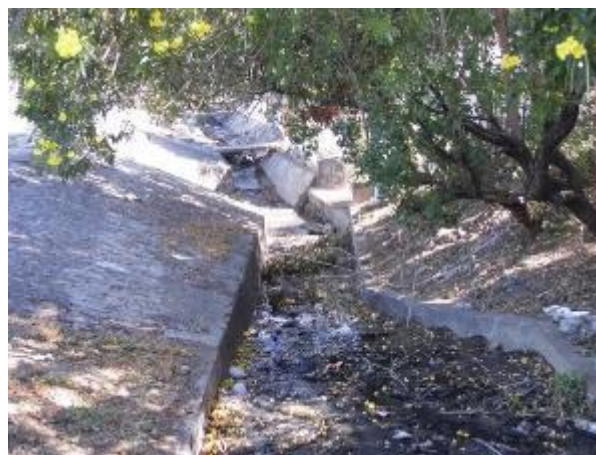
Foto 17 acumulación de residuos sólidos
