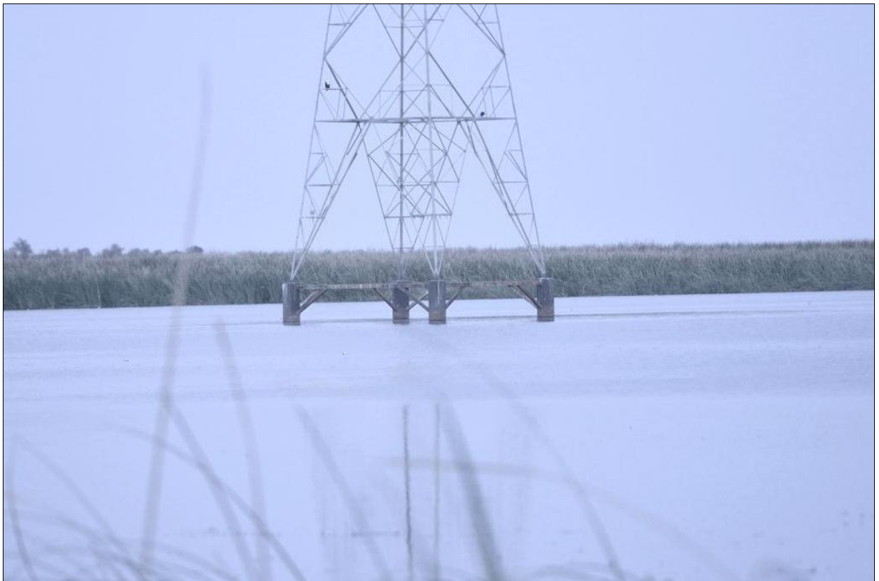
Photo 23 : Ligne OMVS – passage du lac de Guiers
