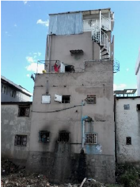
Photo 4: Exemple de bâti léger touché en bordure du canal C3
