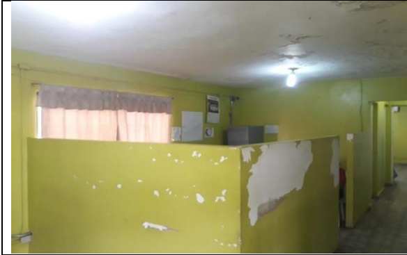
Foto 15: Vista general de las oficinas de la Asistente Administrativa y secretaria, en antesala de oficina de directores Administrativo y Operaciones. Se observa deterioro de pintura.
