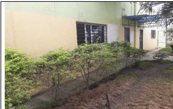
Foto 16: Vista lateral del Edificio Administrativo. Se observa ventanas y puertas de entrada a Comedor. Al final del pasillo se observa puerta al parqueo de empleados fuera de operaciones.
