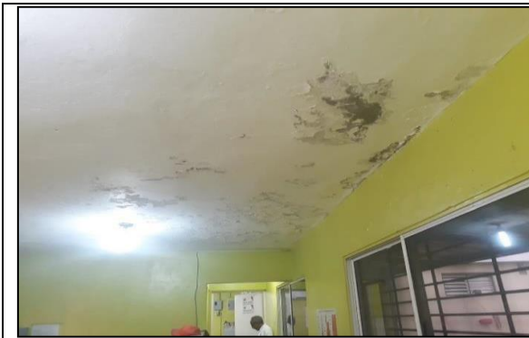
Foto 13: Vista cercana del techo del área de oficinas asistente administrativa y secretaria, afectado por filtraciones.
