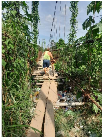
Fotografía 3. Condición del puente sobre el Canal Maya en la Colonia Reyes Caballero, utilizado como paso peatonal
