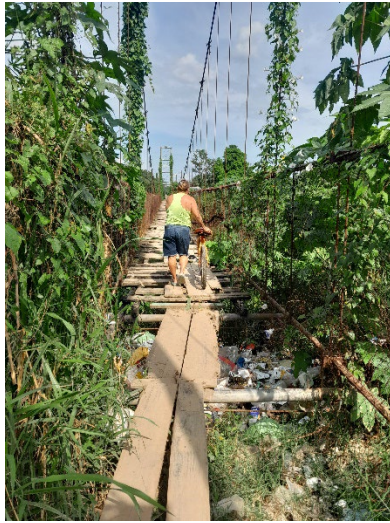
Fotografía 3. Condición del puente sobre el Canal Maya en la Colonia Reyes Caballero, utilizado como paso peatonal
