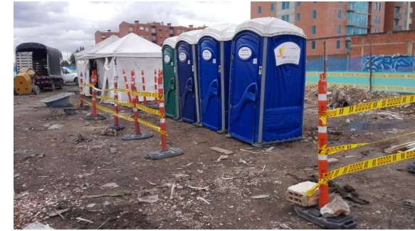
Unidades sanitarias para uso de trabajadores
