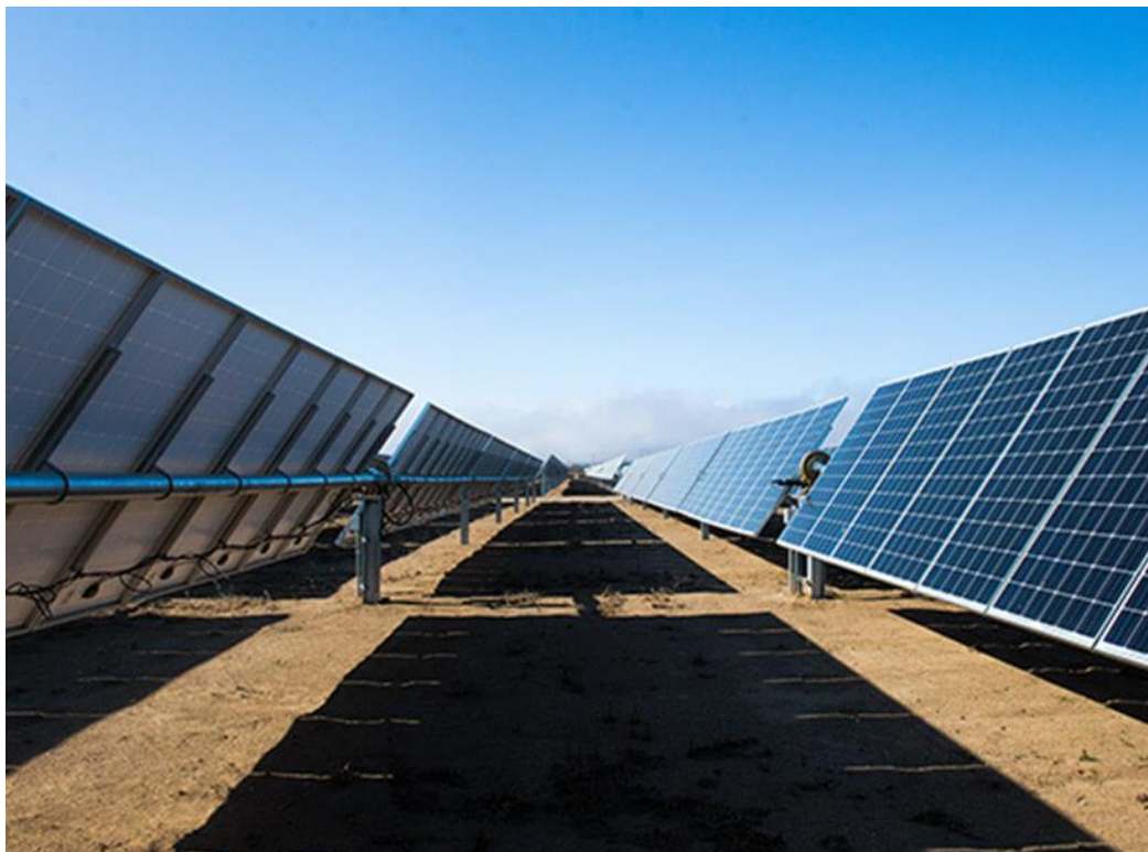
Ilustración 5 - Seguidor 1V Nextracker
