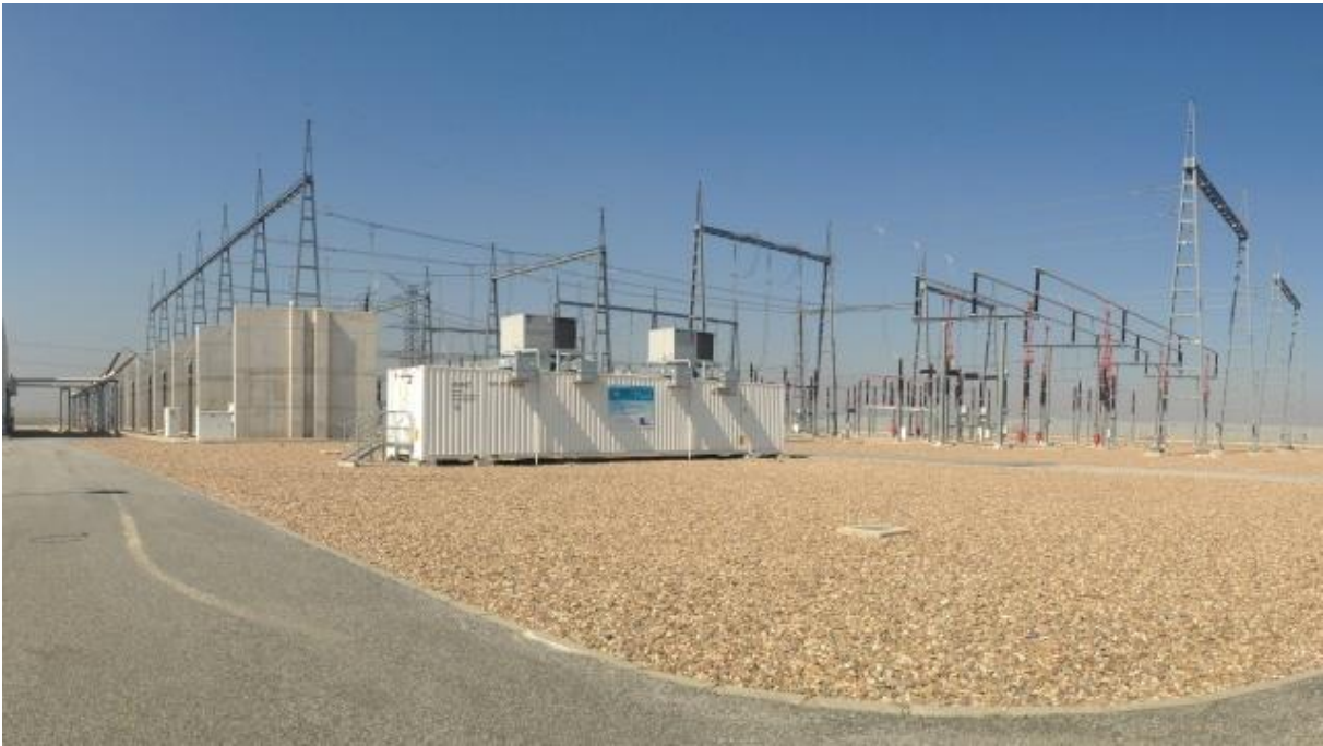
Ilustración 2 – Vista de la SE Carmona REE
