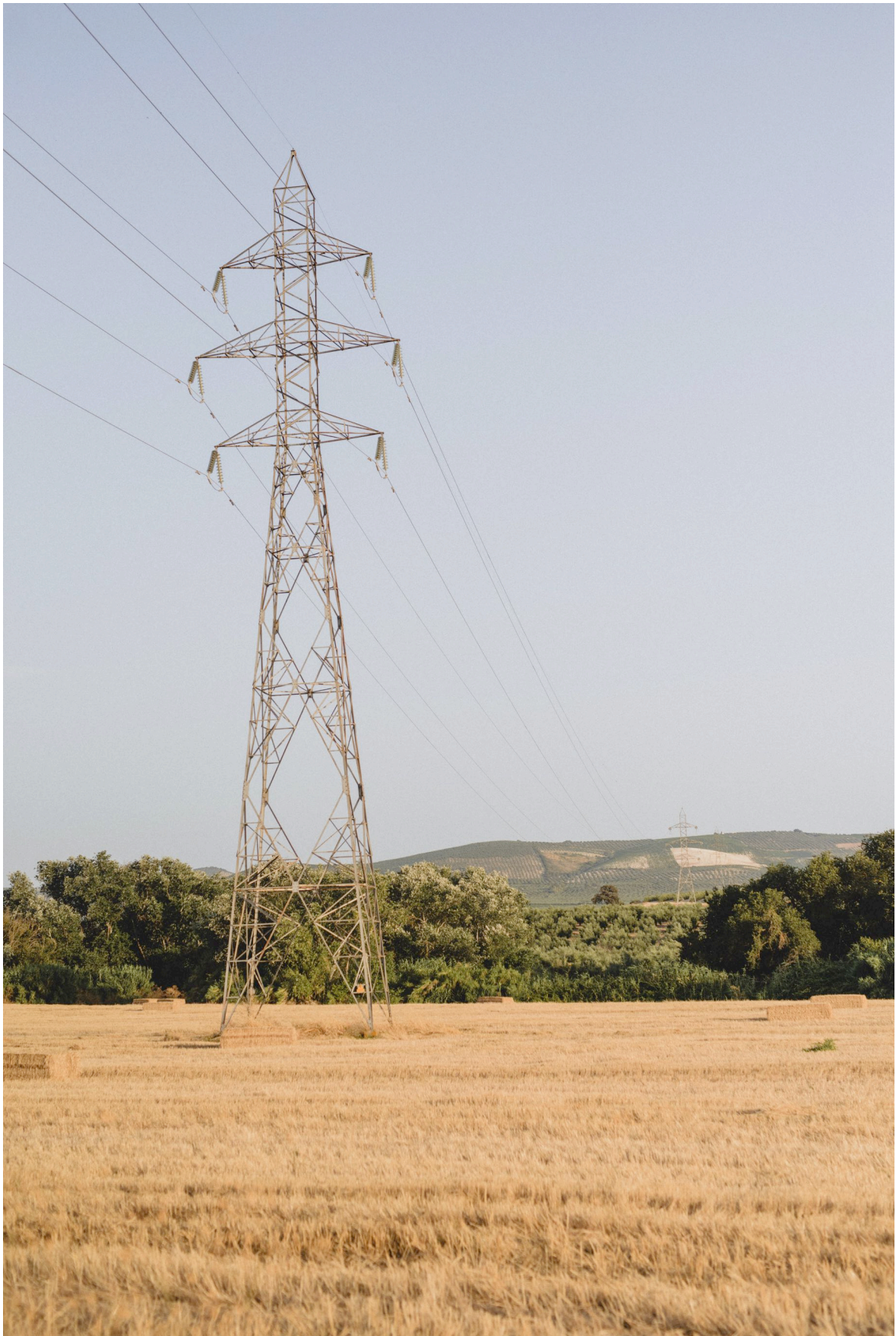
Foto 43 Detalle de apoyo de la línea de 132 kV "Espejo-Lucena" la altura del paraje El Alcaide.
