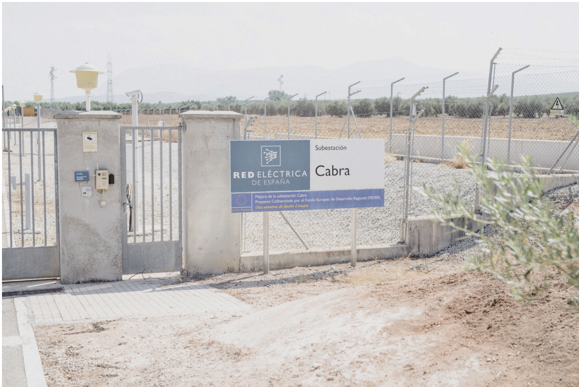
Foto 57. Detalle de la entrada de la Subestación Cabra REE 400 kV.
