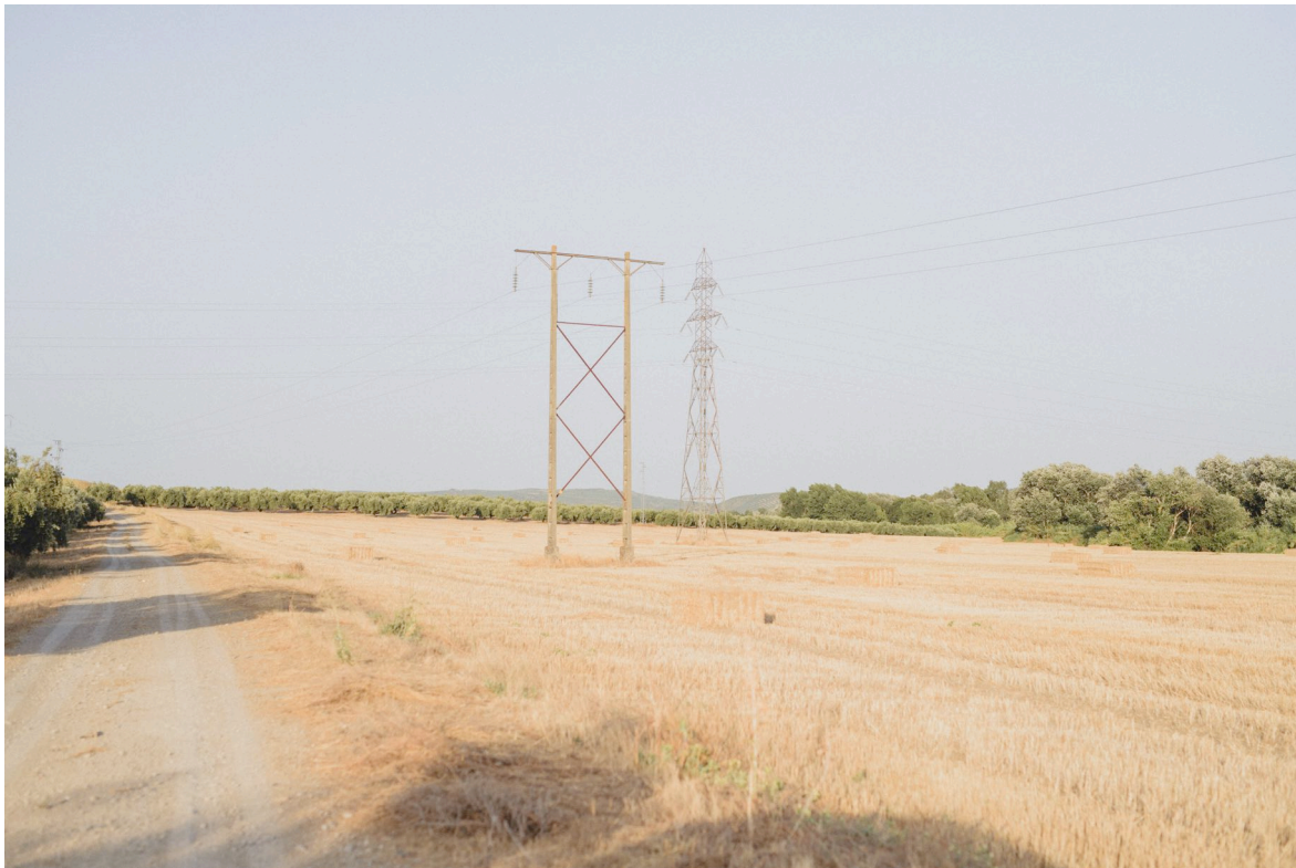
Foto 41. Apoyo de hormigón de una línea de media y al fondo apoyo de la línea de 132 kV "Espejo-Lucena".
