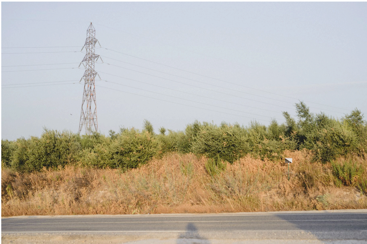
Foto 45. Línea de 132 kV "Espejo-Lucena" en su cruce con la carretera A-3130.
