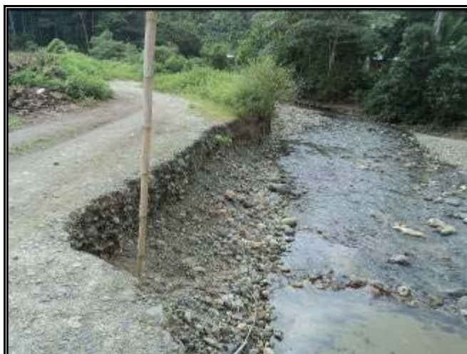
Fotografía 6.1.3.1-10 Una de las riberas del río Piedra de Afilar, donde han ocurrido socavamientos
