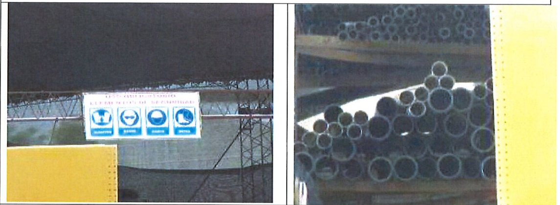
Vista de señalización de seguridad y del acopio de caños en el obrador.
