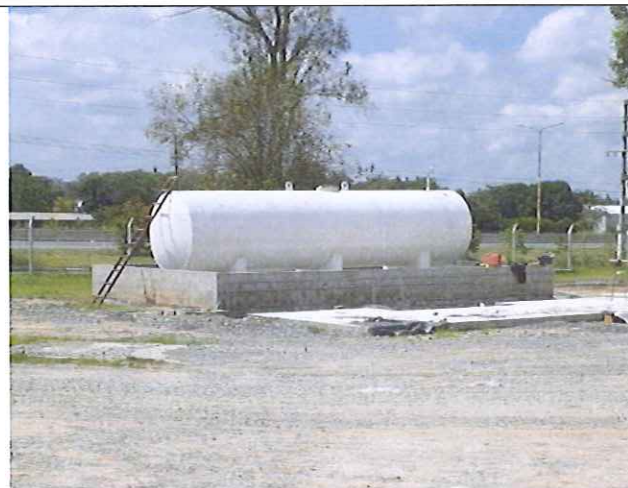
Tanques de combustible. Se puede apreciar la apropiada realización del muro anti derrame. A la fecha de la visita el mismo aún no estaba operable.
