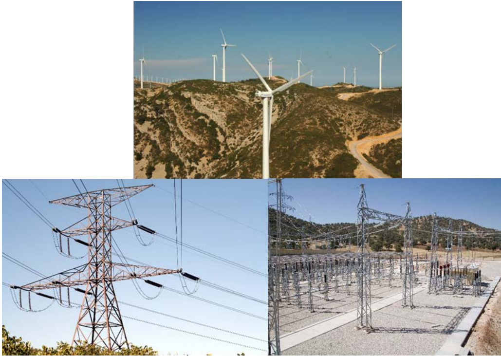
Şekil 1: Rüzgar türbinleri, enerji hatları ve şalt sahası örneklerinin fotoğrafları
