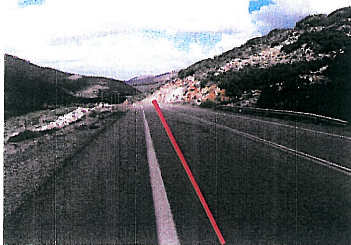
Φ25: ΠΕΡΙΟΧΗ ΔΙΕΛΕΥΣΗΣ ΧΑΡΑΞΗΣ ΕΠΙ ΤΗΣ ΥΦΙΣΤΑΜΕΝΗΣ ΟΔΟΥ ΠΕΡΙ ΤΩΝ Χ.Θ. 9+500 ΚΑΙ Χ.Θ. 9+700
