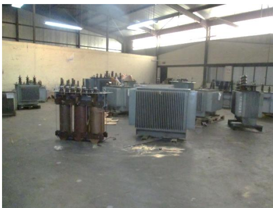
FIGURE 4 : STOCKAGE DES TRANSFORMATEURS EN ATTENTE DE REPARATION OU AU REBUT A ANALAMAHITSY
