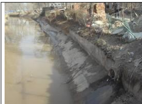
沟渠直排污水现象
