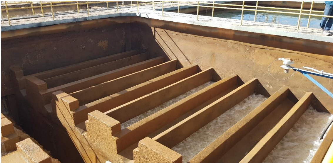
Foto 3 – Processo de Lavagem dos Filtros em Andamento (injeção de Ar)
