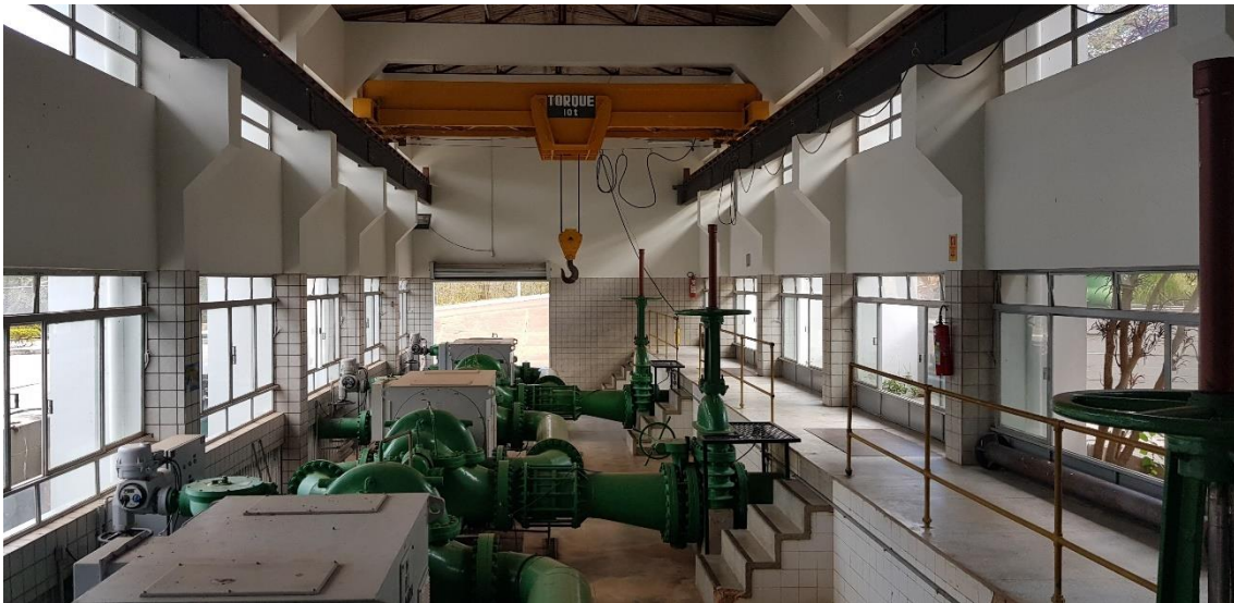
Foto 13 – Conjunto 2 - Estrutura de Recalque – Sistema Torto/Santa Maria
