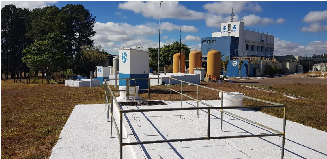
Foto 5 – Final das Adutoras do Sistema Descoberto e Chegada na ETA
