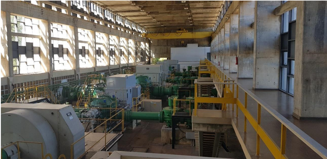
Foto 9 – Estrutura de Recalque – Sistema Descoberto
