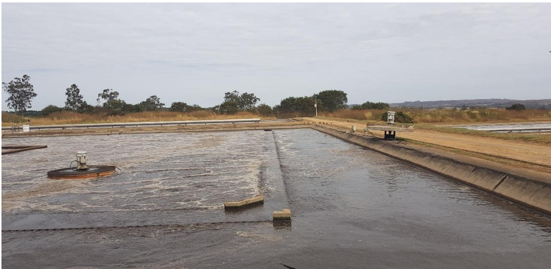
Foto 28 – Unitanque em Funcionamento na ETE Melchior
