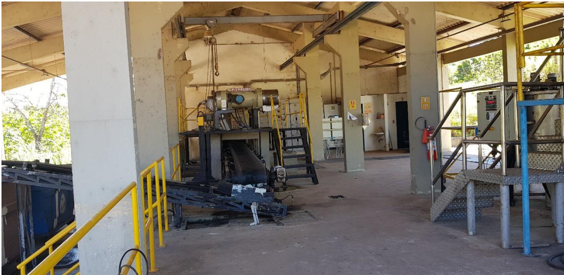
Foto 43 – Centrifugas em Funcionamento – ETE Riacho Fundo
