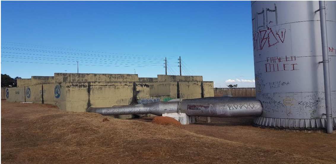
Foto 7 – Dispositivo de Atenuação Adutoras Água Bruta do Sistema Descoberto
