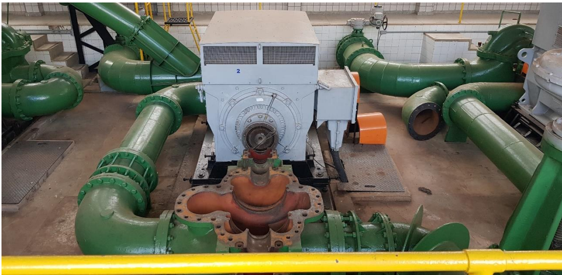
Foto 12 – Bomba em Manutenção – Sistema Torto/Santa Maria
