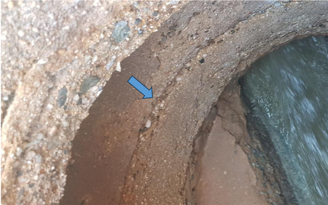
Foto 50 – Detalhe de marcas de enfraquecimento no concreto por ações dos gases do esgoto – Trecho 1 – Recanto das Emas
