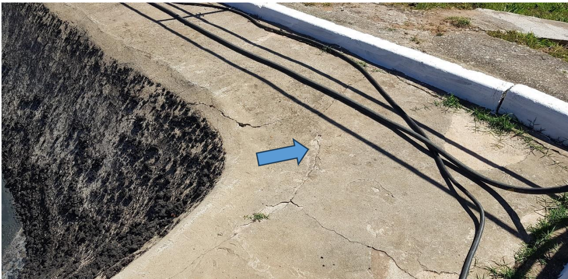
Foto 41 – Trincas Identificada em uma das Bacia de Tratamento – ETE Riacho Fundo
