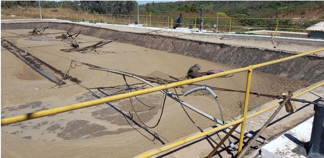
Foto 40 – Tanque de Tratamento (Batelada) – ETE Riacho Fundo
