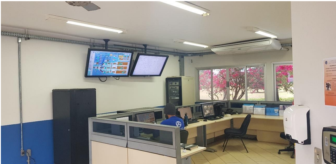
Foto 23 – Centro automatizado de Controle da ETE Samambaia
