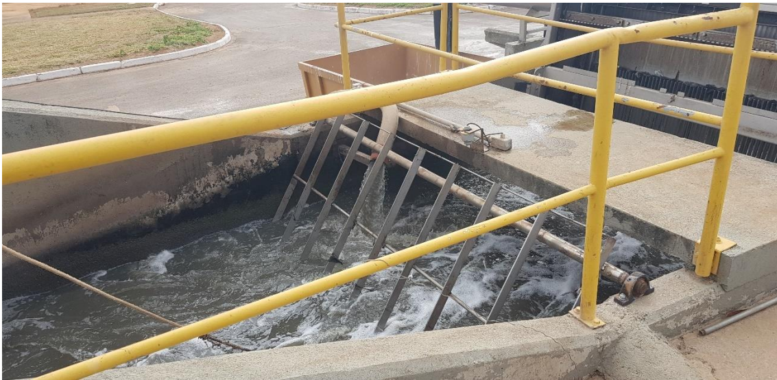
Foto 25 – Chegada do Emissário na ETE Melchior – Grade Grossa, pré-tratamento.
