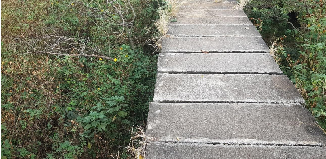
Foto 60 – Tampas de Concreto sobre a Travessia, o Concreto sofre um ataque químico pelos gases do esgoto e tende a desagregar
