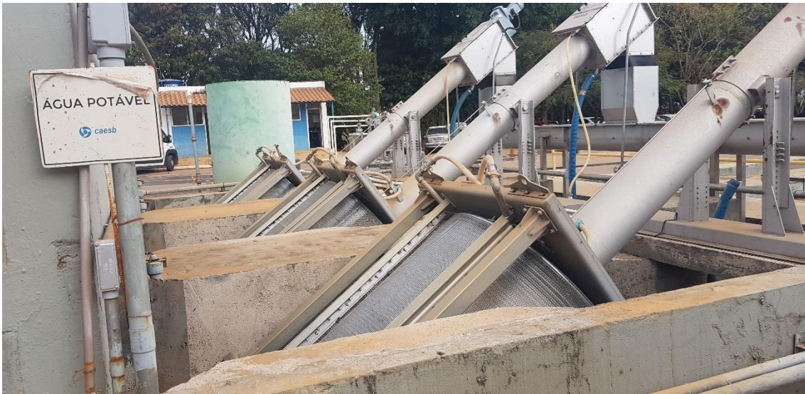
Foto 21 – Filtros Rotativos na ETE Samambaia
