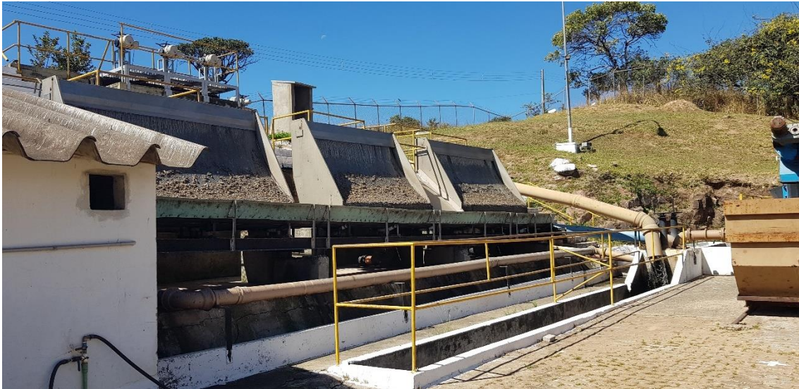
Foto 38 – Peneiras Fixas na Entrada da ETE Riacho Fundo
