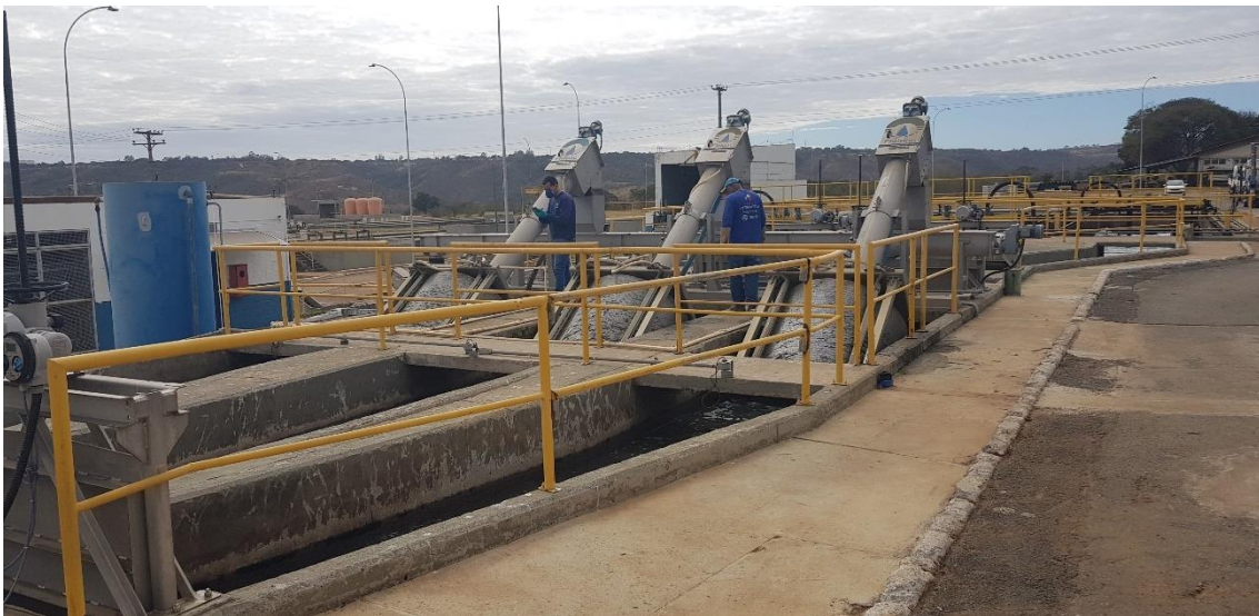
Foto 26 - Filtros Rotativos na ETE Melchior
