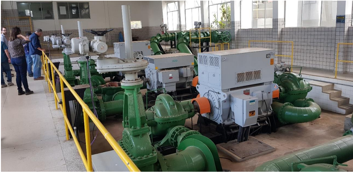
Foto 11 – Conjunto 1 - Estrutura de Recalque – Sistema Torto/Santa Maria
