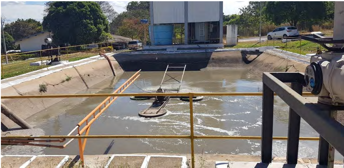
Foto 39 – Bacia de Mistura e Equalização – ETE Riacho Fundo
