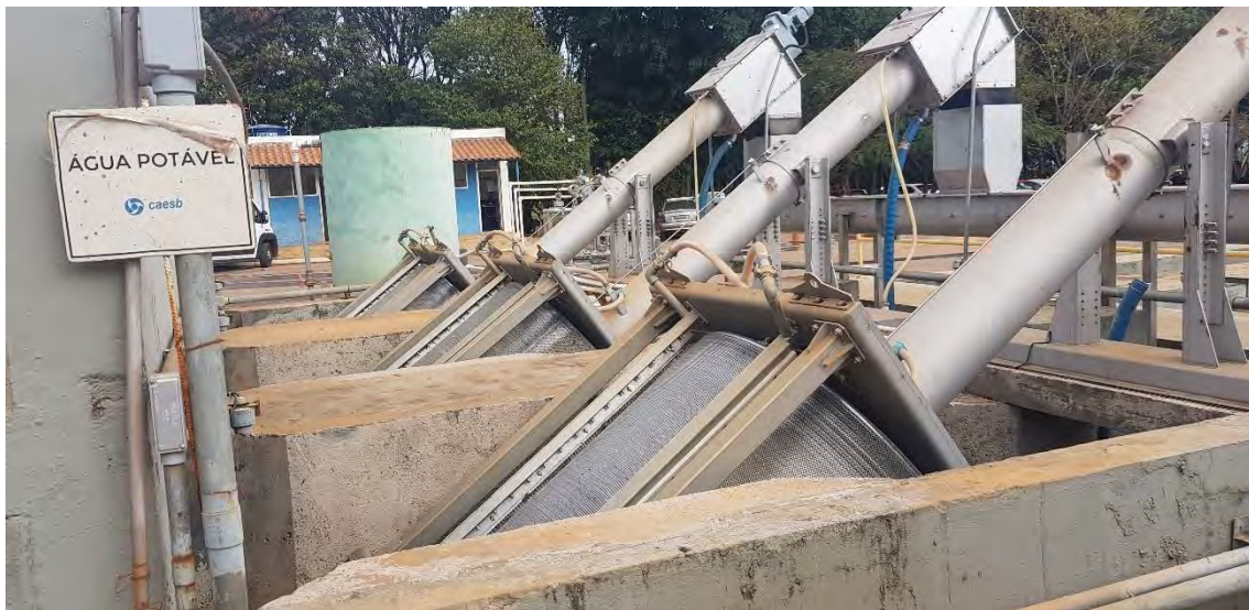
Foto 21 – Filtros Rotativos na ETE Samambaia
