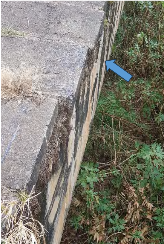
Foto 58 – Manchas Laterais de extravasamento de Esgoto in natura
