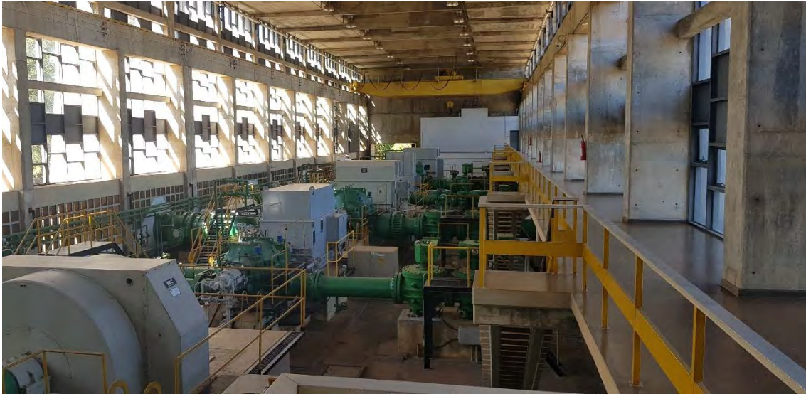
Foto 9 – Estrutura de Recalque – Sistema Descoberto
