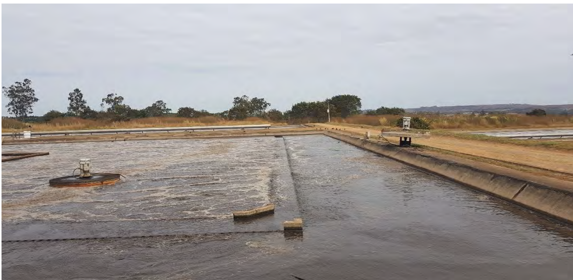
Foto 28 – Unitanque em Funcionamento na ETE Melchior
