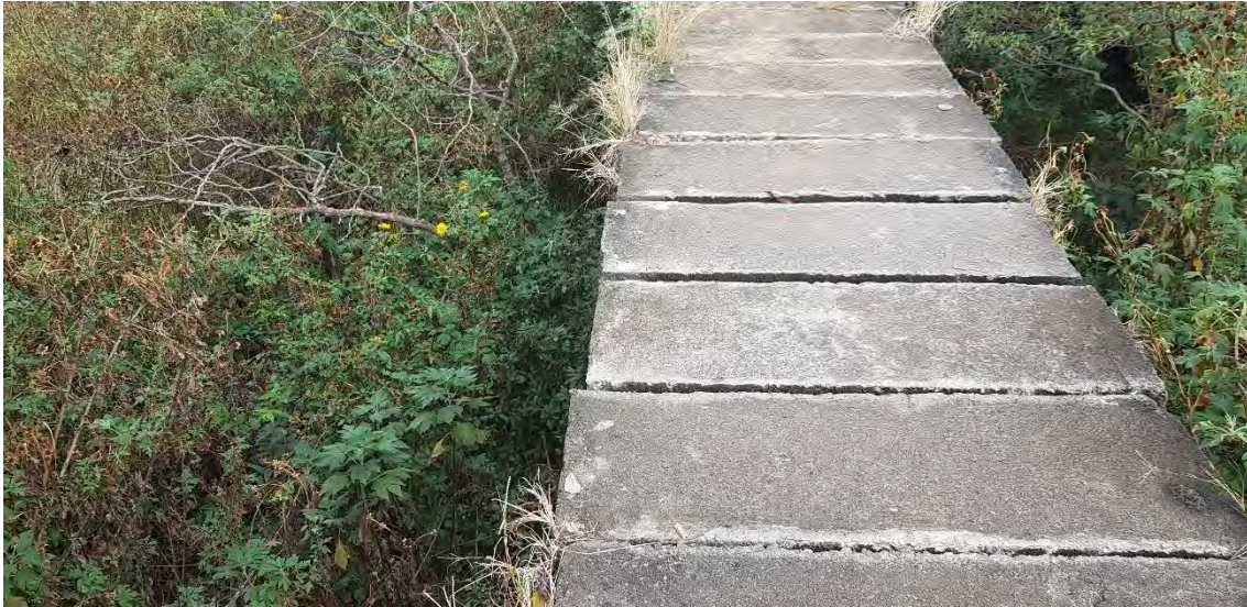
Foto 60 – Tampas de Concreto sobre a Travessia, o Concreto sofre um ataque químico pelos gases do esgoto e tende a desagregar
