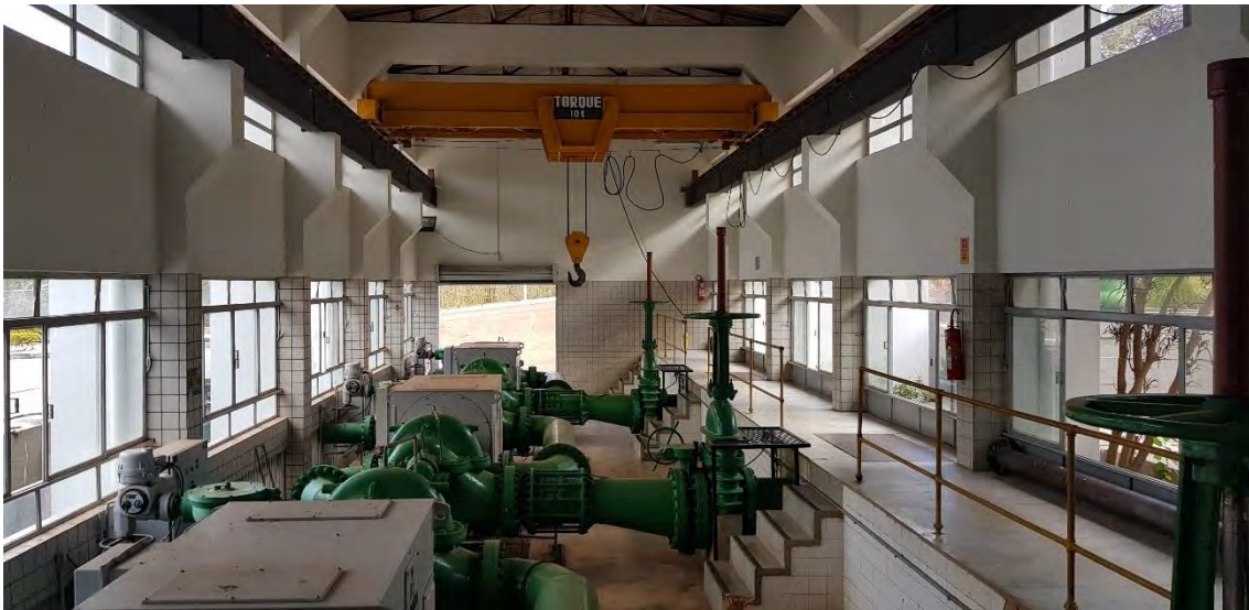
Foto 13 – Conjunto 2 - Estrutura de Recalque – Sistema Torto/Santa Maria
