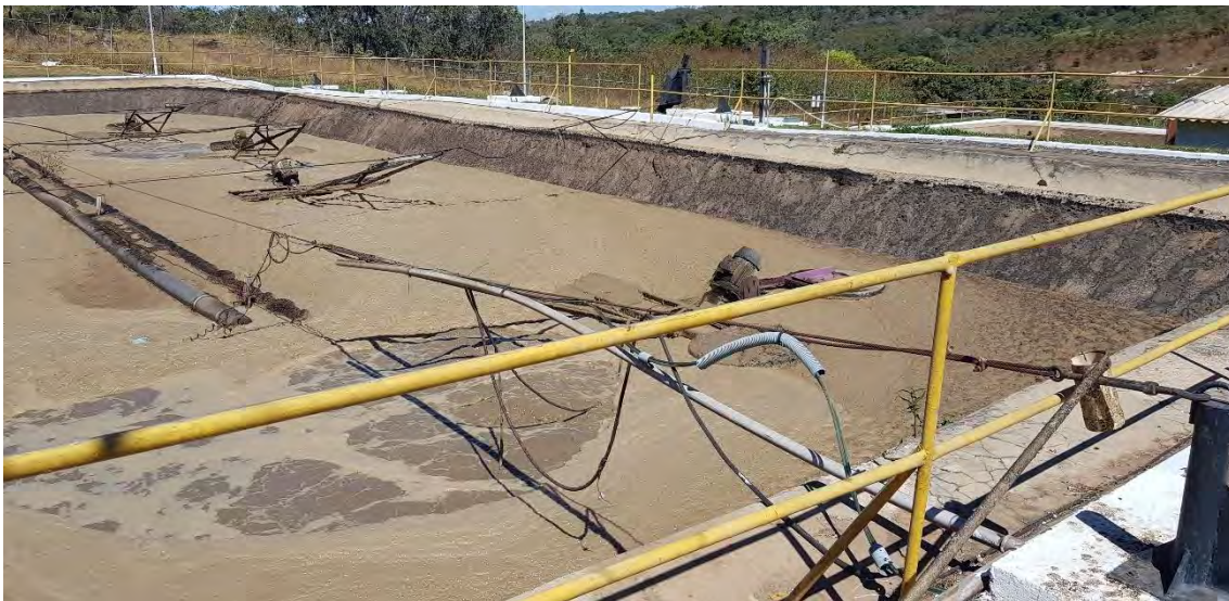
Foto 40 – Tanque de Tratamento (Batelada) – ETE Riacho Fundo
