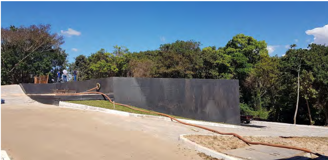
Foto 44 – Tanque de Equalização da Saída de Efluente – Em fase de testes de Estanqueidade
