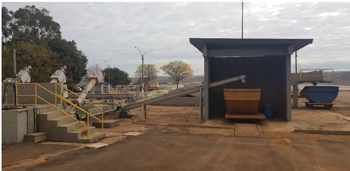
Foto 22 – Remoção de Material fino/Grosseiro do Esgoto (este material é enviado ao aterro sanitário de Brasília)
