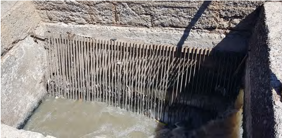
Foto 37 – Chegada do Emissário na ETE Riacho Fundo
