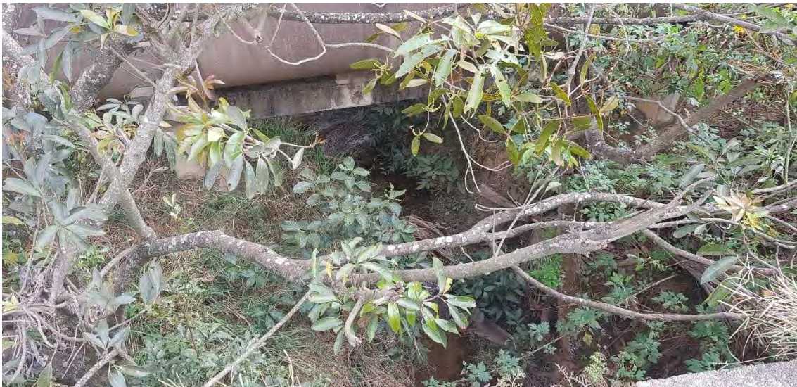
Foto 59 – Rio Gatumé, que recebe esgoto in natura , quando existe extravasamento na travessia
