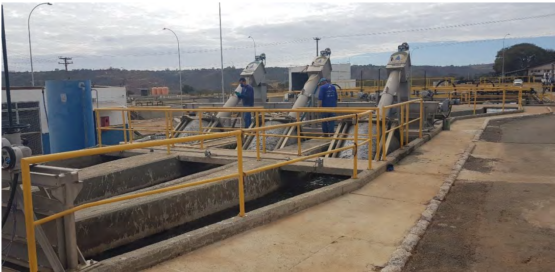
Foto 26 - Filtros Rotativos na ETE Melchior
