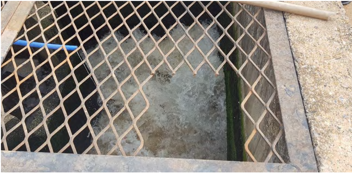
Foto 33 – Saída do Efluente da ETE e encaminhamento ao Emissário para lançamento no Rio Melchior
