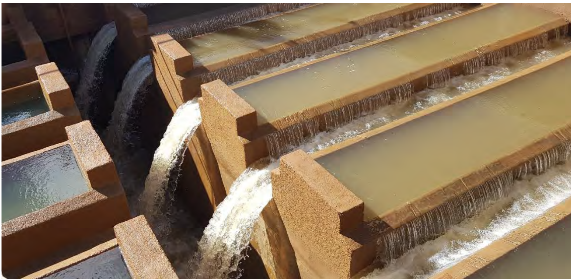
Foto 4 – Processo de Lavagem dos Filtros (Injeção de Água para retirada de partículas)
