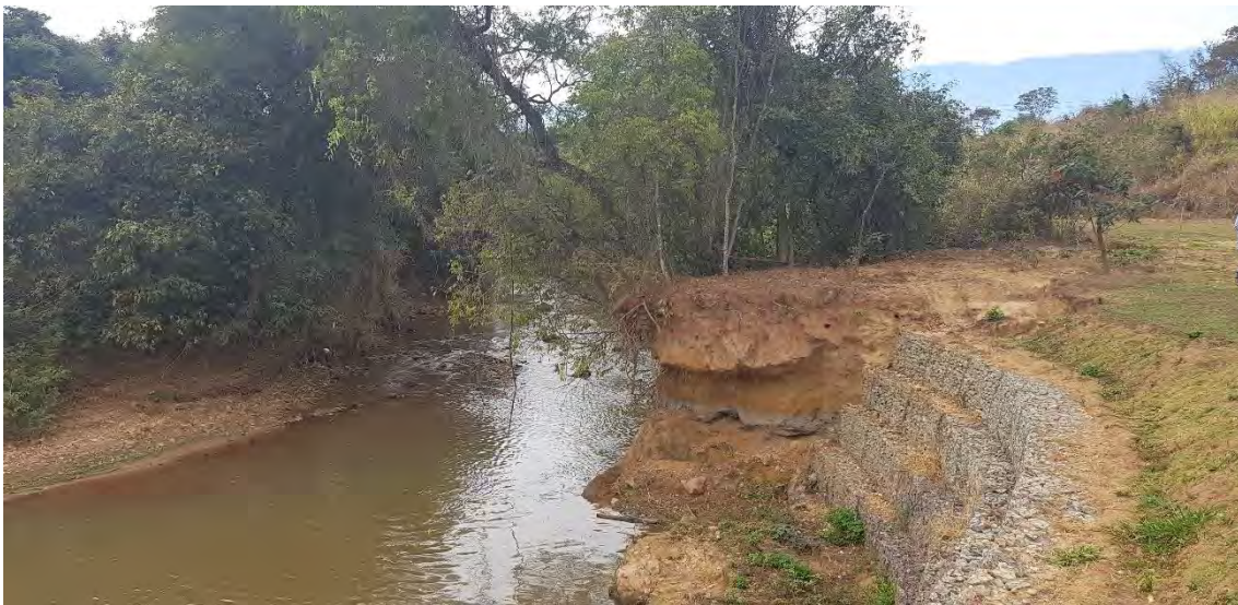
Foto 36 – Vista do rio Melchior a montante do ponto de Lançamento de Efluente, observar proteção de Gabião em margens instáveis.
