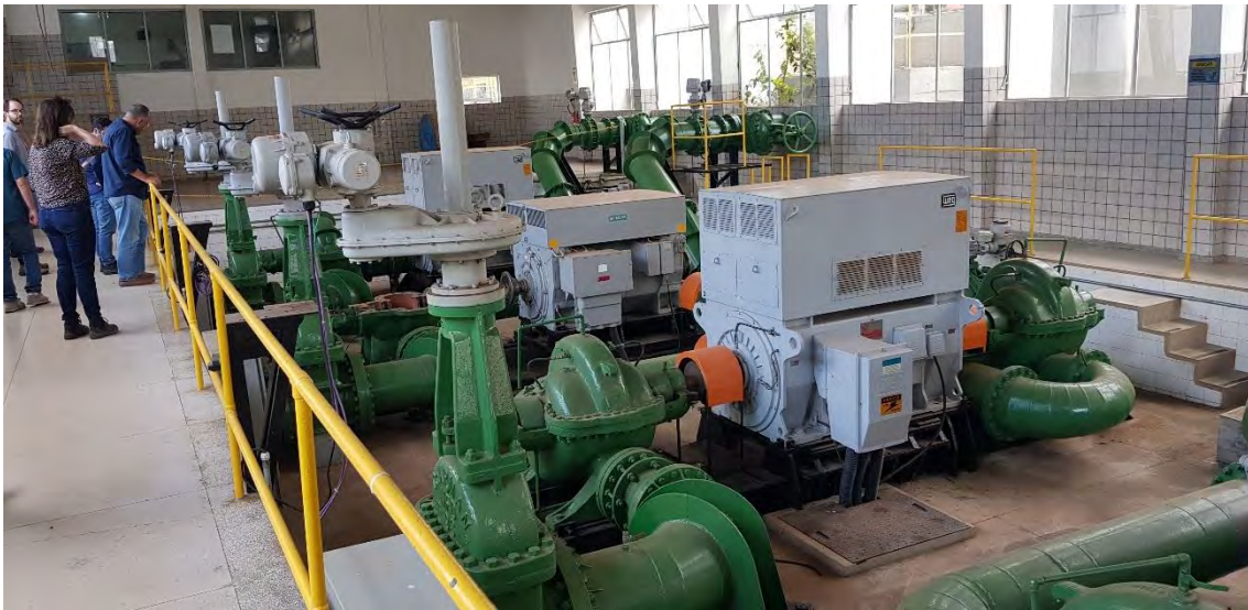
Foto 11 – Conjunto 1 - Estrutura de Recalque – Sistema Torto/Santa Maria
