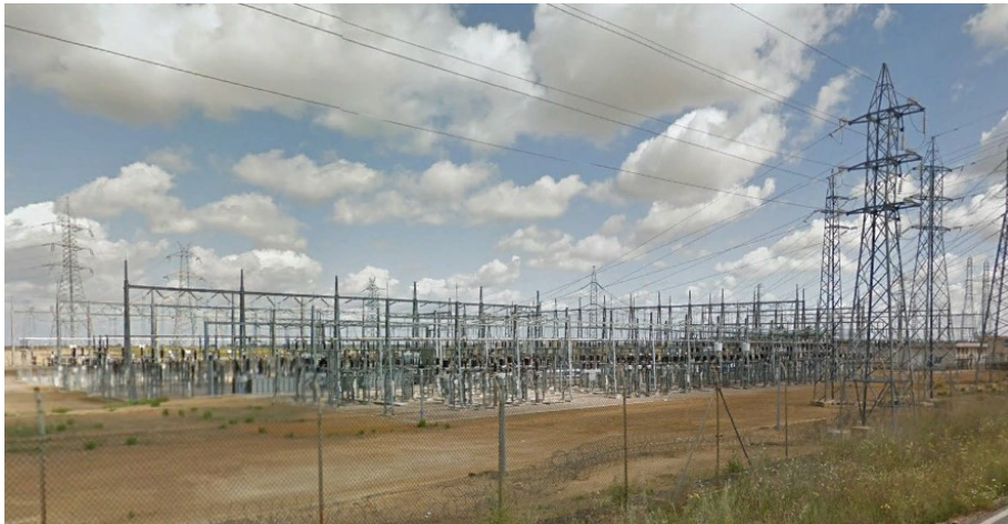
Figura 2: Área de estudio. Subestación Don Rodrigo (fuente: Google Earth)
