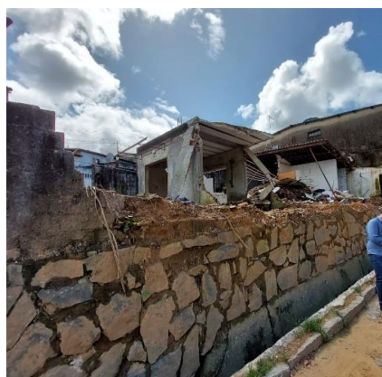
Foto 7 – Moradias impactadas pelo deslizamento de terra ocorrido na margem oposta às unidades
