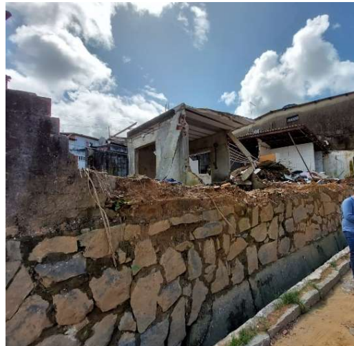
Foto 7 – Moradias impactadas pelo deslizamento de terra ocorrido na margem oposta às unidades
