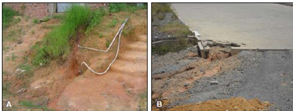
Figura 86 – Erosão superficial registrada na Rua Monte Alegre, Bairro de Jenipapo e no bairro do Jordão (B), Recife – PE.
