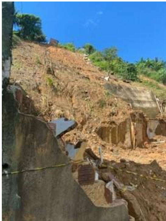
Estado de taludes colapsados después del período de lluvias en mayo 2022
