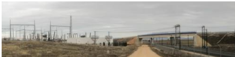
Figura 7.31 Subestación Tábara y vía AVE
